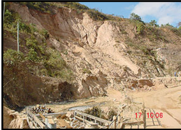
Foto 1 - Talude com instabilidade geral com escorregamentos e movimentação de massa, apresentando erosões generalizadas.
