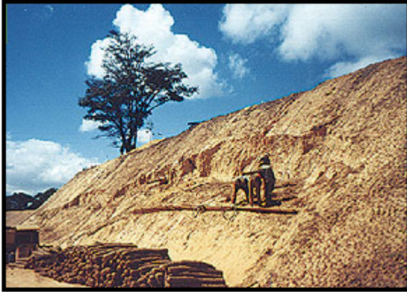
Foto 7 - Talude onde houve a ruptura, deslizamento e será recuperado e protegido com a técnica do solo grampeado
