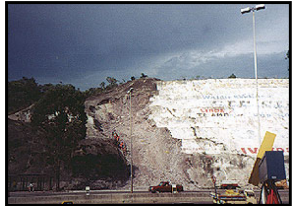
Foto 4 - Talude apresentando instabilidade geotécnica, com erosões generalizadas, escorregamentos e carreando grande volume de sedimentos
