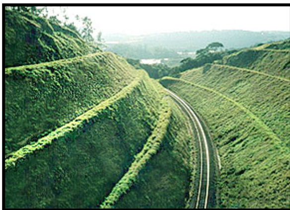
Foto 6 - Mesmo local imediatamente após a execução dos serviços, mostrando o aspecto visual, a proteção total dos taludes cuja superfície será coberta pela vegetação posteriormente
