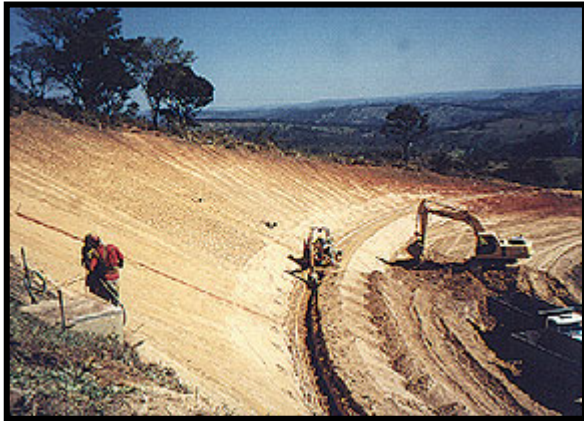
Foto 10 - Taludes e drenagem em construção, sendo o material do talude de grande suscetibilidade à erosão, por isso deverá ser protegido com segurança e rapidez
