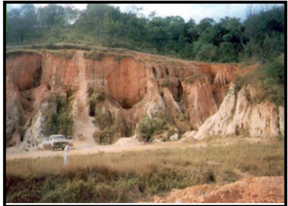
Foto 1 - Área erodida de difícil recuperação, a ser tratada com uso de Técnicas de Bioengenharia
