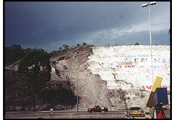
Foto 4 - Talude apresentando instabilidade geotécnica, com erosões generalizadas, escorregamentos e carreando grande volume de sedimentos
