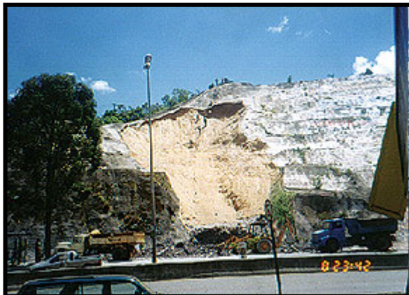
Foto 5 - A técnica utilizada para a contenção foi o solo grampeado verde, com uso de biomanta antierosiva de fibra de coco bidimensional (Tela Fibrax® 400BF)
