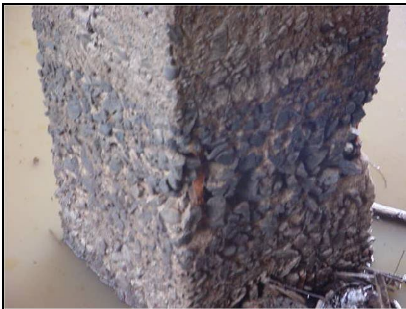
Foto 37 – Erosão na base do pilar
