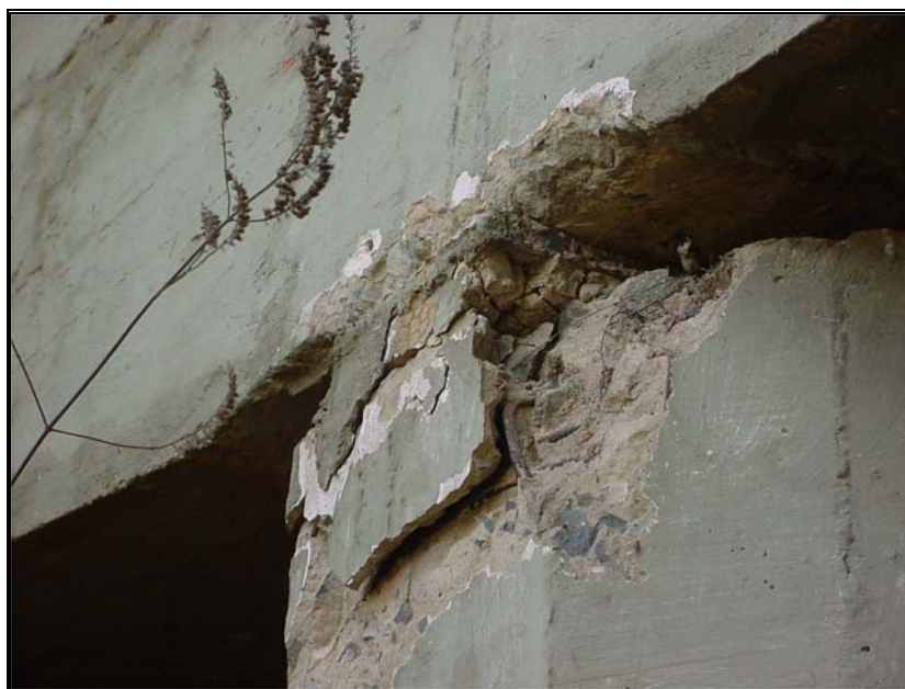
Foto 24 – Aparelho de apoio inadequado: Esmagamento do concreto no topo do pilar e fundo da viga principal
