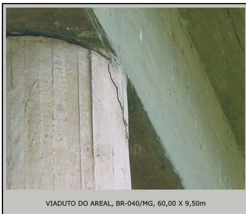
Foto 34 – Topo de Pilar Fraturado: Falta de cintamento adequado e placa de articulação levada até a extremidade
