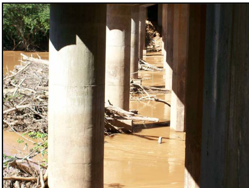
Foto 48 – Acúmulo de materiais flutuantes nos pilares
