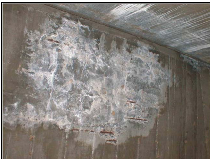
Foto 42 – Eflorescência em parede frontal
