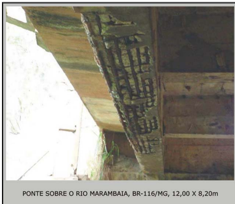
Foto 19 – Viga principal com deslocamento do concreto, armadura exposta e corroída
