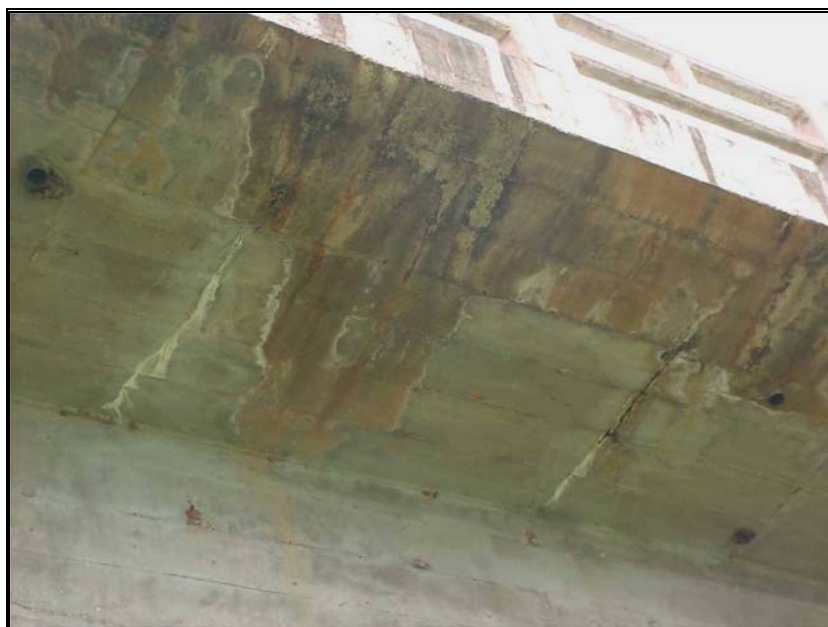
Foto 14 – Face inferior de laje em balanço sem pingadeira: Concreto deteriorado e armaduras aparentes com corrosão
