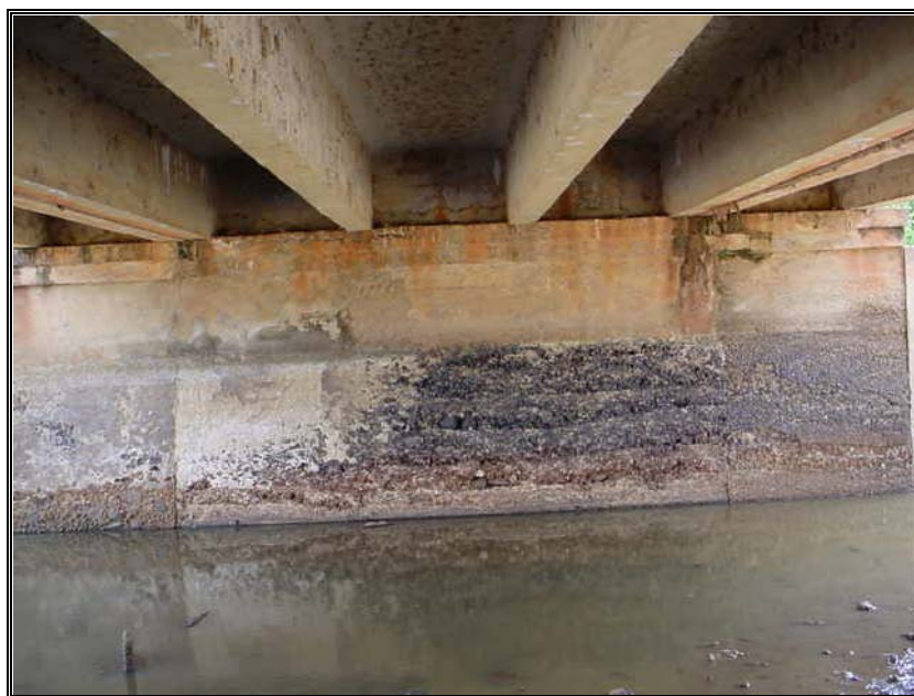
Foto 43 – Erosão em parede frontal
