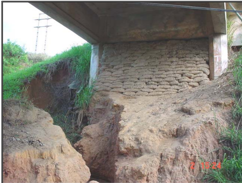
Foto 49 – Ponte curta, proteção emergencial com sacos de solo-cimento, erosão acentuada e falta de descida d'água
