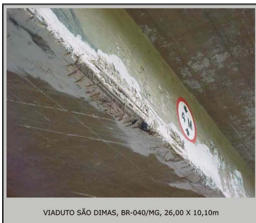
Foto 18 – Viga com deslocamento do concreto, ausência de cobrimento e estribos rompidos
