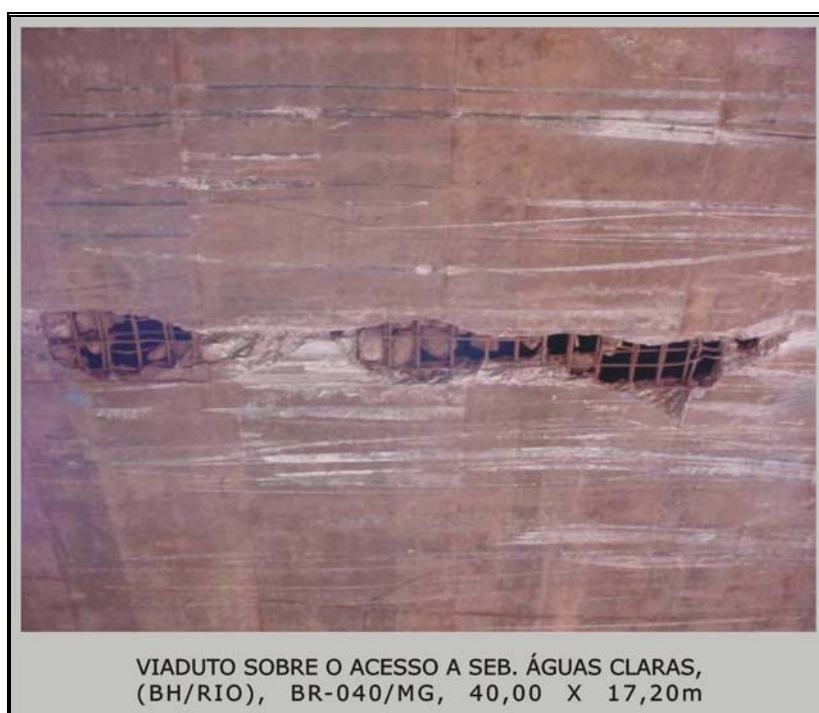
Foto 6 – Face inferior da laje superior: Vazios e armadura aparente
