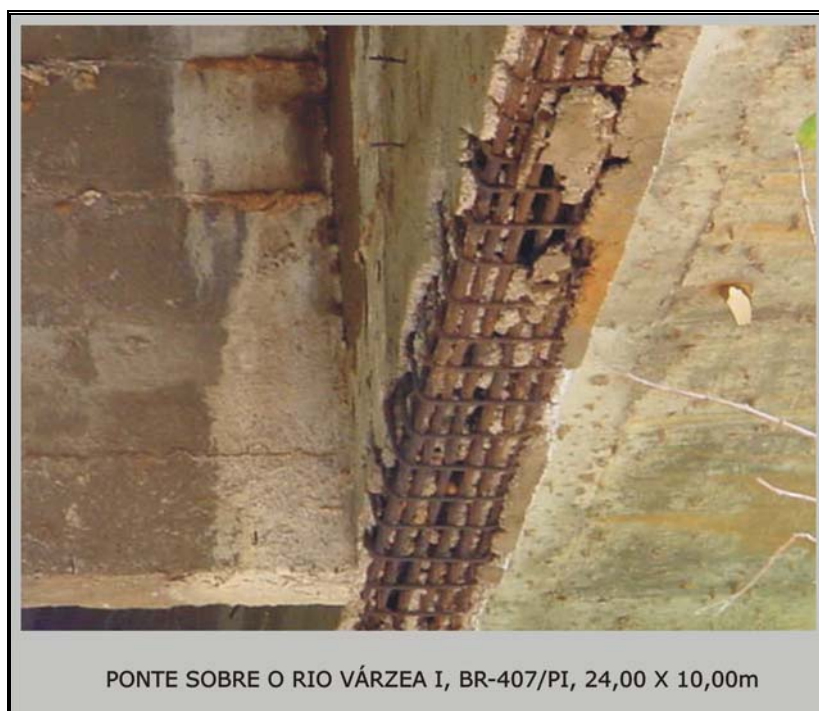
Foto 23 – Viga principal com concreto deslocado, vazios de concretagem e corrosão de armaduras aparentes
