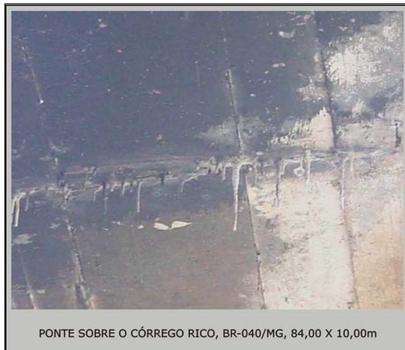
Foto 9 – Vista inferior da superestrutura: Infiltrações, trincas, eflorescência, armaduras expostas e corroídas
