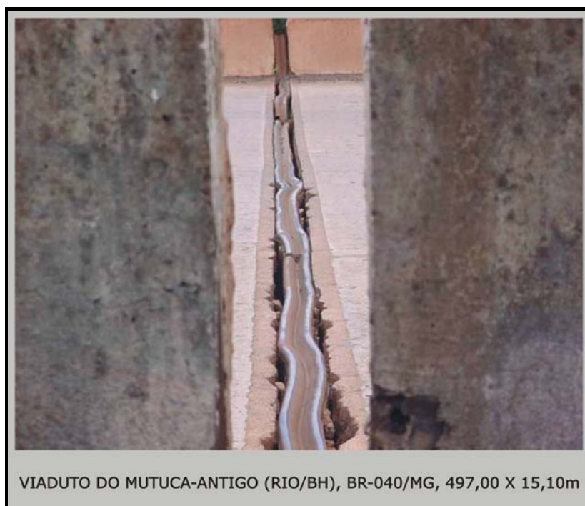
Foto 16 – Junta mal projetada e/ou executada, desgastada e ineficaz
