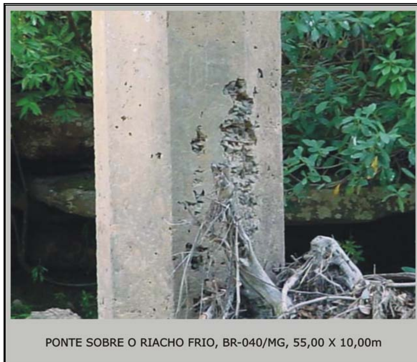
Foto 35 – Pilar com falhas de concretagem
