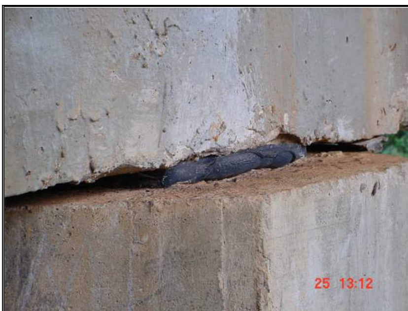
Foto 26 – Aparelho de apoio de neoprene esmagado
