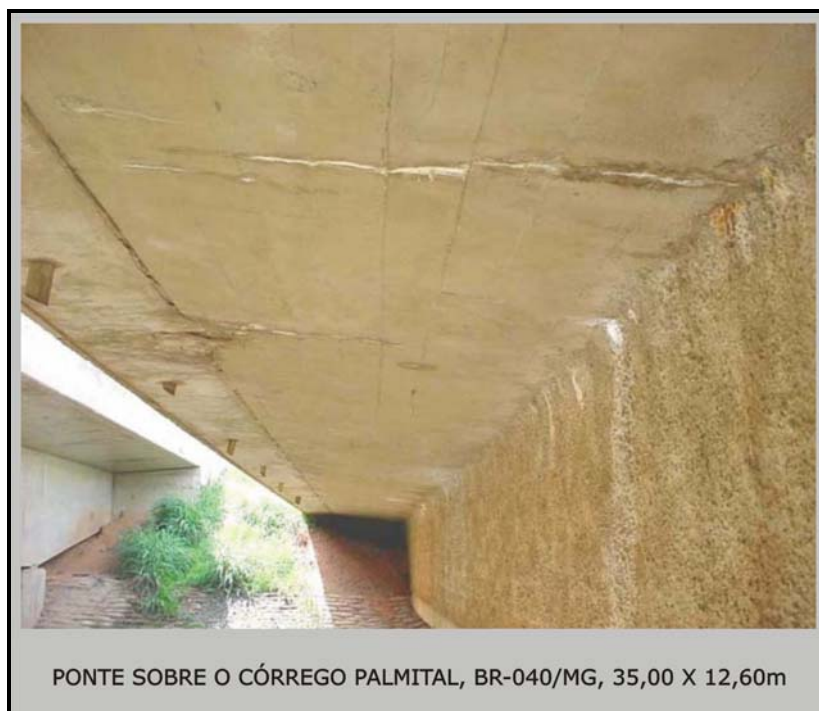
Foto 8 – Face inferior da laje superior: Infiltração e eflorescência
