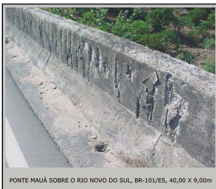
Foto 5 – Corrosão acentuada em barreira New Jersey
