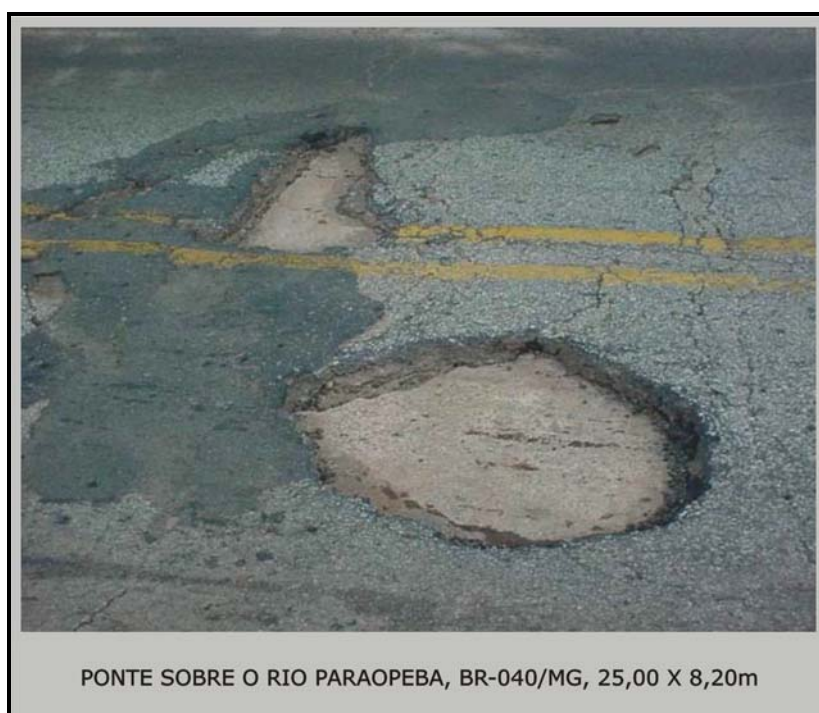
Foto 1 – Manutenção inadequada exigindo recuperação e/ou substituição
