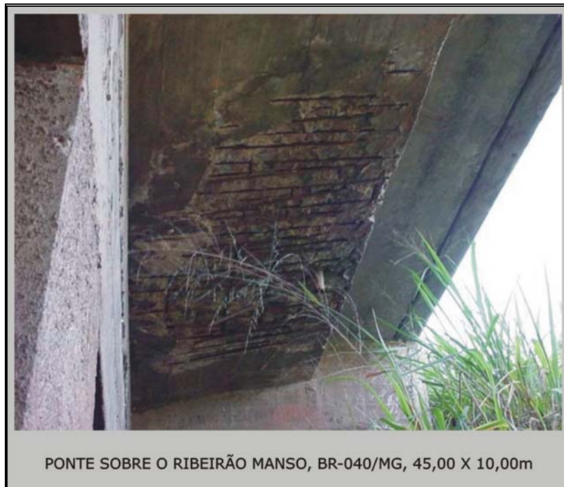
Foto 7 – Face inferior de laje em balanço sem pingadeira: Degradação do concreto, perda de cobrimento e armaduras expostas e corroídas.
