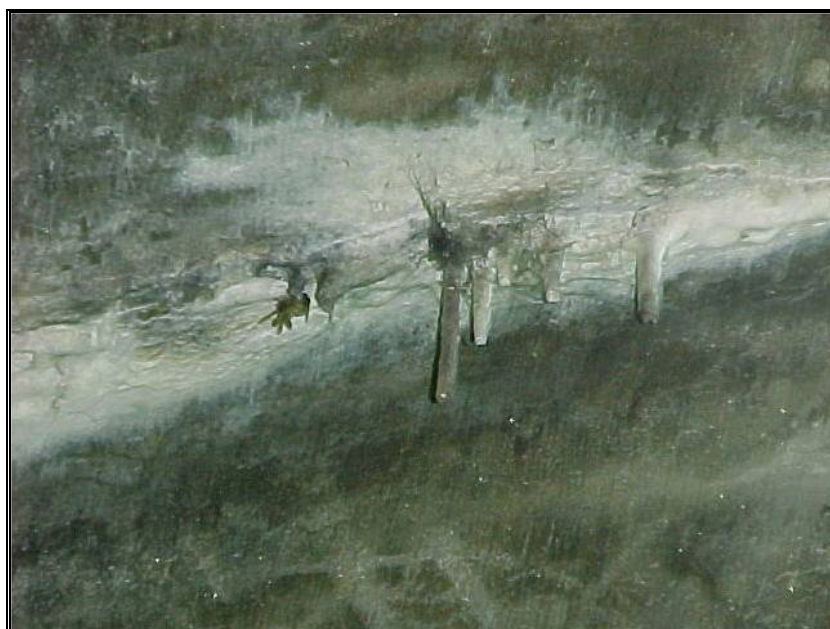
Foto 10 – Face inferior da laje: Eflorescência
