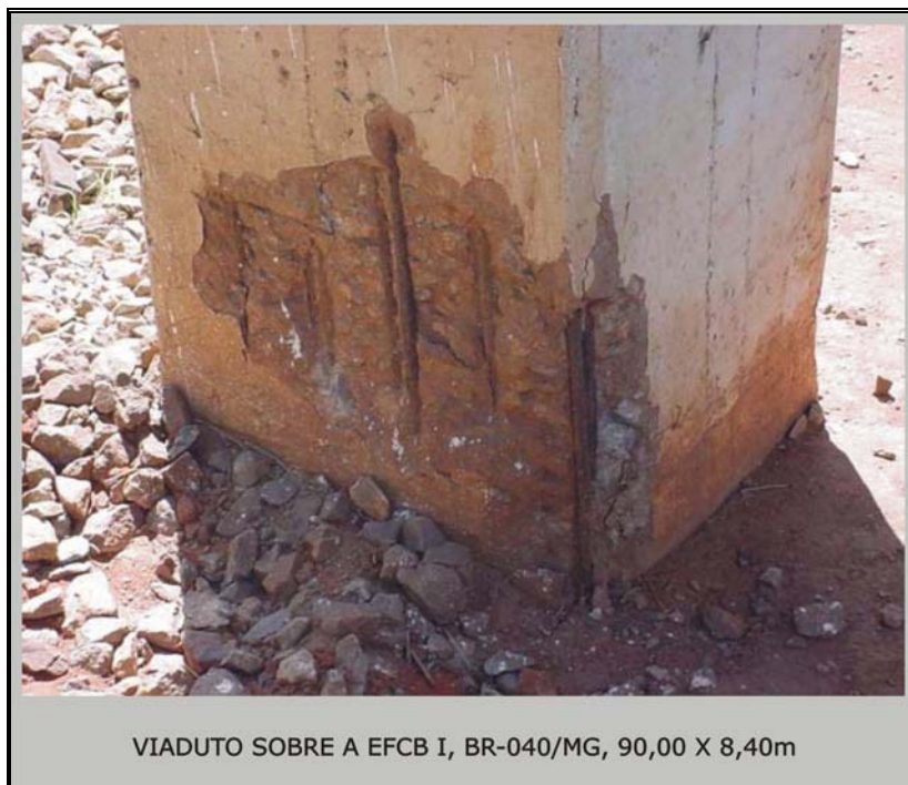
Foto 33 – Detalhe do pilar com deslocamento de concreto e corrosão de armaduras
