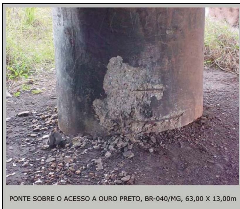
Foto 32 – Detalhe do pilar com deslocamento de concreto e corrosão de armaduras
