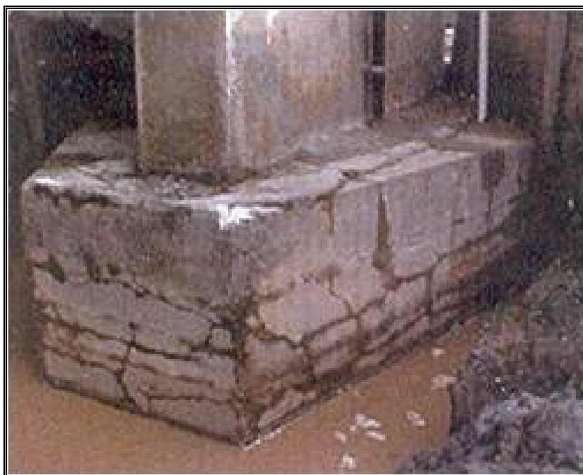
Foto 40 – Reação álcali-agregado em bloco de fundação
