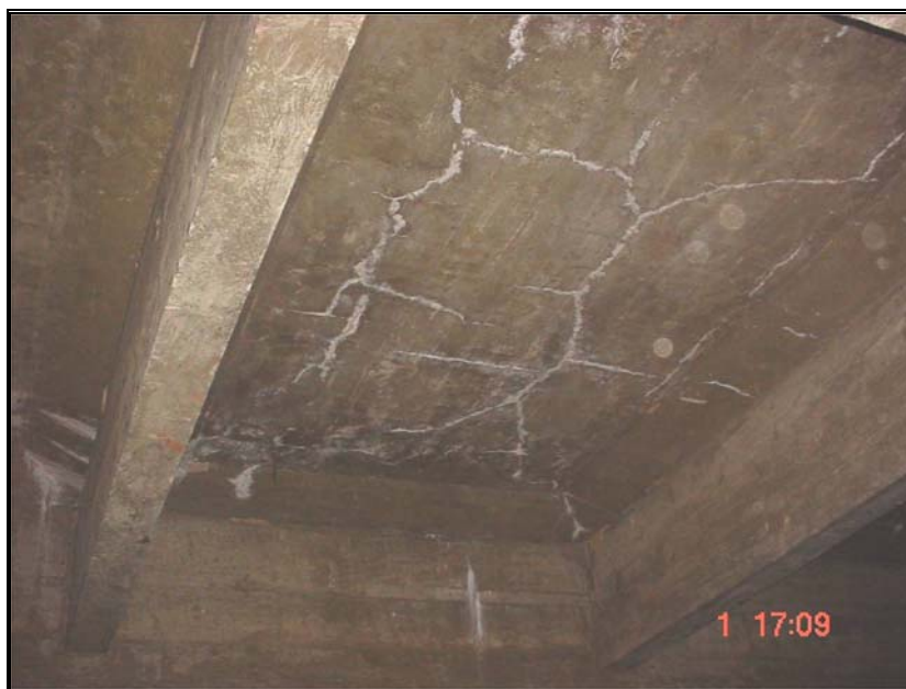
Foto 11 – Trincas, fissuras e eflorescência na face inferior da laje
