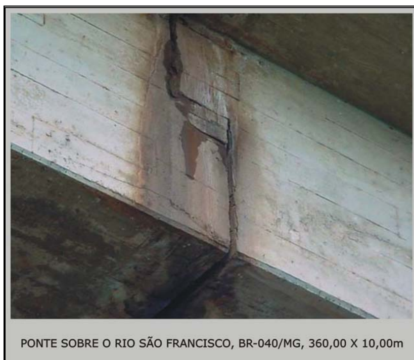
Foto 29 – Dentes em estado de pré-ruína e juntas de dilatação sem tratamento
