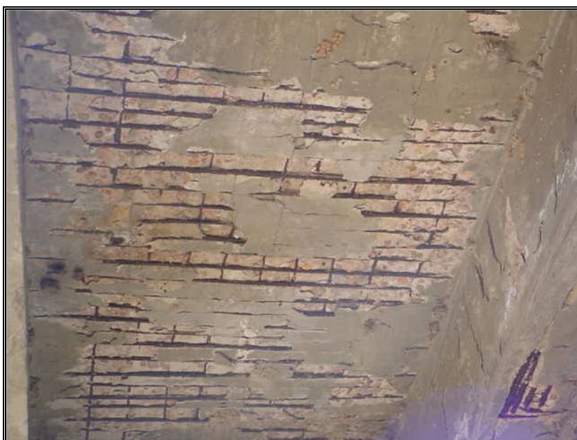
Foto 12 – Faces inferiores da laje e da viga principal: Deslocamento do concreto, cobrimento insuficiente e armadura aparente com corrosão
