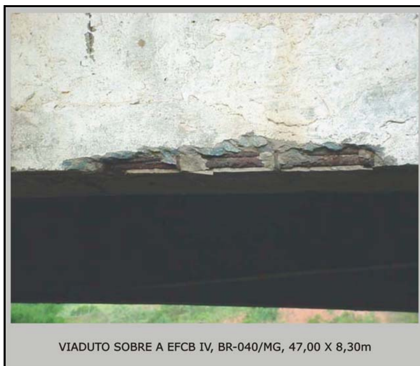
Foto 17 – Viga com canto quebrado, armadura aparente e corroída
