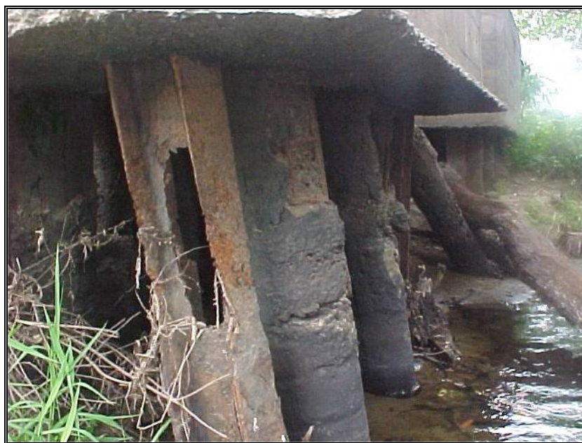
Foto 41 – Fundação em estacas expostas e danificadas
