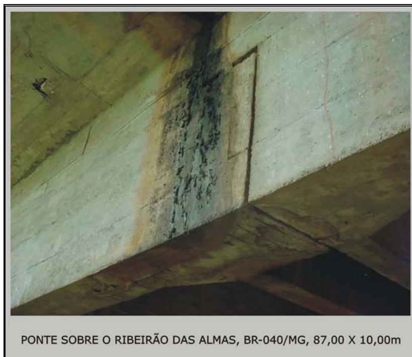
Foto 27 – Dentes ameaçados de degradação por infiltrações nas juntas de dilatação do estrado
