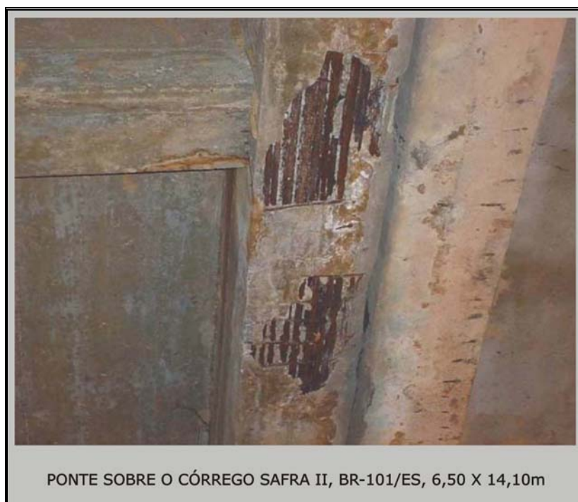
Foto 21 – Viga com deslocamento do concreto, ausência de cobrimento, armadura exposta e corroída
