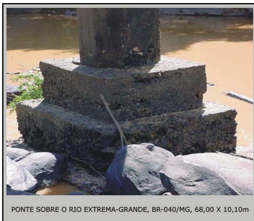
Foto 39 – Base do pilar e blocos atacados pela erosão
