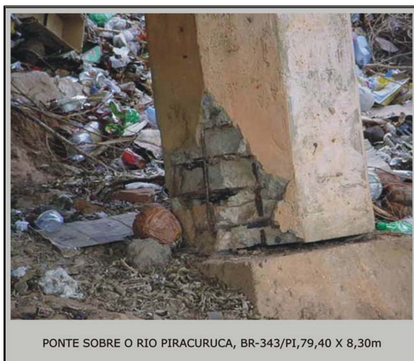
Foto 30 – Apoio pendular com fratura e/ou deslocamento de concreto e armaduras aparentes e corroídas
