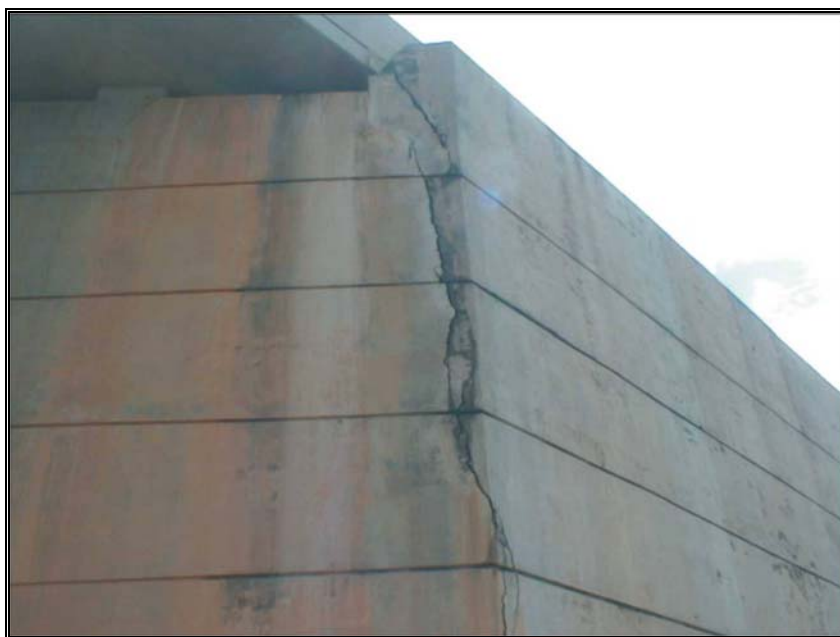
Foto 45 – Fratura no canto da parede frontal
