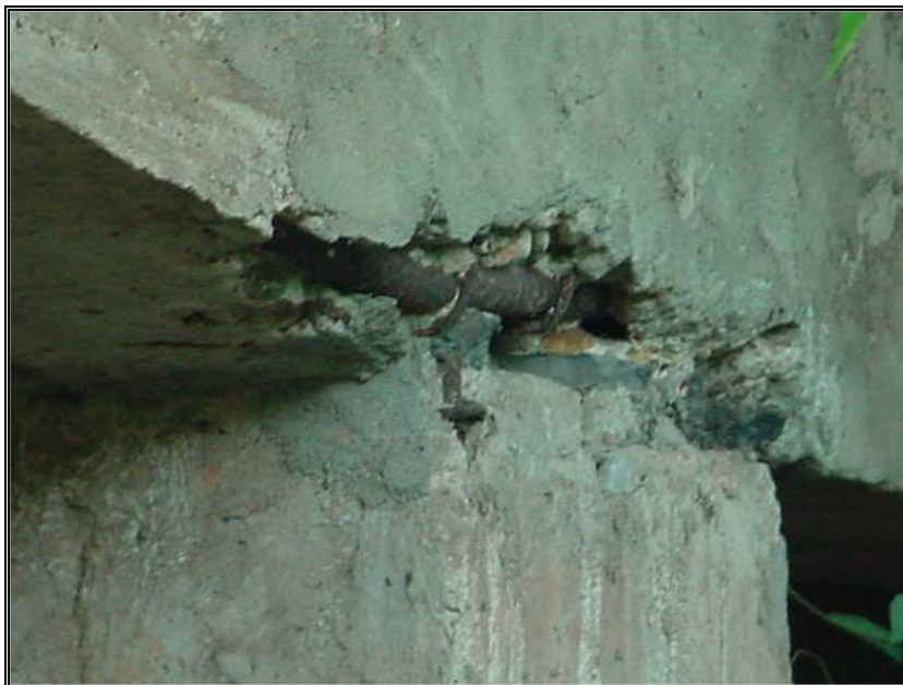
Foto 25 – Aparelho de apoio inadequado: Esmagamento do concreto no topo do pilar e fundo da viga principal
