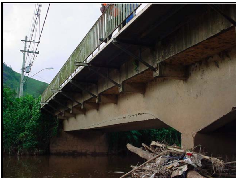
Foto 47 – Acúmulo de materiais flutuantes nos pilares
