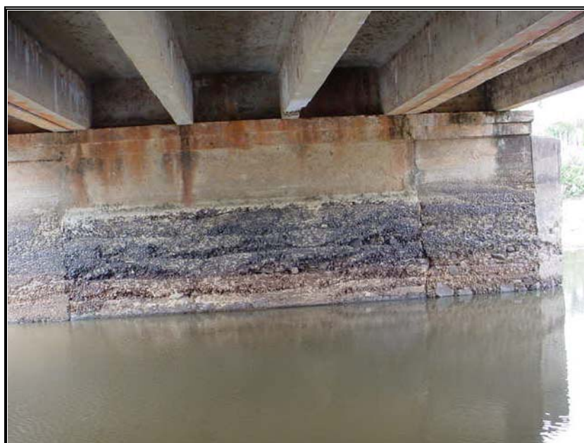
Foto 44 – Erosão em parede frontal
