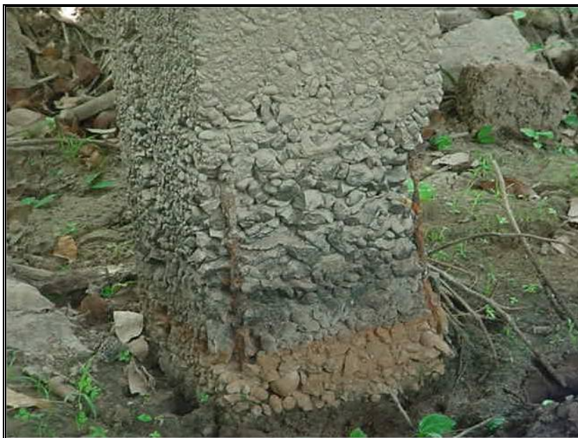
Foto 38 – Erosão na base do pilar
