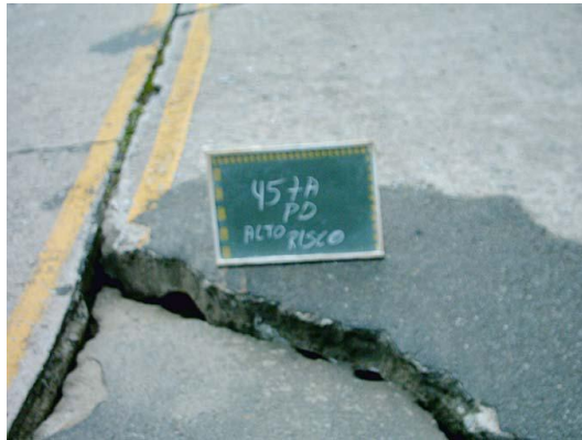
Foto 4 – Quebra de canto
