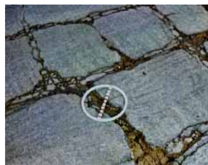
Foto do trincamento em blocos
