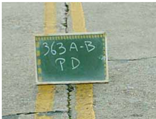
Falha na Selagem das Juntas
