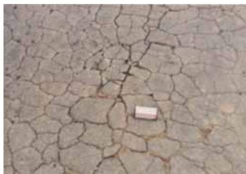
Foto trinca interligada tipo Jacaré
