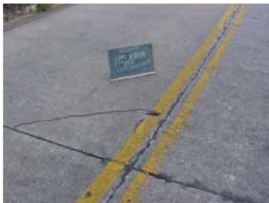
Fissuras de Canto
