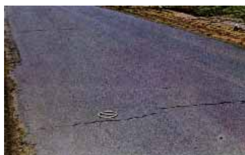
Foto de trincamento transversal
