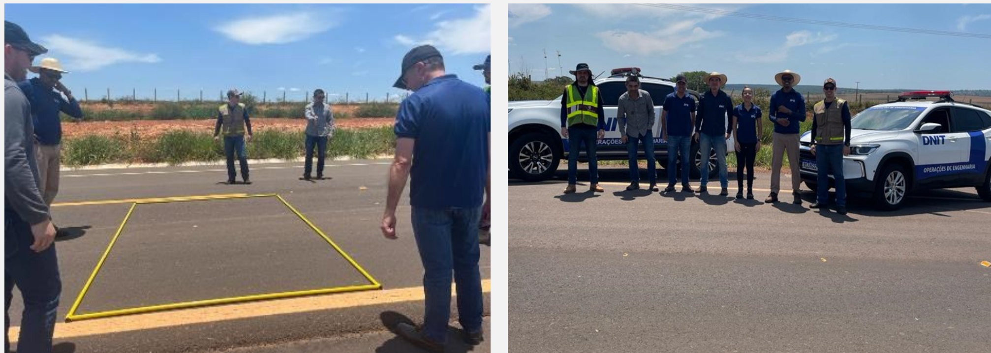
Figura 24: levantamento de área trincada na BR-419/MS.
