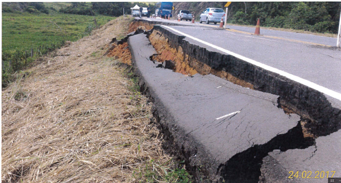
Figura 7 – Detalhe da ruptura do pavimento e corpo do aterro.
