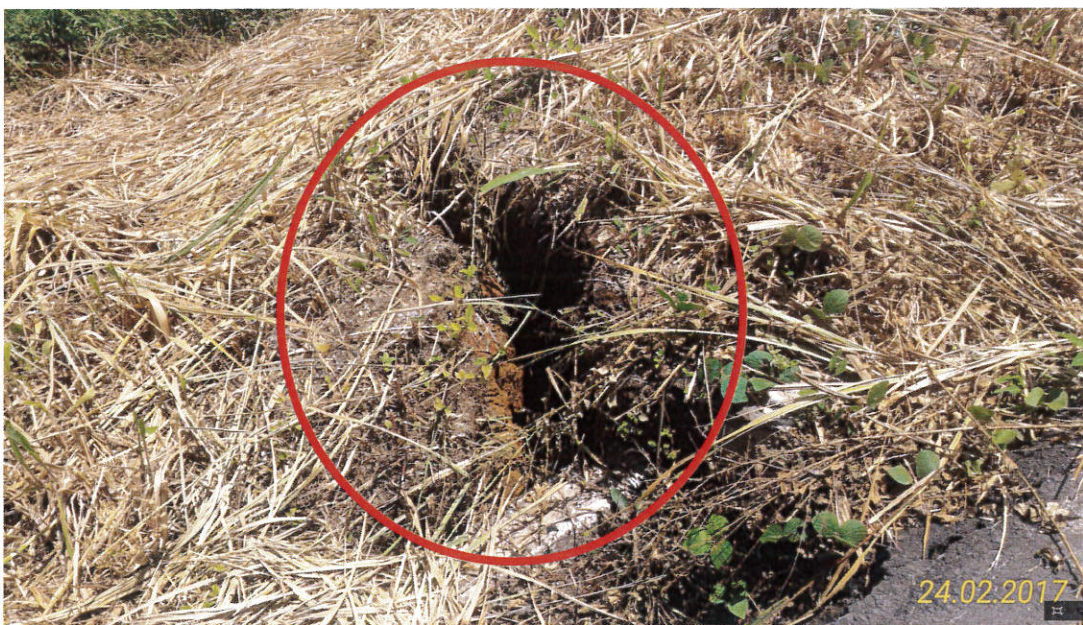
Figura 8 – Propagação da Trinca no corpo do aterro estradal.
