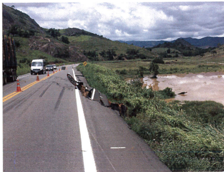
Figura 2 – Vista do alagamento a jusante da rodovia, confluência com talvegue menor e bacia do córrego Treviso Grande.
