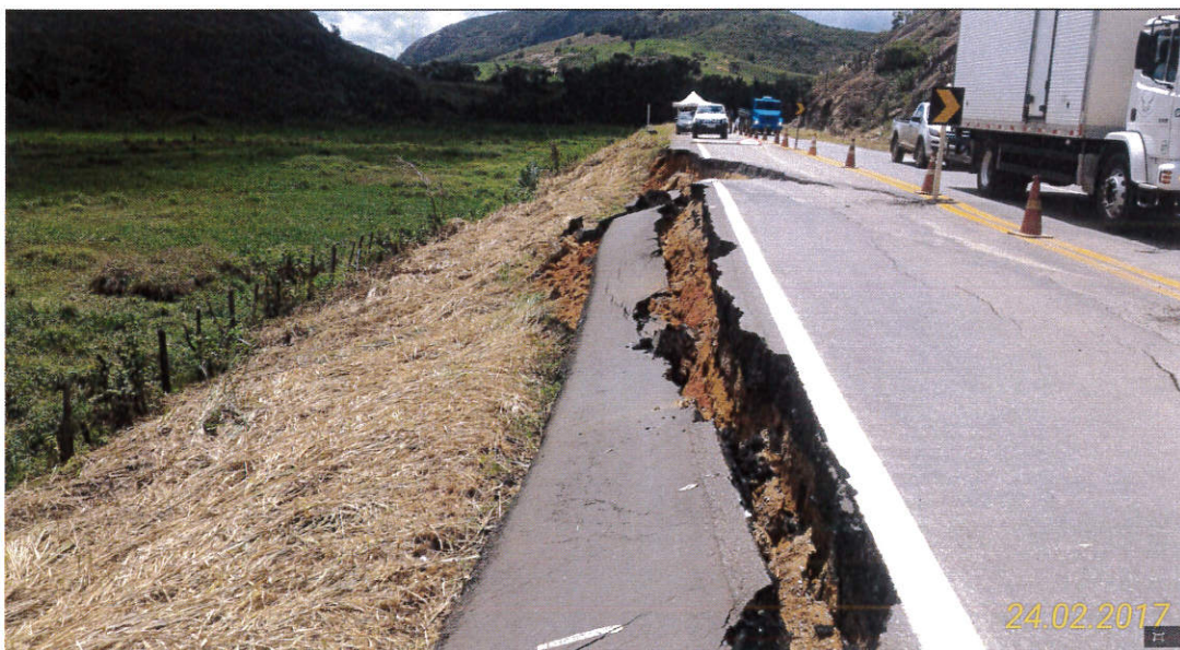
Figura 6 – Rompimento do corpo estradal e presença de trincas circulares com formação de cunha de ruptura.
