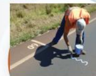
Identificação de defeitos no pavimento
