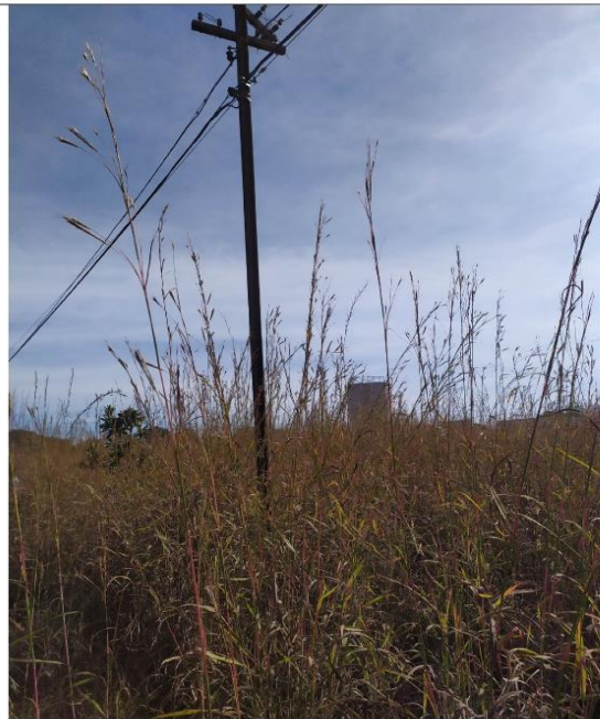
Foto 23 - Poste de Trilho - TR25 - 8 metros.
