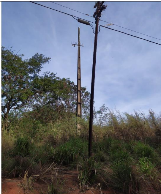
Foto 03 - Poste de Trilho - TR25 - 8 metros.
