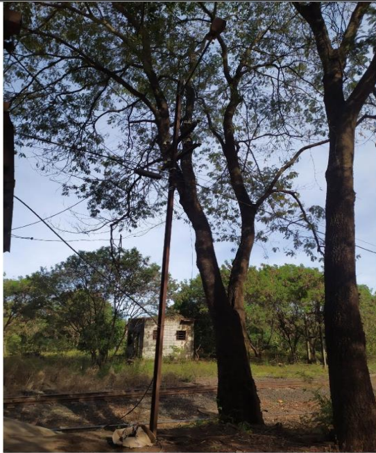
Foto 01 - Poste de Trilho - TR25 - 8 metros.
