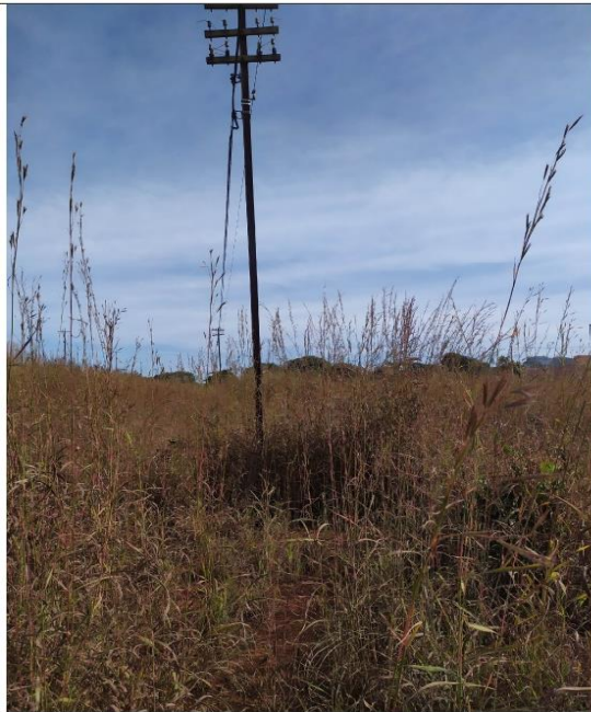
Foto 25 – Poste de Trilho – TR25 – 8 metros.
