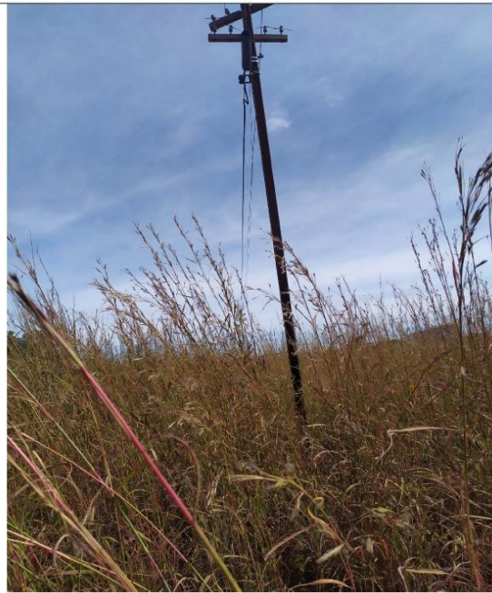
Foto 09 – Poste de Trilho – TR25 – 8 metros
