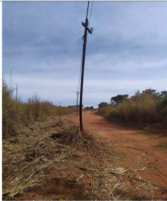
Foto 05 – Poste de Trilho – TR25 – 8 metros.
