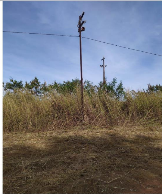
Foto 29 – Poste de Trilho – TR25 – 8 metros.
