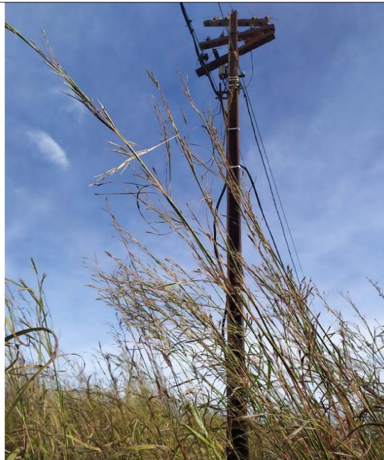
Foto 19 - Poste de Trilho - TR25 - 8 metros.
