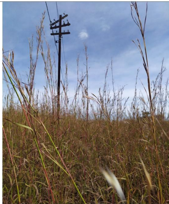
Foto 11 – Poste de Trilho – TR25 – 8 metros.
