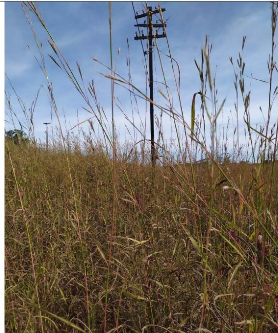
Foto 13 – Poste de Trilho – TR25 – 8 metros.
