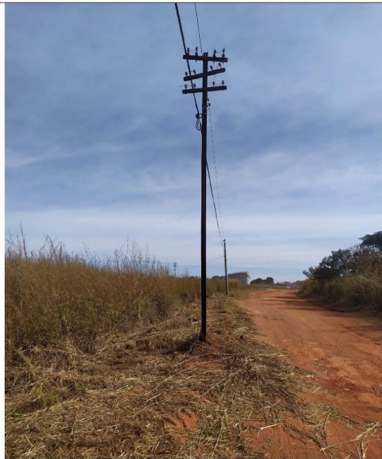
Foto 07 – Poste de Trilho – TR25 – 8 metros.
