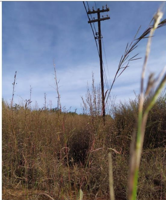
Foto 27 – Poste de Trilho – TR25 – 8 metros.
