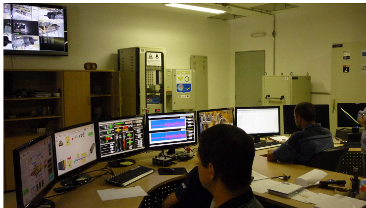
Sala de controle do LETG, incluindo os sistemas de proteção e de aquisição de dados.
