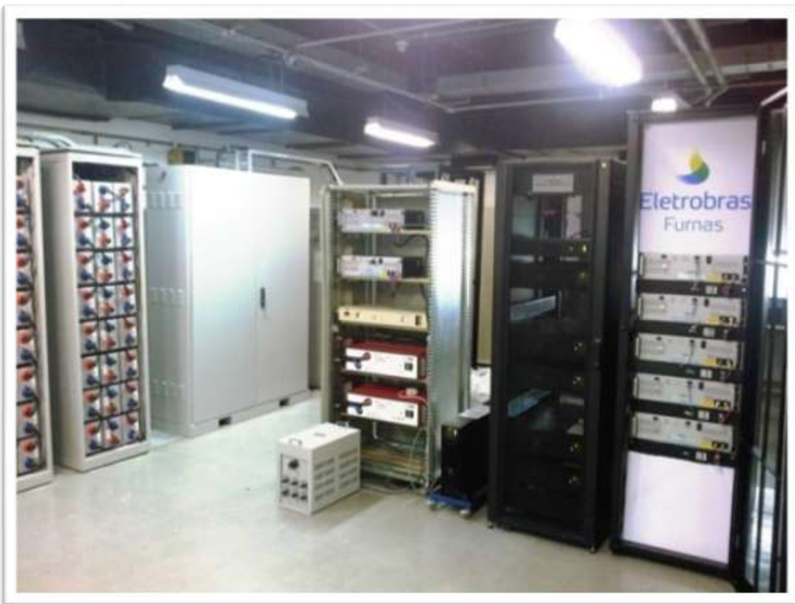
Baterias de lítio (48V) substituindo bancos de baterias chumbo-ácidas
