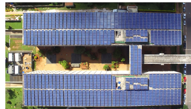
Usina Fotovoltaica Ed. Anexo MD (vista superior)
