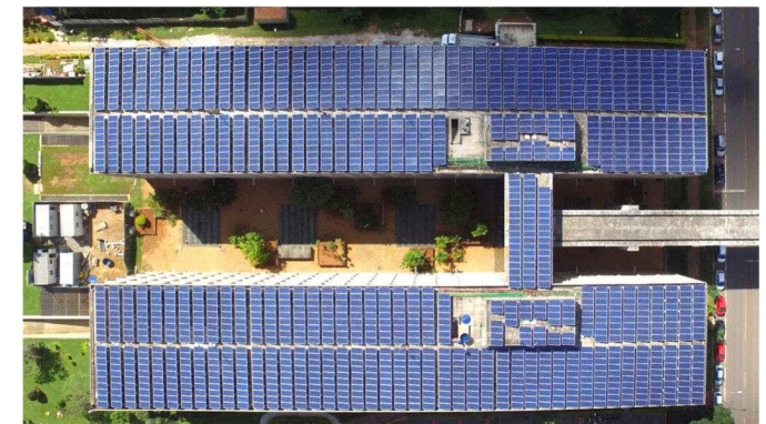
Usina Fotovoltaica Ed. Anexo MD (vista superior)
