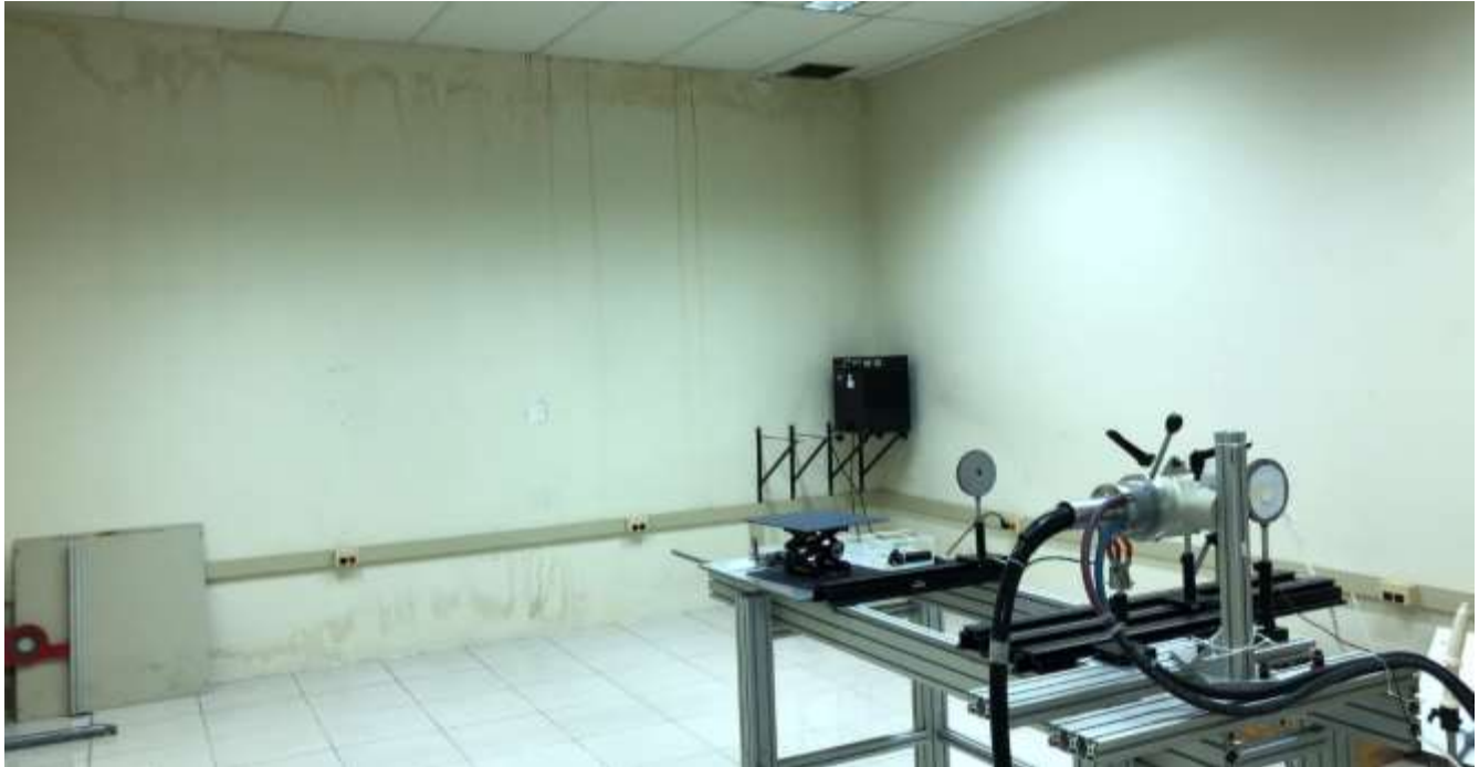
Figura 127 - Manchas de infiltração provenientes da fachada
