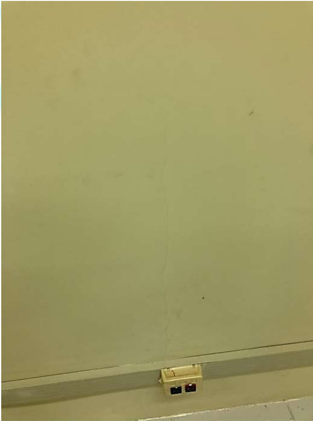
Figura 141 - Fissuras e sujidades
