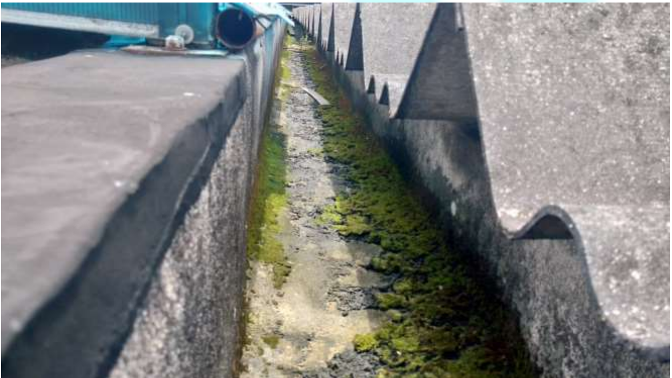
Figura 66 - Calha coberta por lodo
