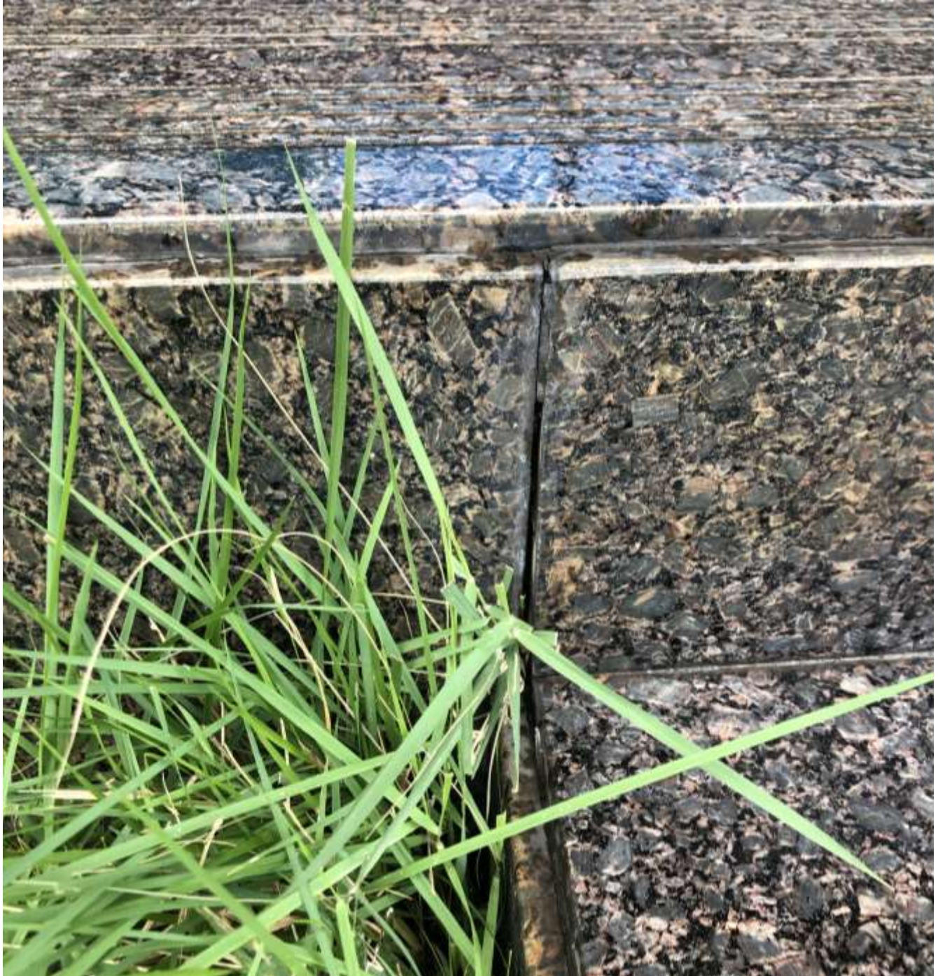
Figura 18 - Ausência de rejunte na escada
