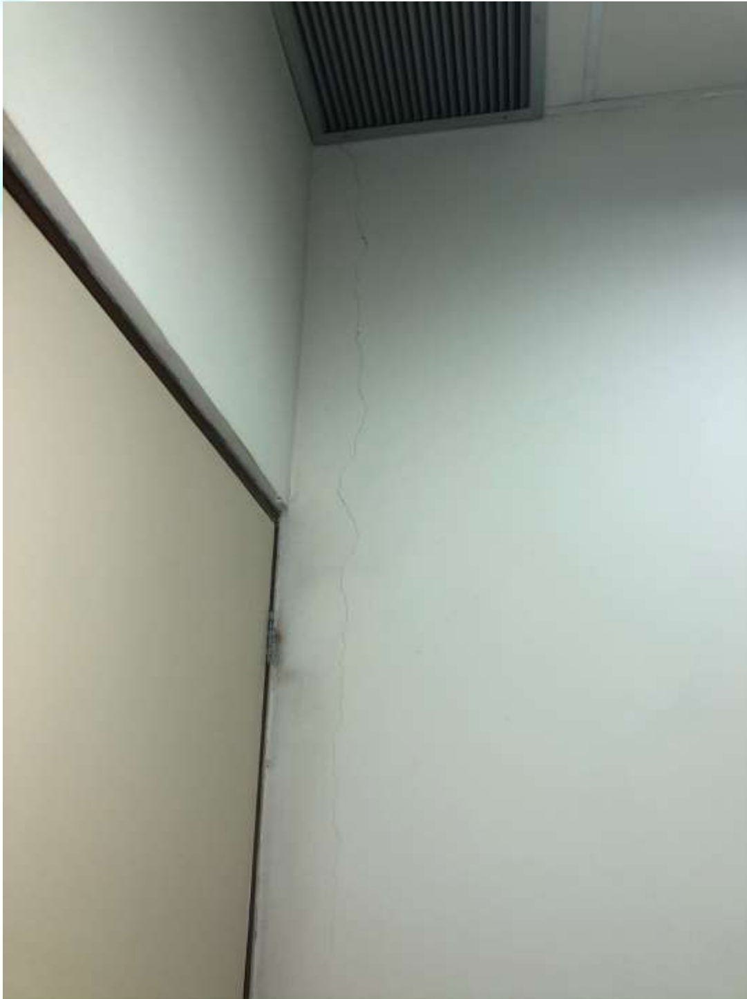
Figura 87 - Fissura na parede
