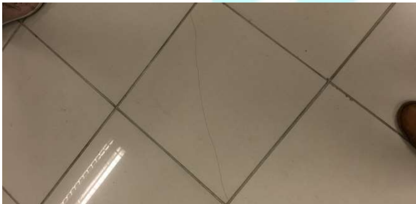
Figura 108 – Pedras de cerâmicas no piso fissuradas
