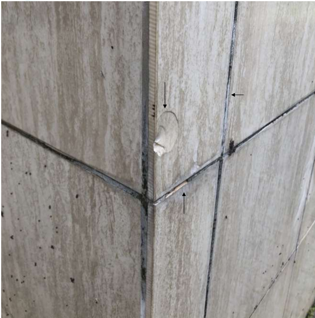
Figura 3 - Sujidades, ausência de rejunte, pontos de eflorescência e pedra quebrada
