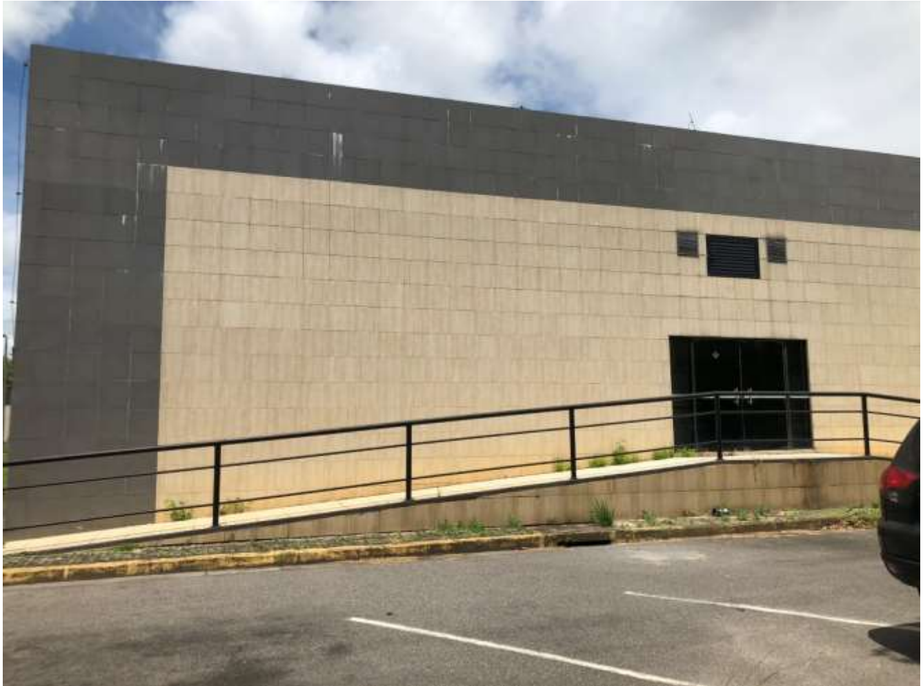
Figura 51 - Sujidades e pontos de eflorescência na fachada posterior
