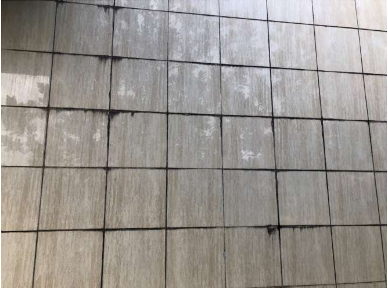
Figura 2 – Sujidades nas bordas e rejuntas das cerâmicas
