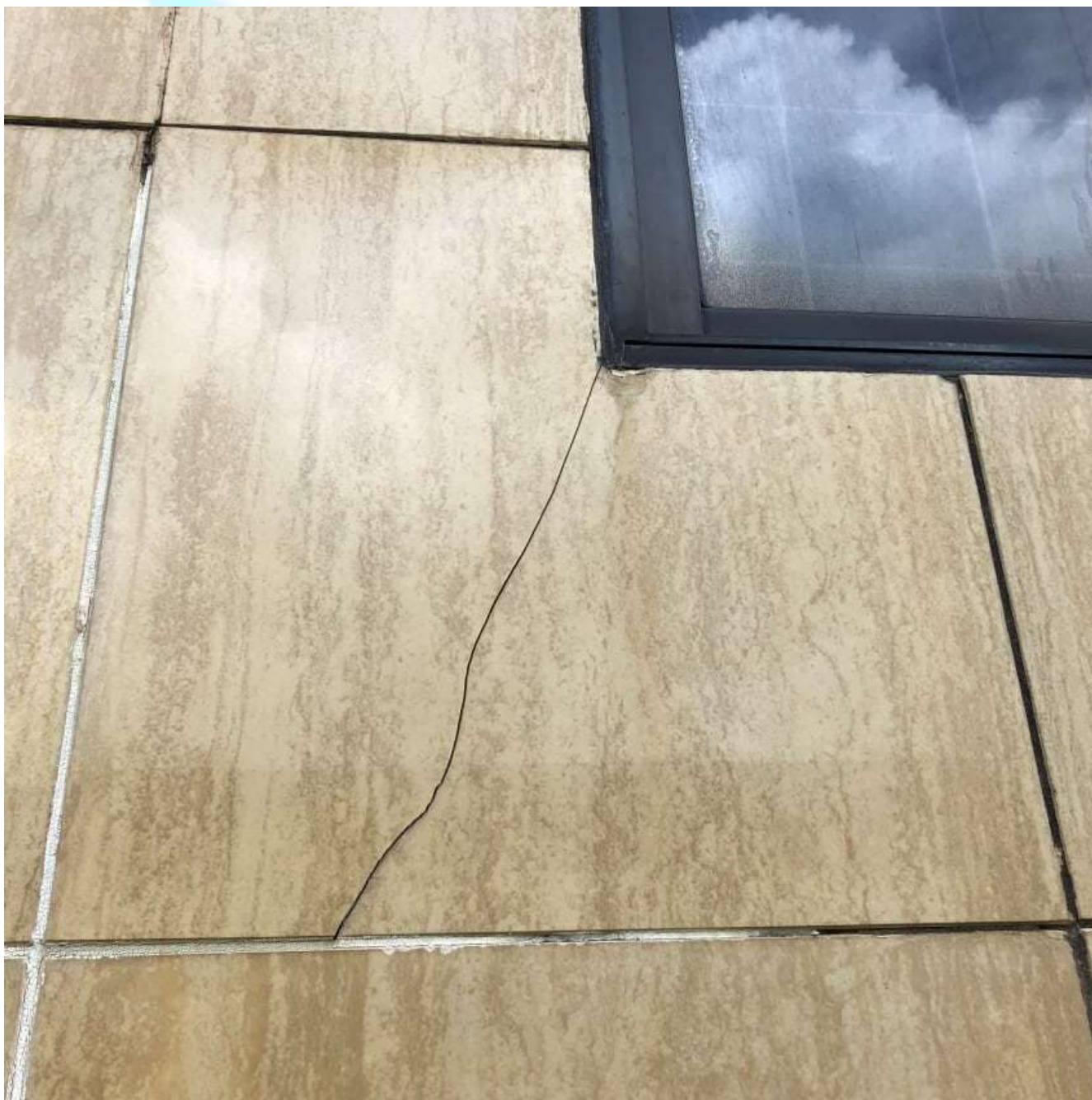
Figura 27 - Cerâmica quebrada, sujidades e pontos de eflorescência
