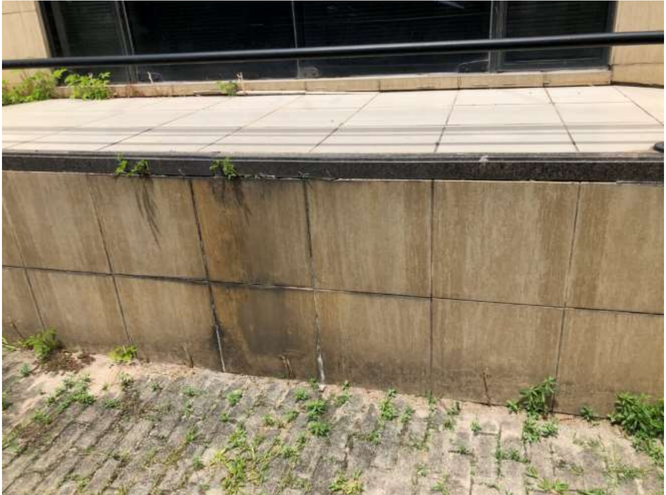
Figura 49 - Sujidades e pontos de eflorescência na lateral da rampa
