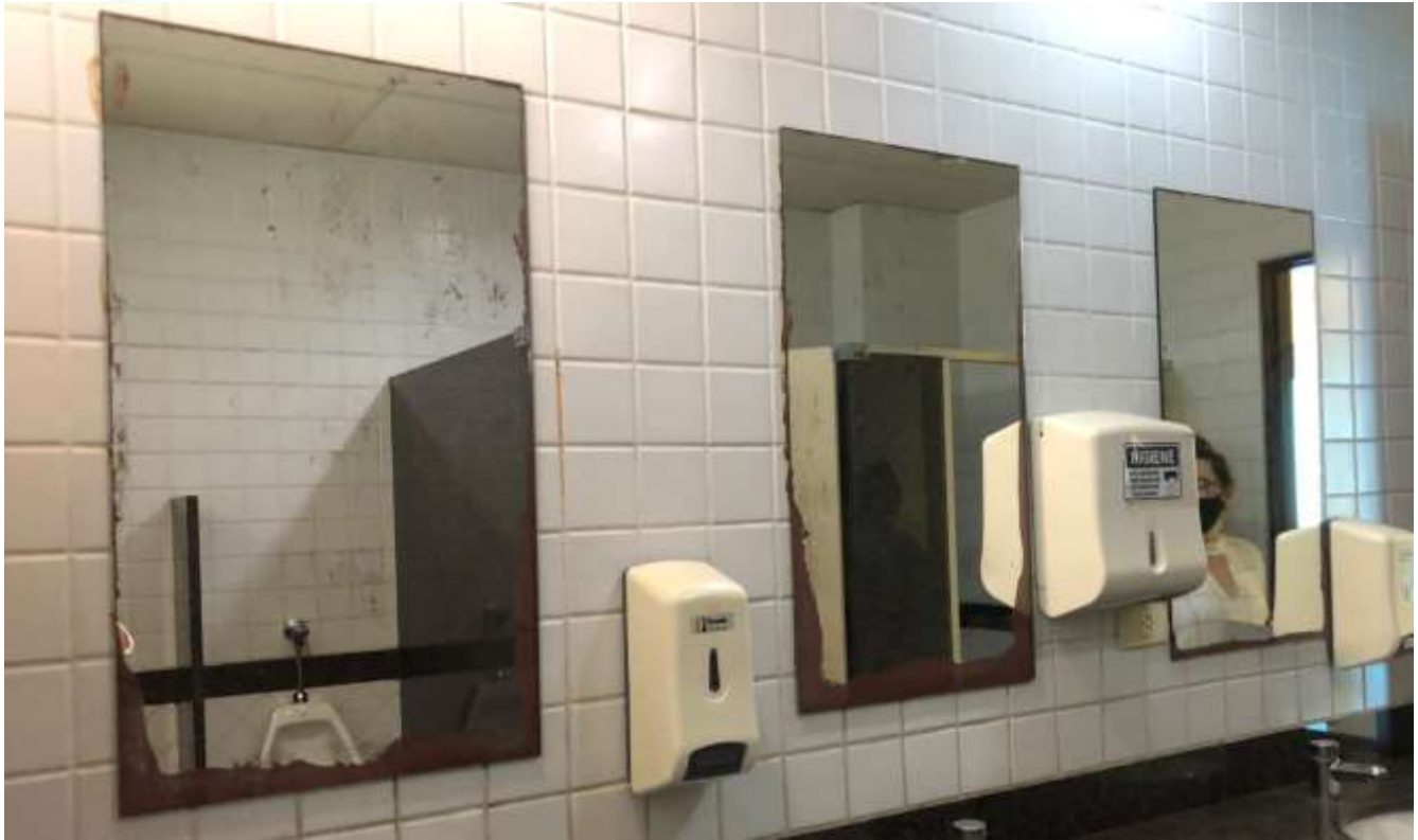
Figura 145 - Espelhos danificados (Wc Masculino)
