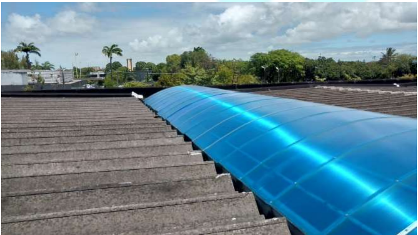
Figura 64 - Encontro da telha de fibrocimento com a cobertura de policarbonato azul
