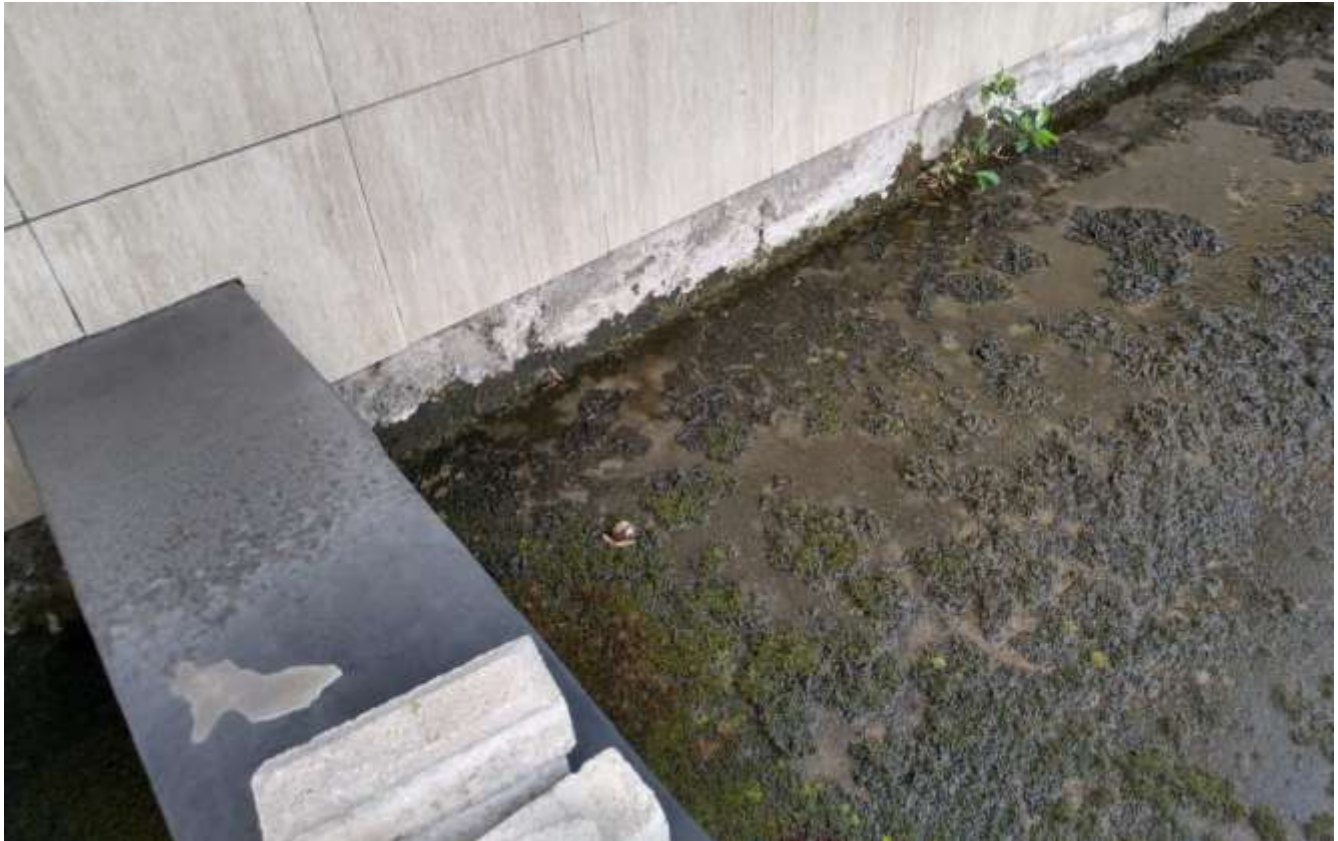
Figura 74 - Laje coberta de lodo sem impermeabilização
