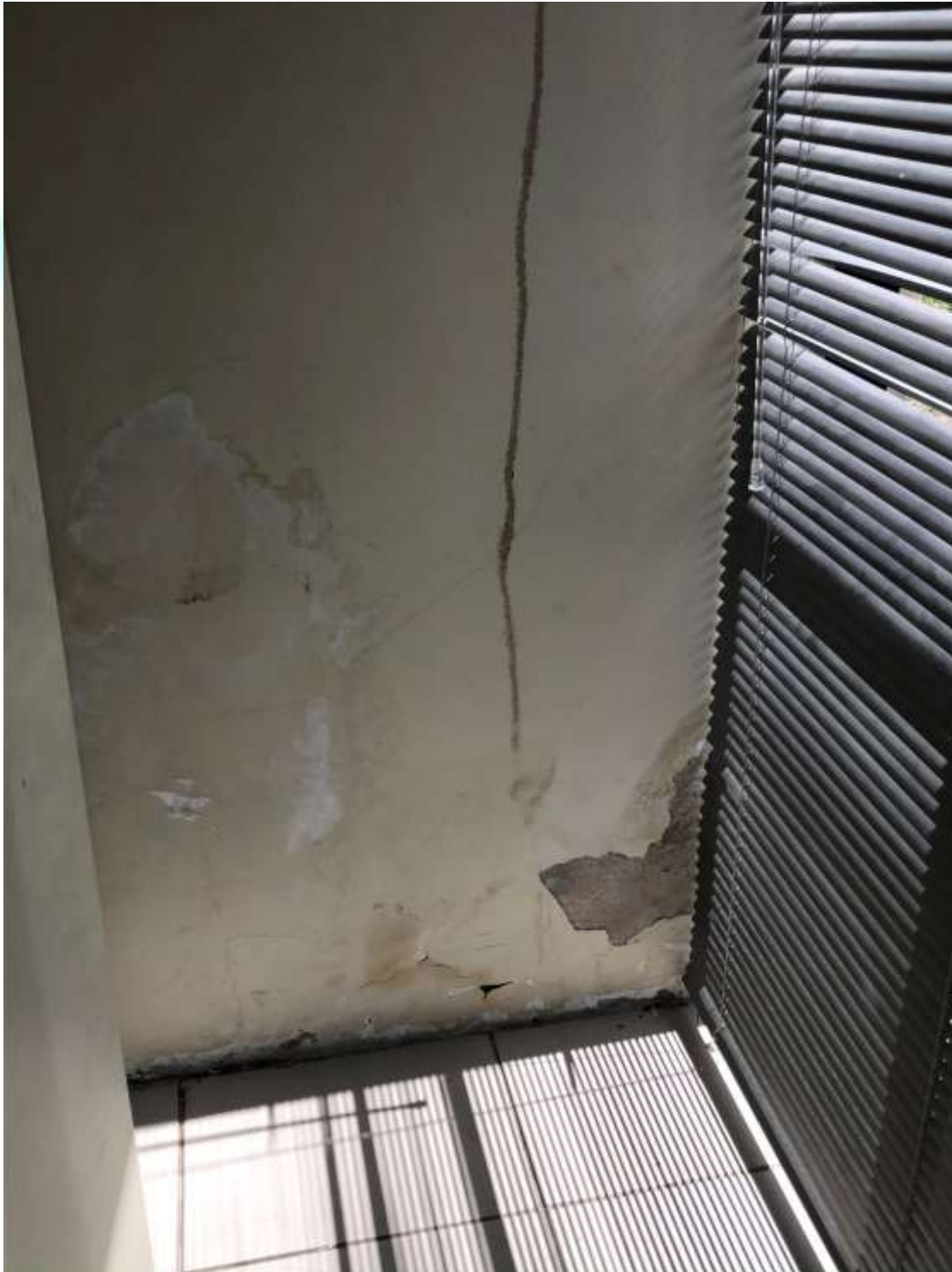
Figura 101 - Infiltração proveniente da fachada
