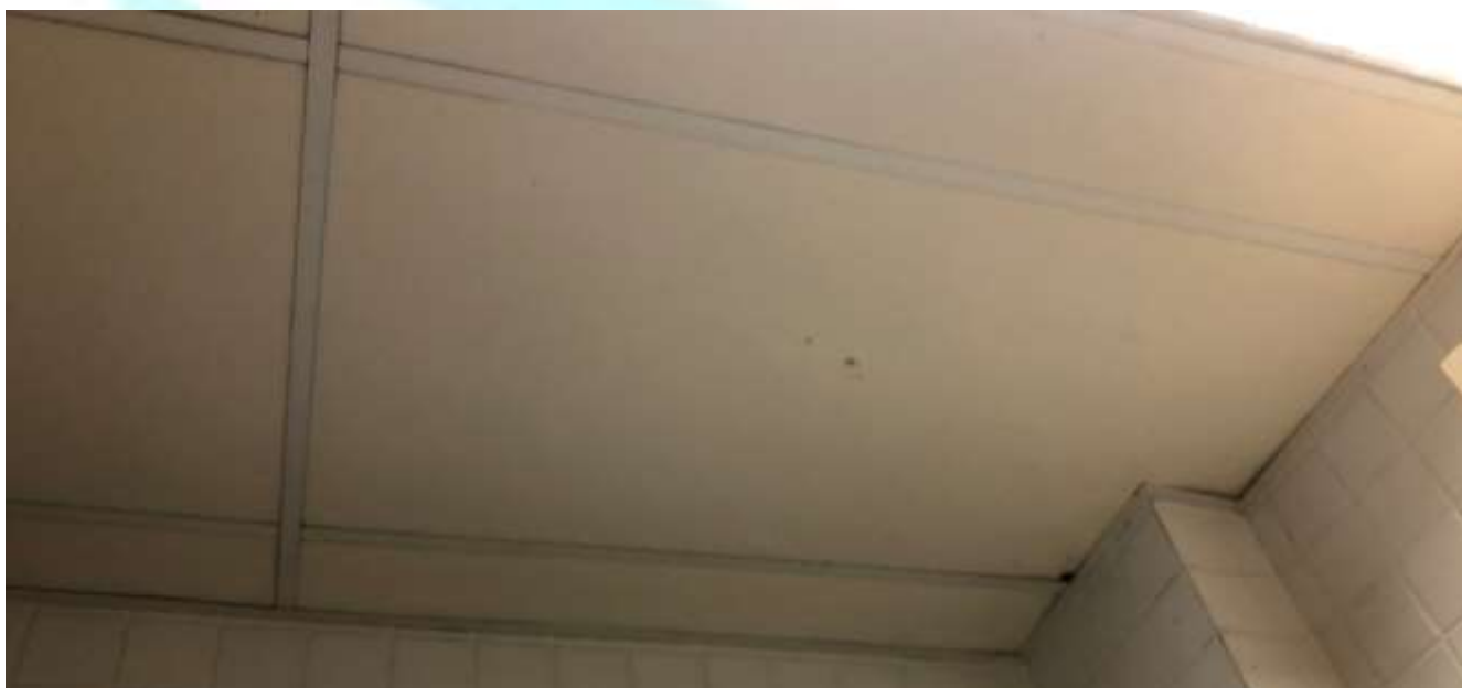
Figura 147 - Placa de forro danificada
