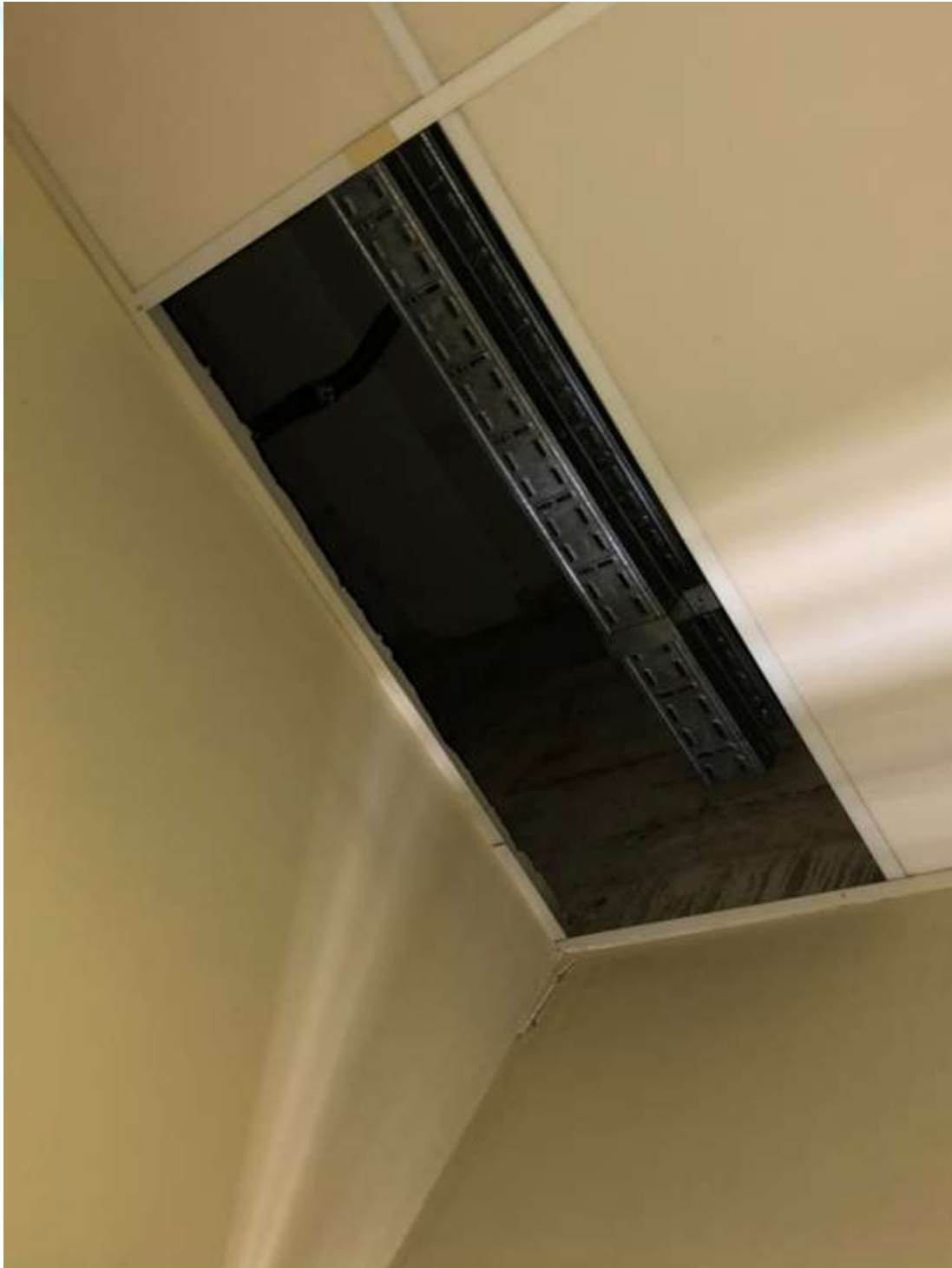
Figura 177 - Placa de forro faltante
