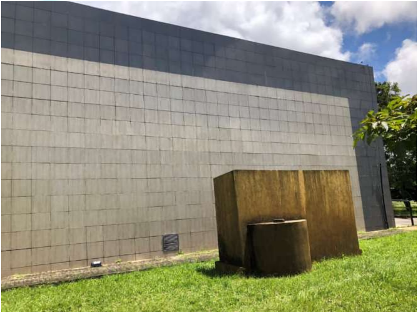
Figura 54 - Sujidades e rejuntas danificadas
