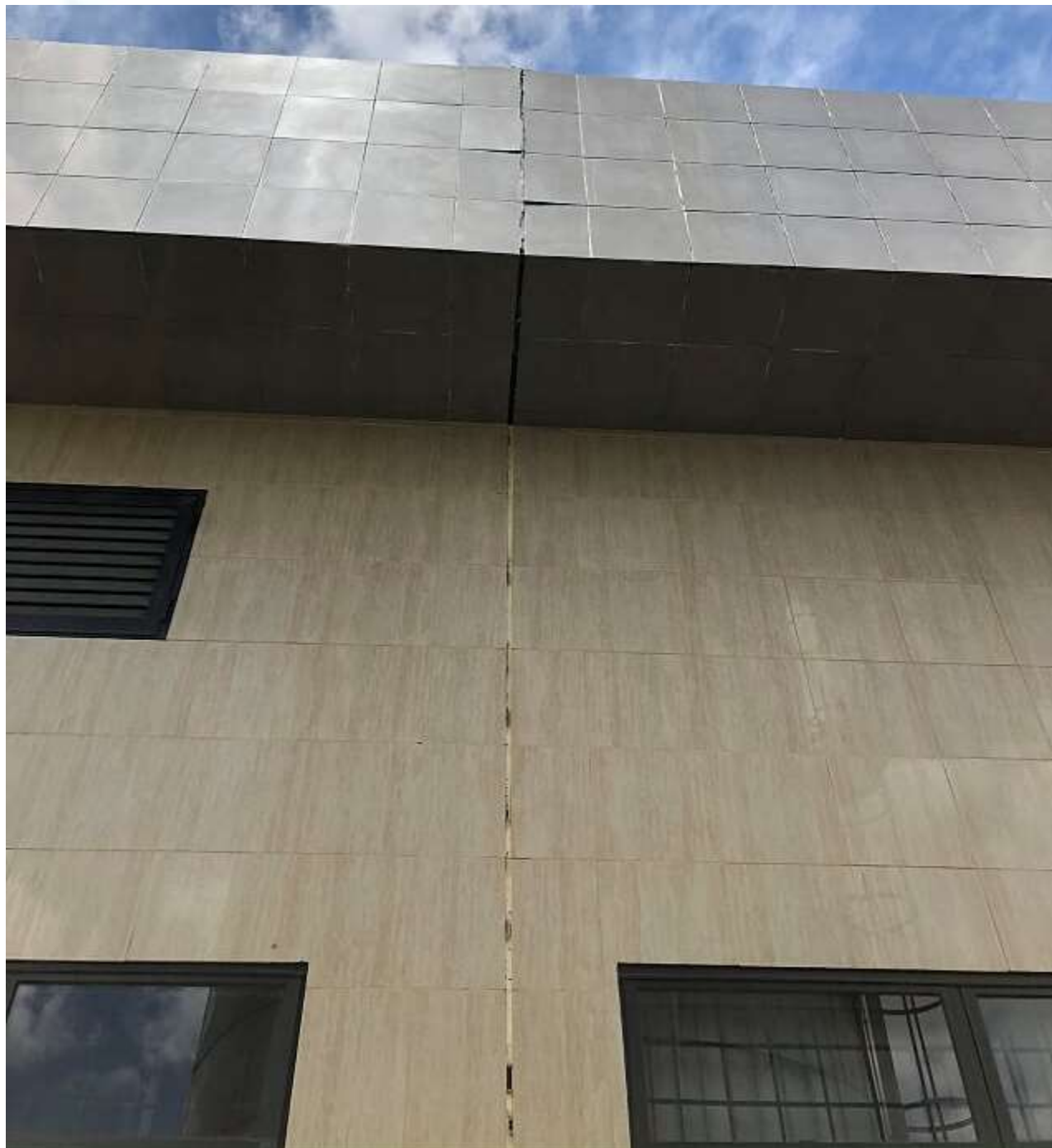
Figura 38 - Junta de dilatação deteriorada, deslocamento na platibanda, sujeira e eflorescência
