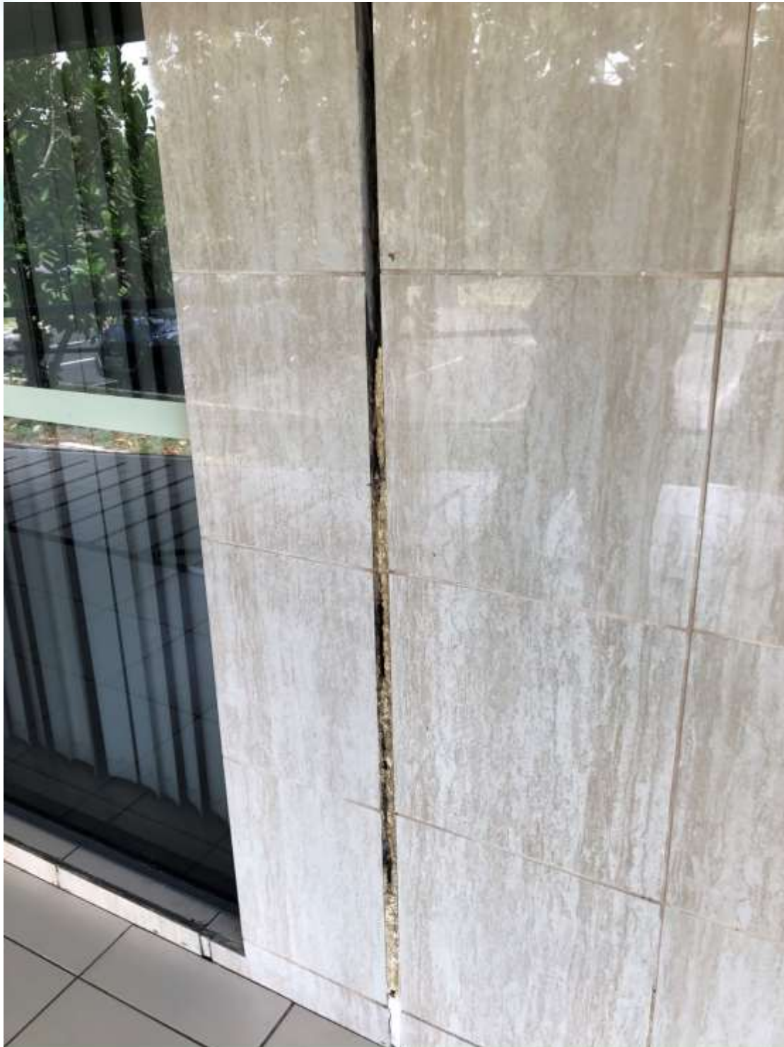
Figura 4 - Junta de dilatação degradada
