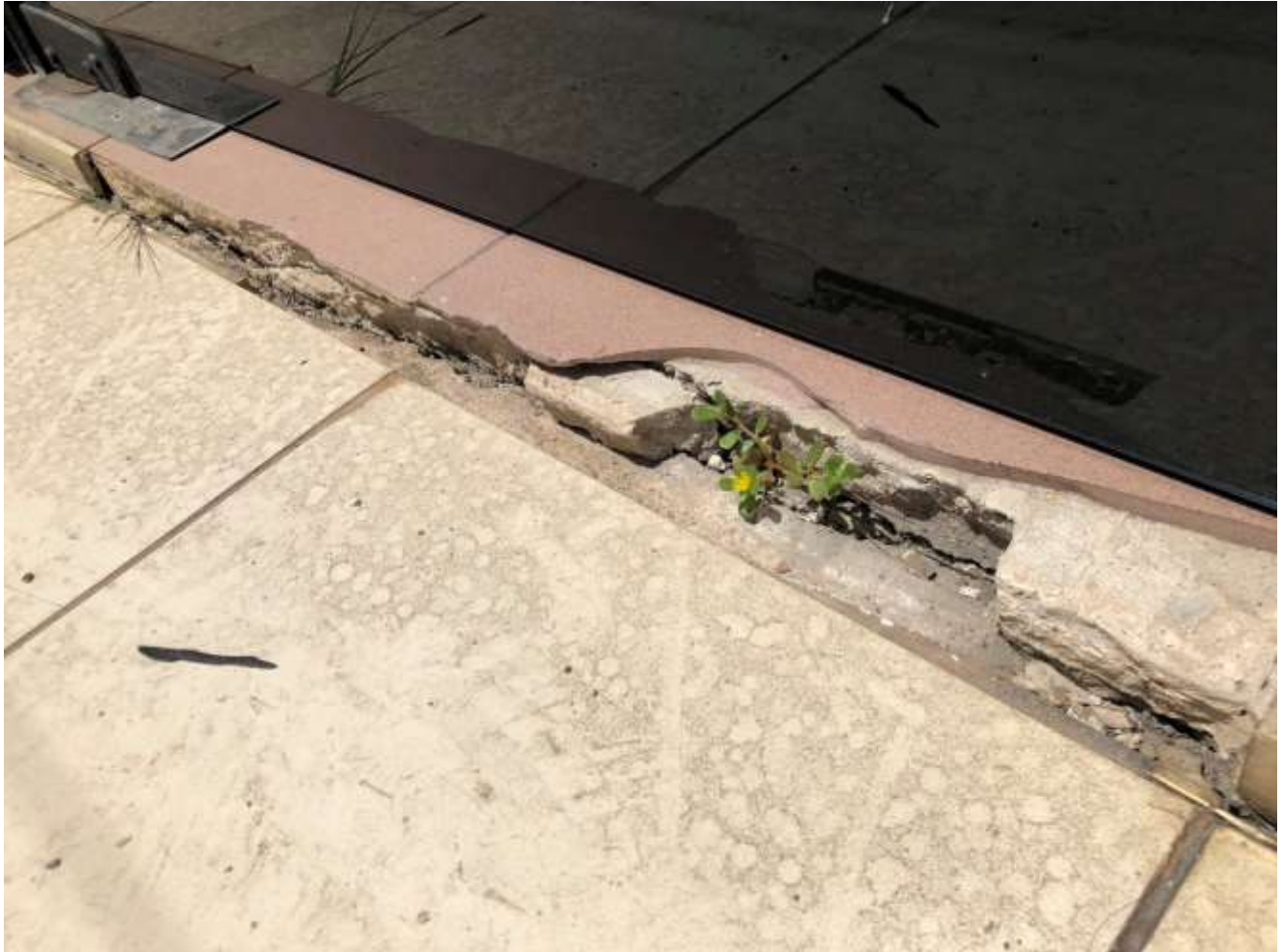
Figura 42 - Piso e rodapiso deteriorados no acesso posterior do prédio
