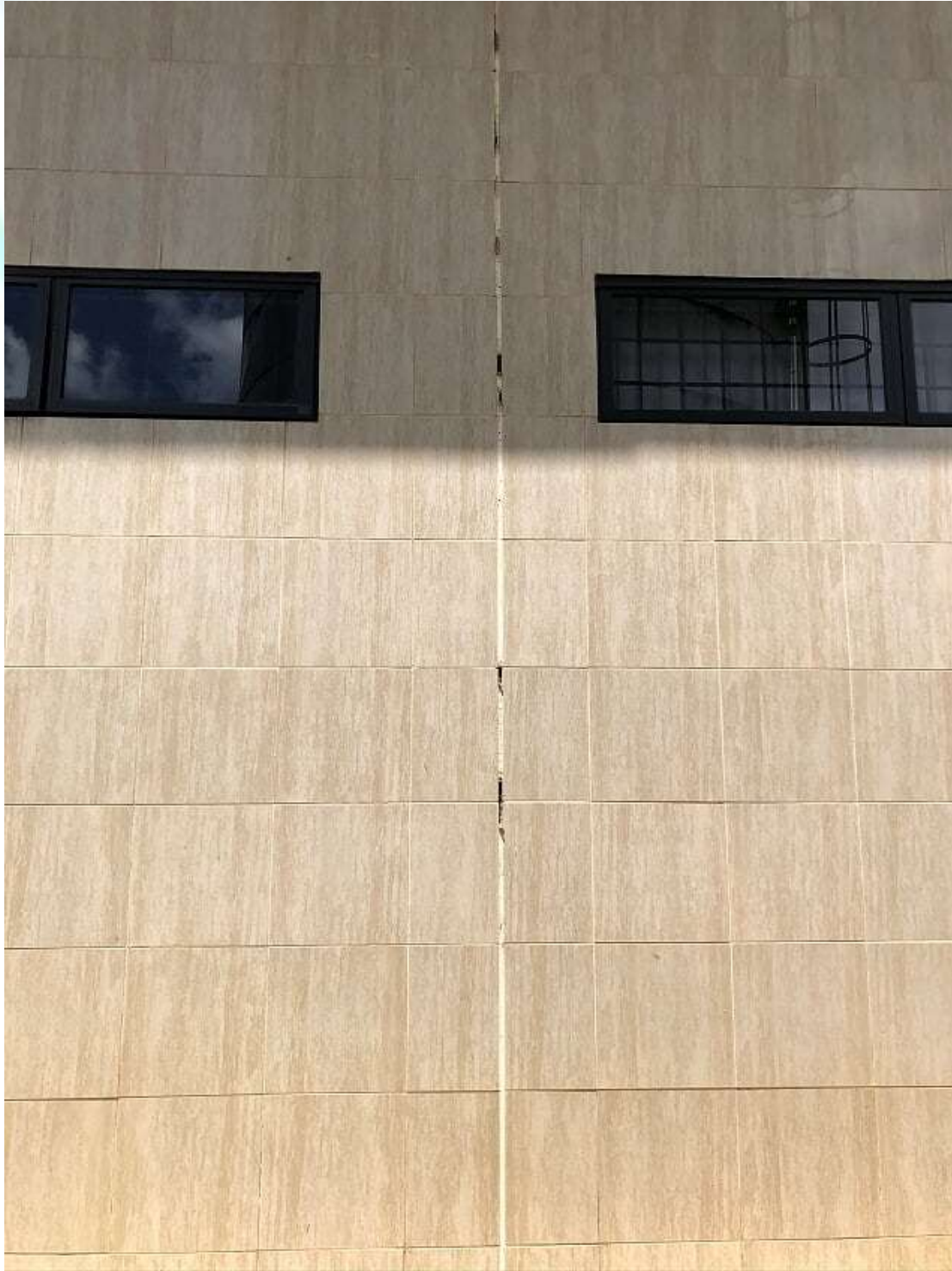
Figura 35 - Junta de dilatação deteriorada
