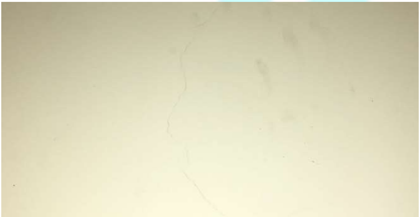
Figura 105 – Fissuras na parede
