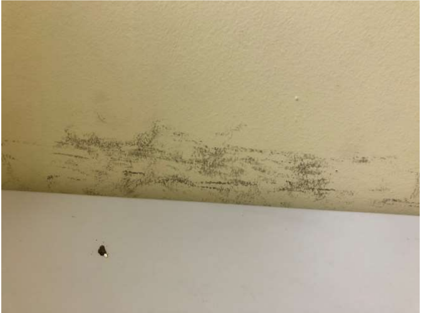
Figura 176 - Sujidades na parede
