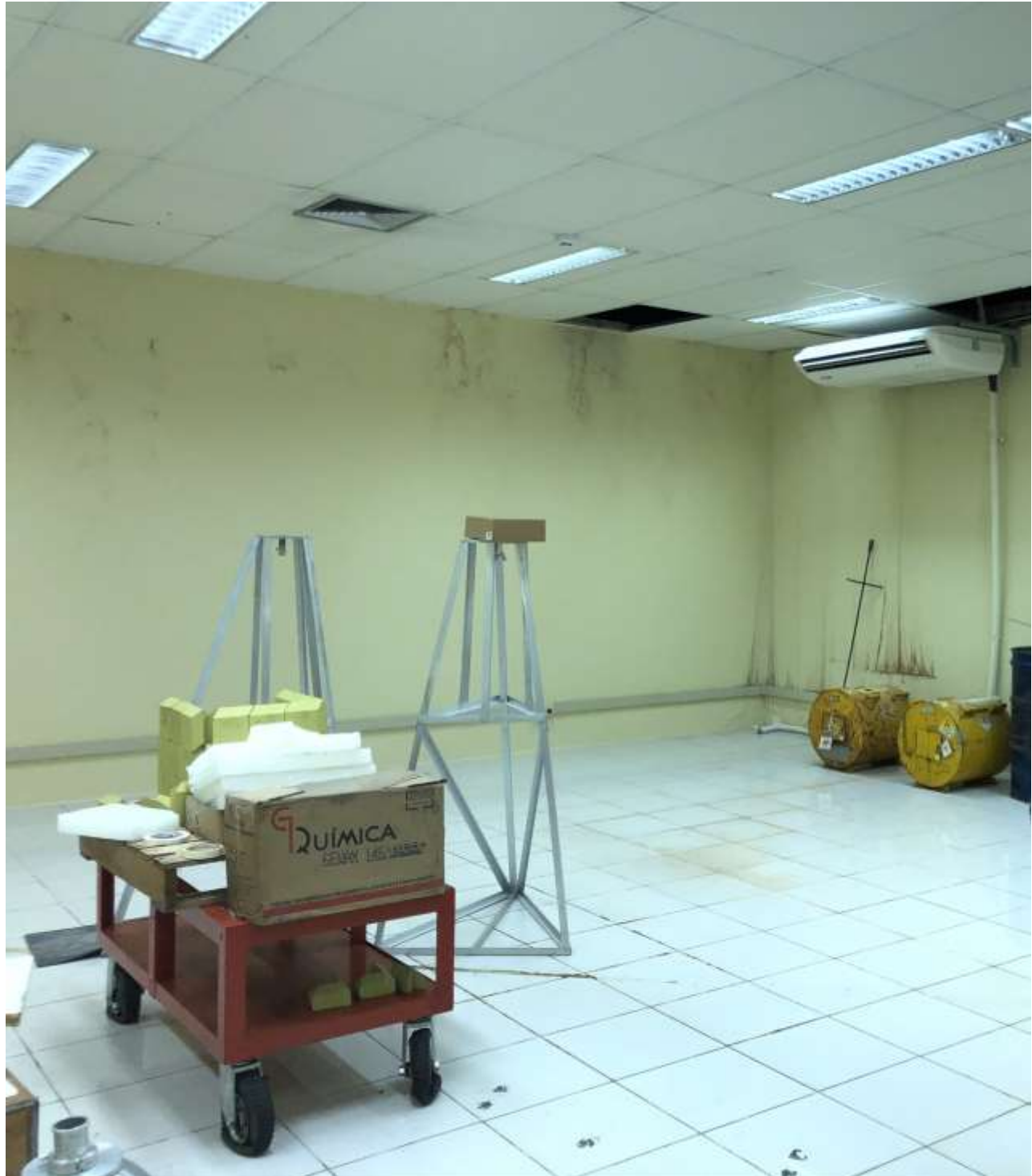
Figura 119 - Manchas de Infiltração, forro faltante e pedras de cerâmica danificadas
