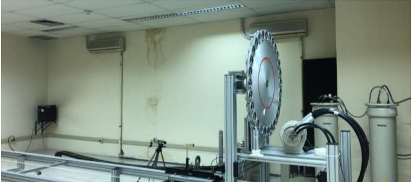
Figura 135 - Mancha de infiltração
