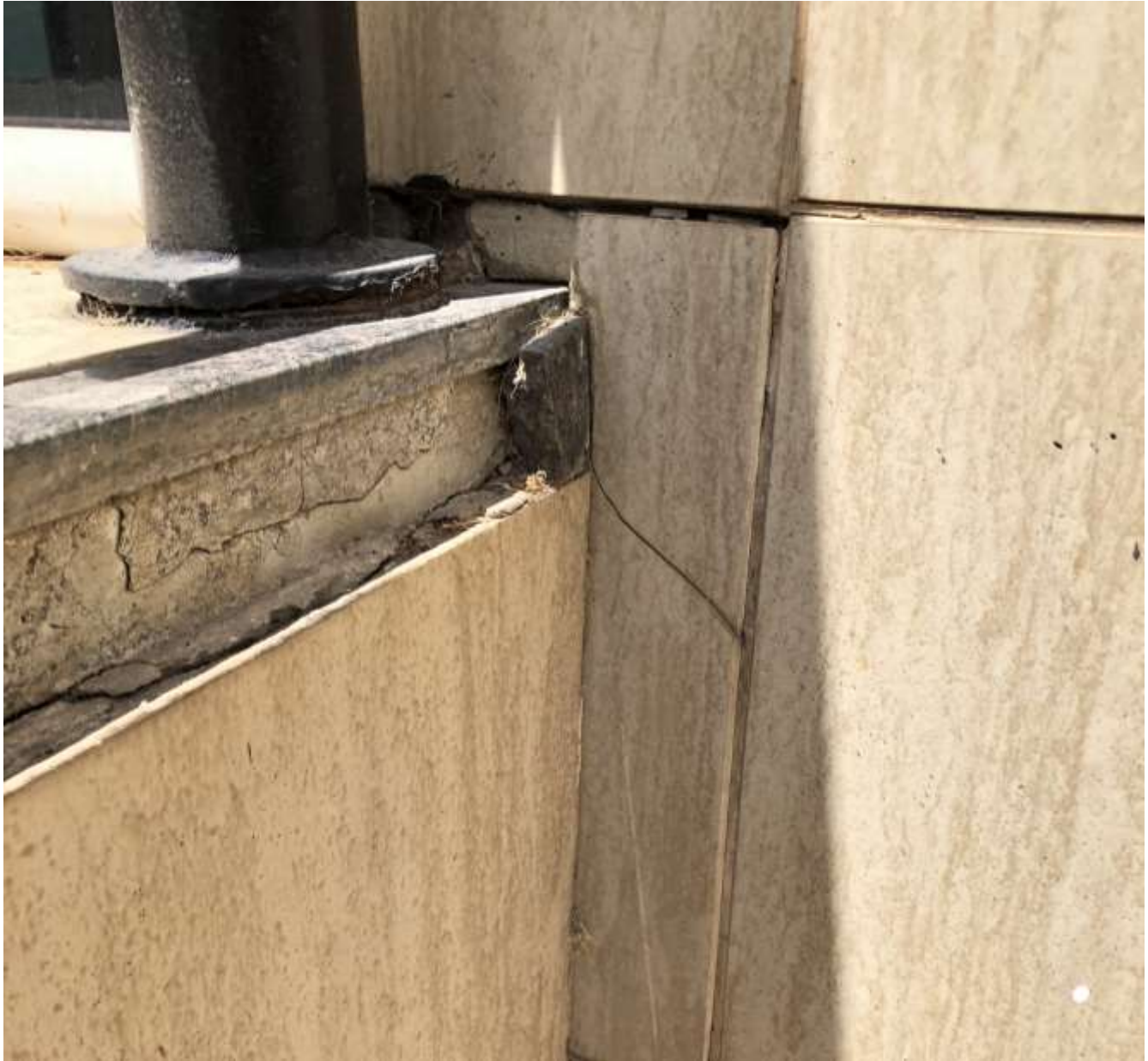
Figura 39 - Pedras cerâmicas danificadas e pedra de granito faltante
