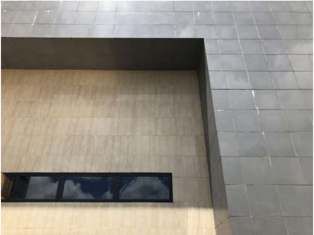
Figura 34 - Pontos de eflorescência, deslocamento e sujidades
