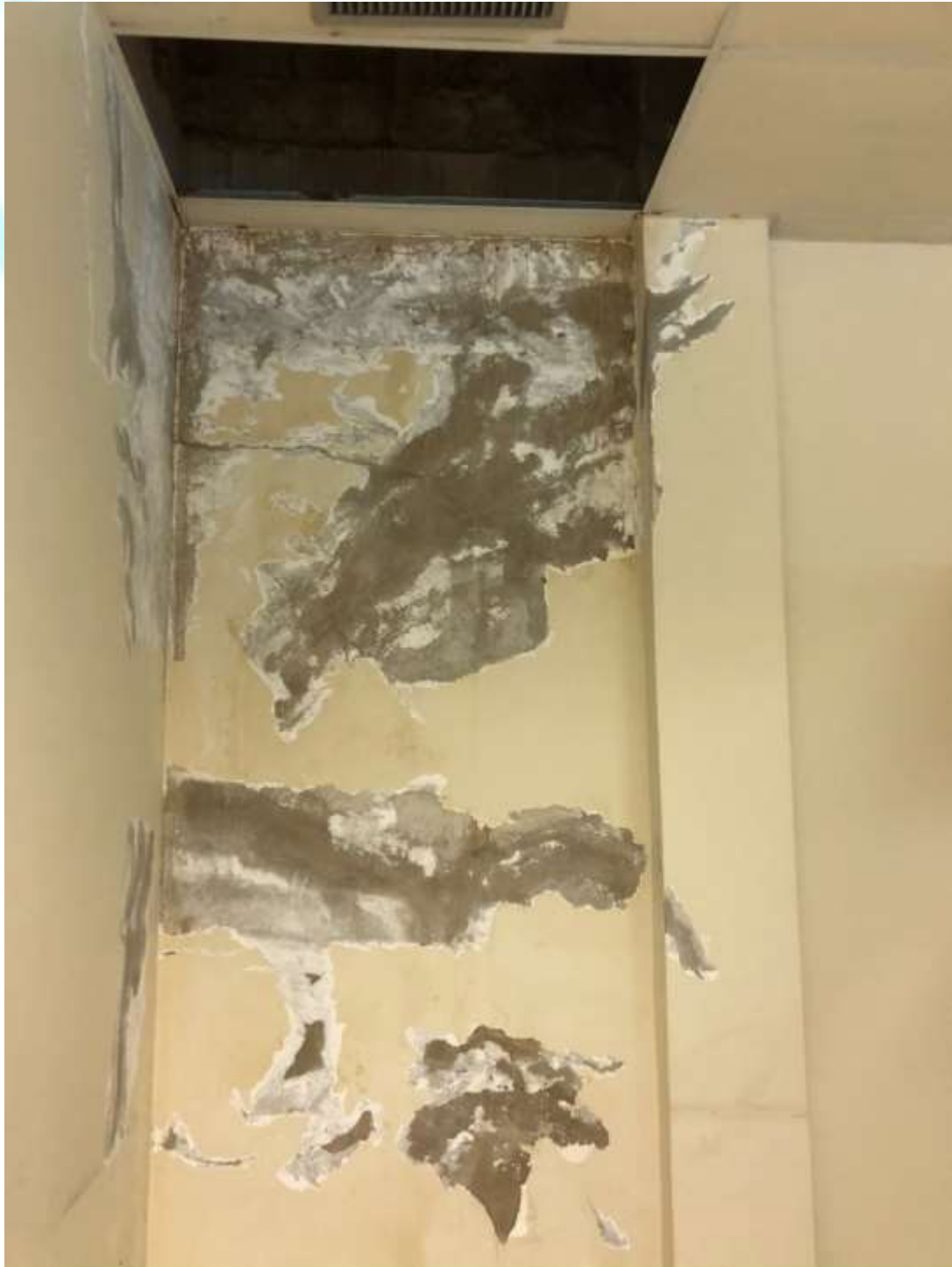
Figura 88 - Parede da fachada com pontos de infiltração e placa de forro faltante
