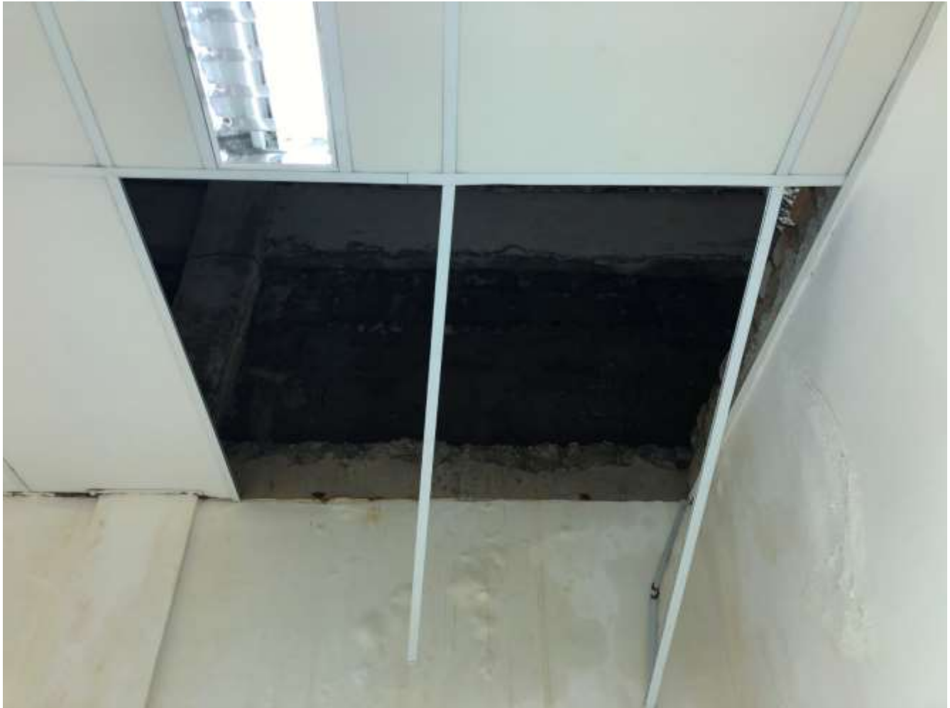
Figura 126 - Estrutura do forro danificada e placas faltantes
