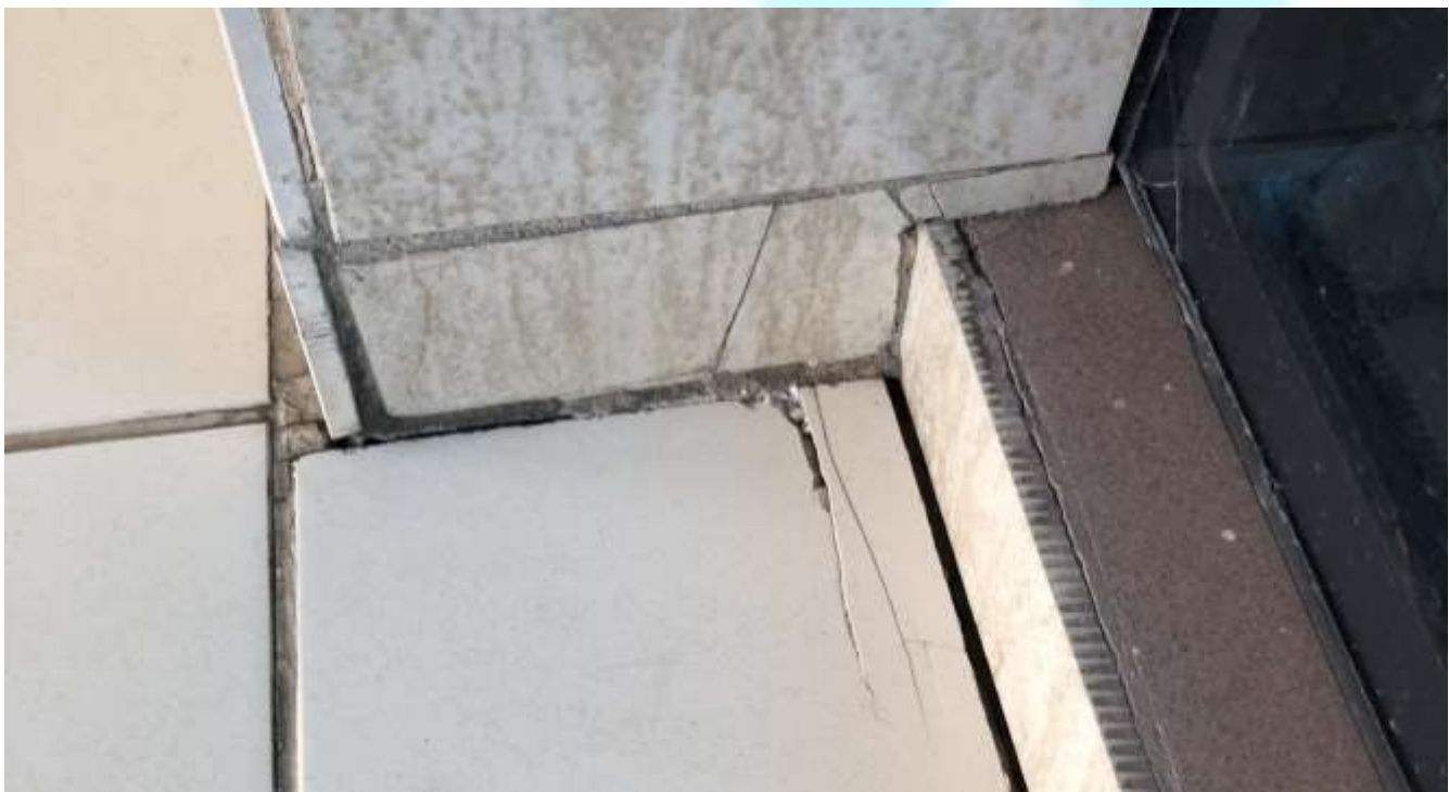
Figura 6 - Pedras do piso e rodapé danificadas
