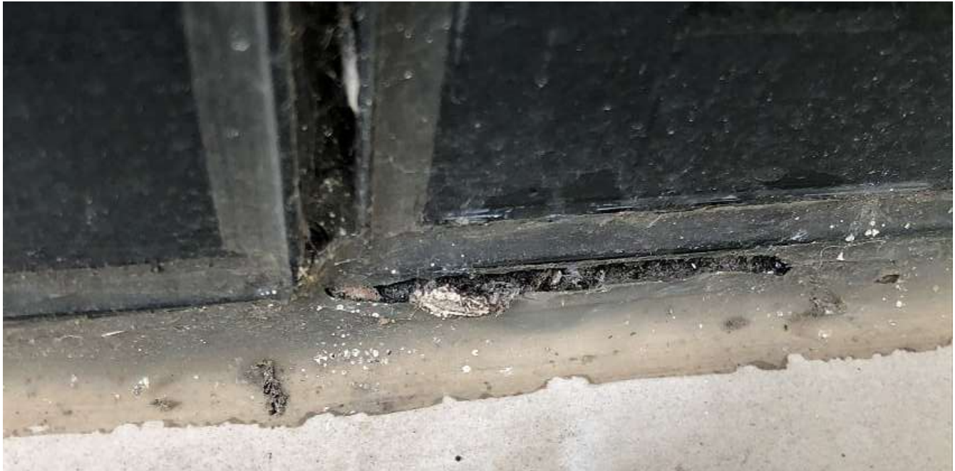
Figura 10 - Silicone para vedação das esquadrias danificado
