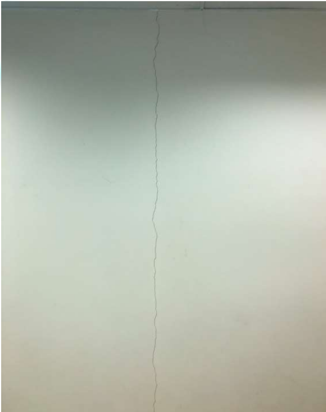
Figura 86 - Fissura na parede
