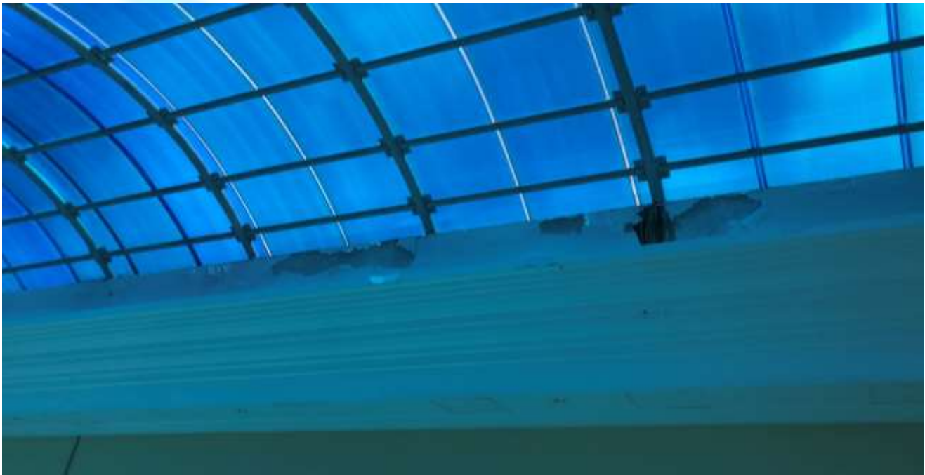
Figura 81 - Infiltrações na platibanda
