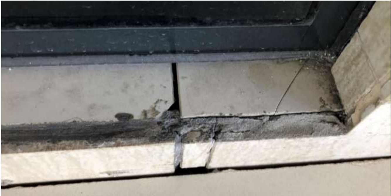
Figura 5 – Cerâmicas quebradas e sem rejunte
