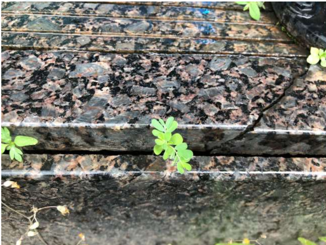
Figura 17 - Rejunte faltante e pedra quebrada
