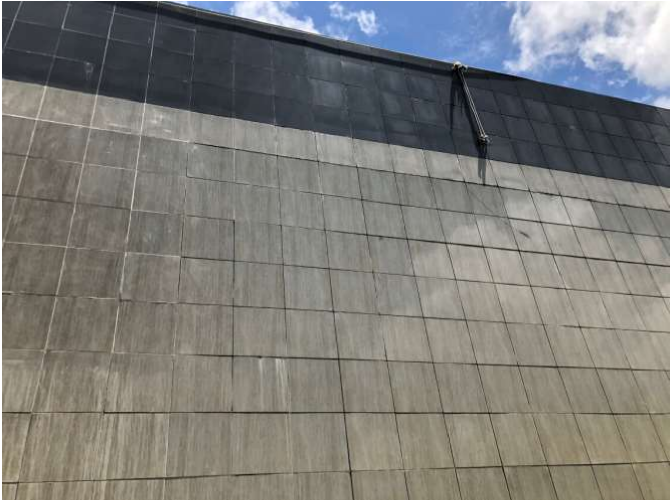
Figura 56 - Revestimentos com sujidades e eflorescência
