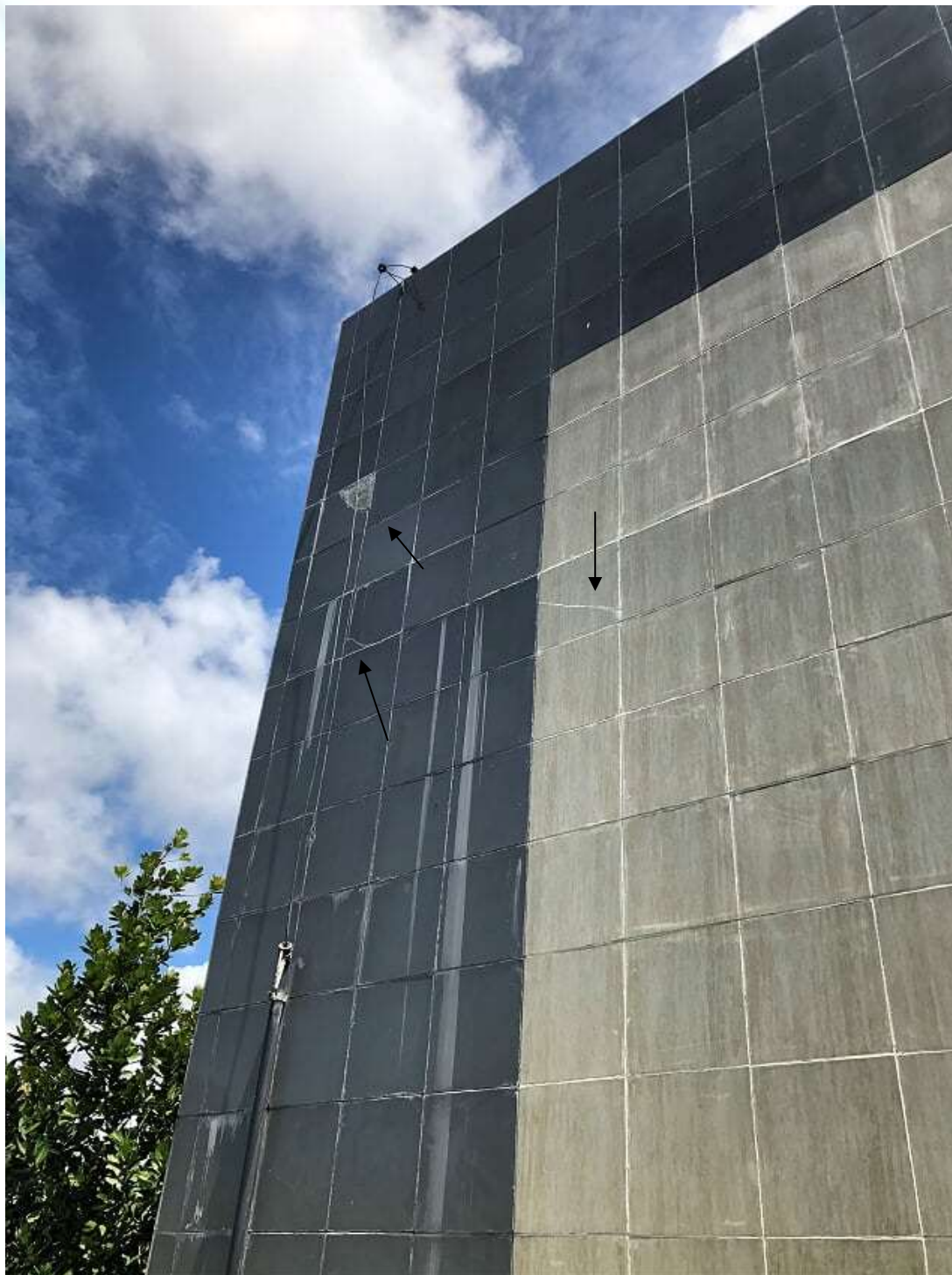
Figura 57 - Pedras quebradas e pontos de eflorescência
