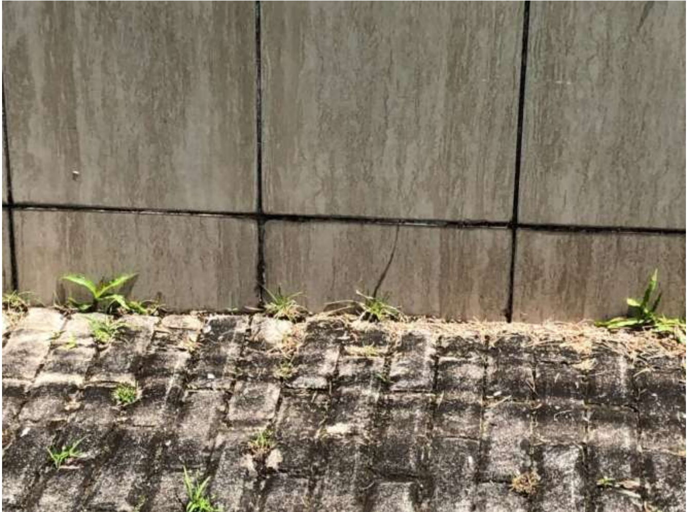
Figura 58 - Pedra quebrada, sujidades e rejuntas danificadas
