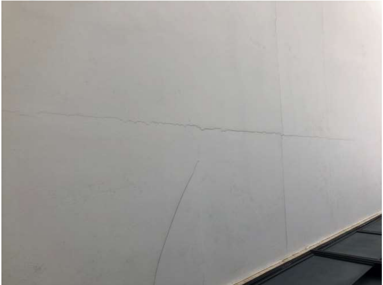
Figura 80 - Fissuras no forro de gesso
