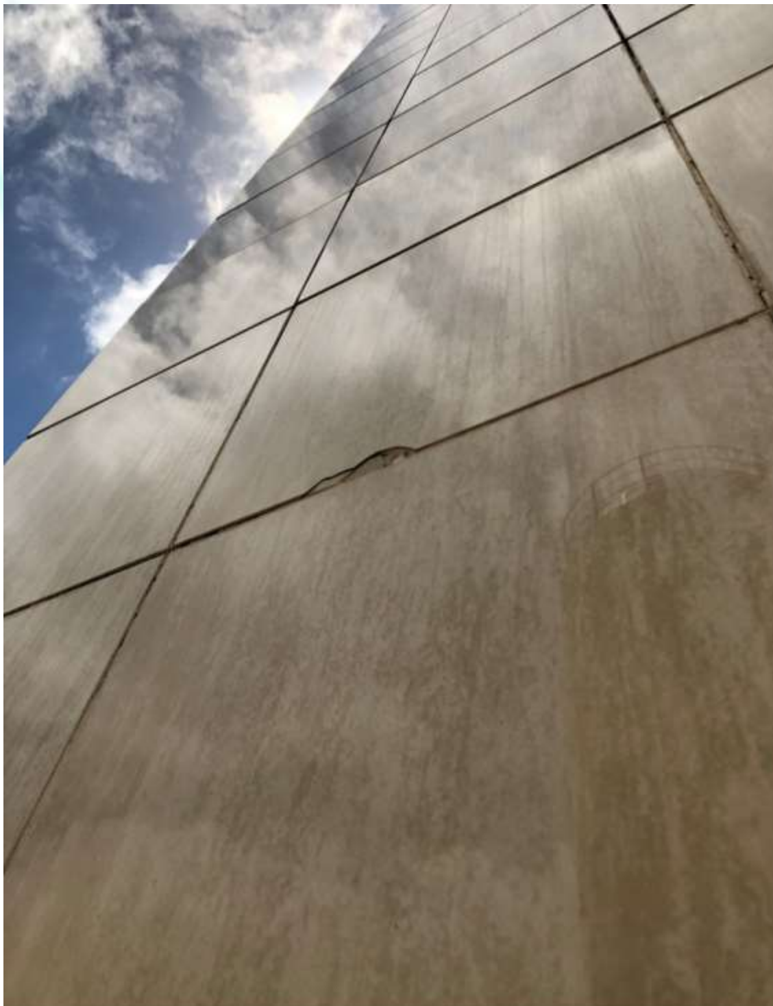
Figura 46 - Revestimento quebrado e rejuntas danificadas
