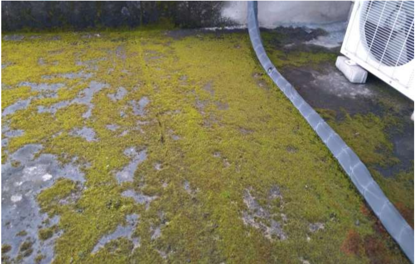
Figura 73 - Laje coberta de lodo
