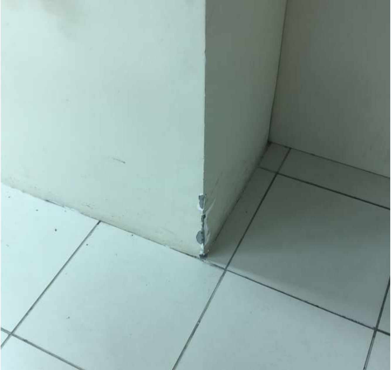
Figura 106 – Revestimento de parede danificado
