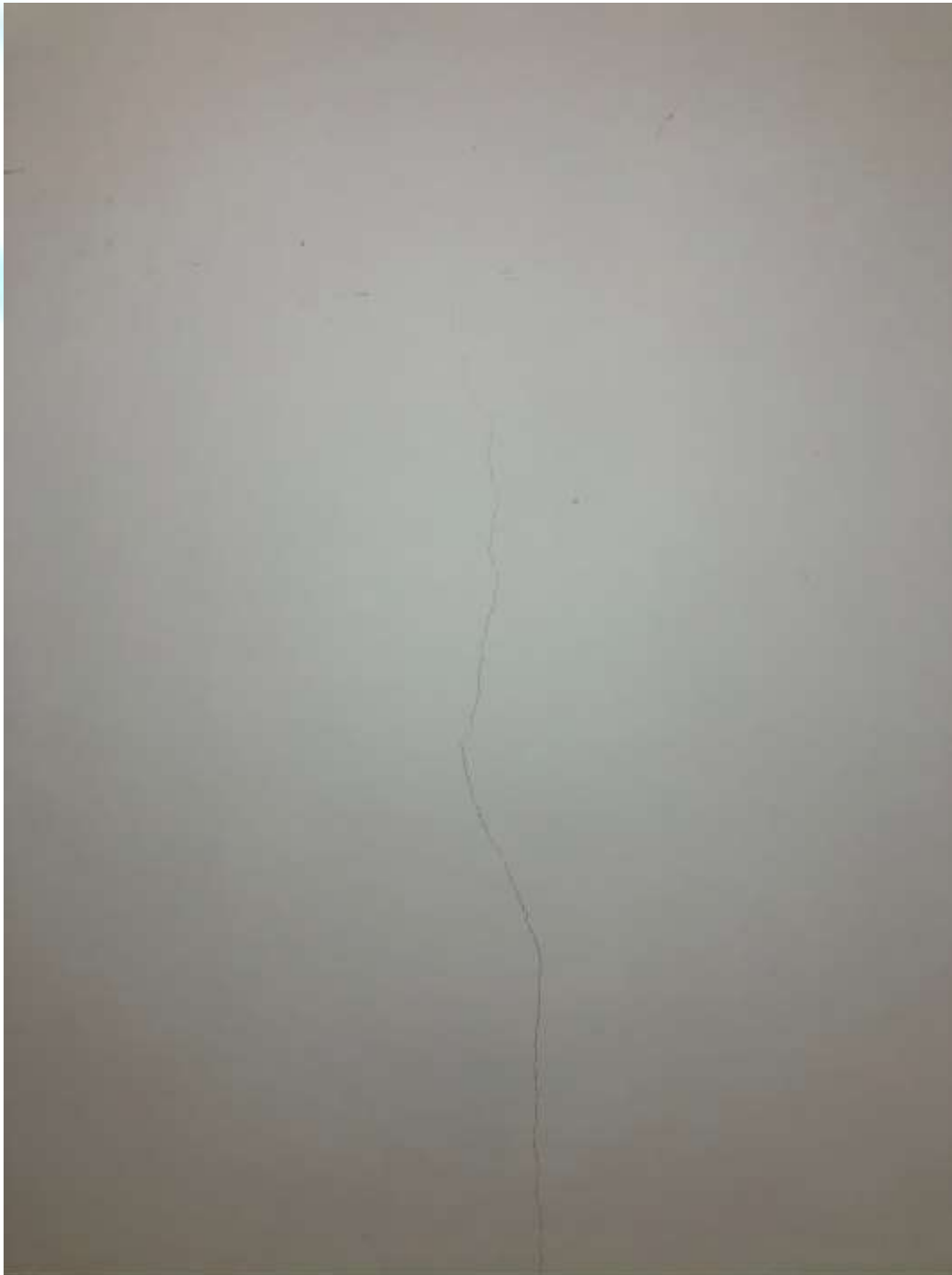
Figura 123 - Fissura vertical na parede
