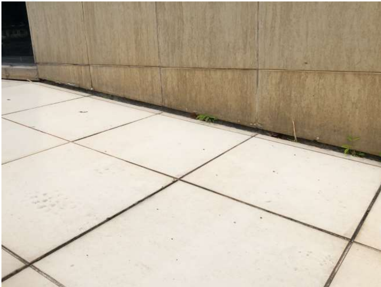
Figura 47 - Ausência de rejuntamento da parede com piso
