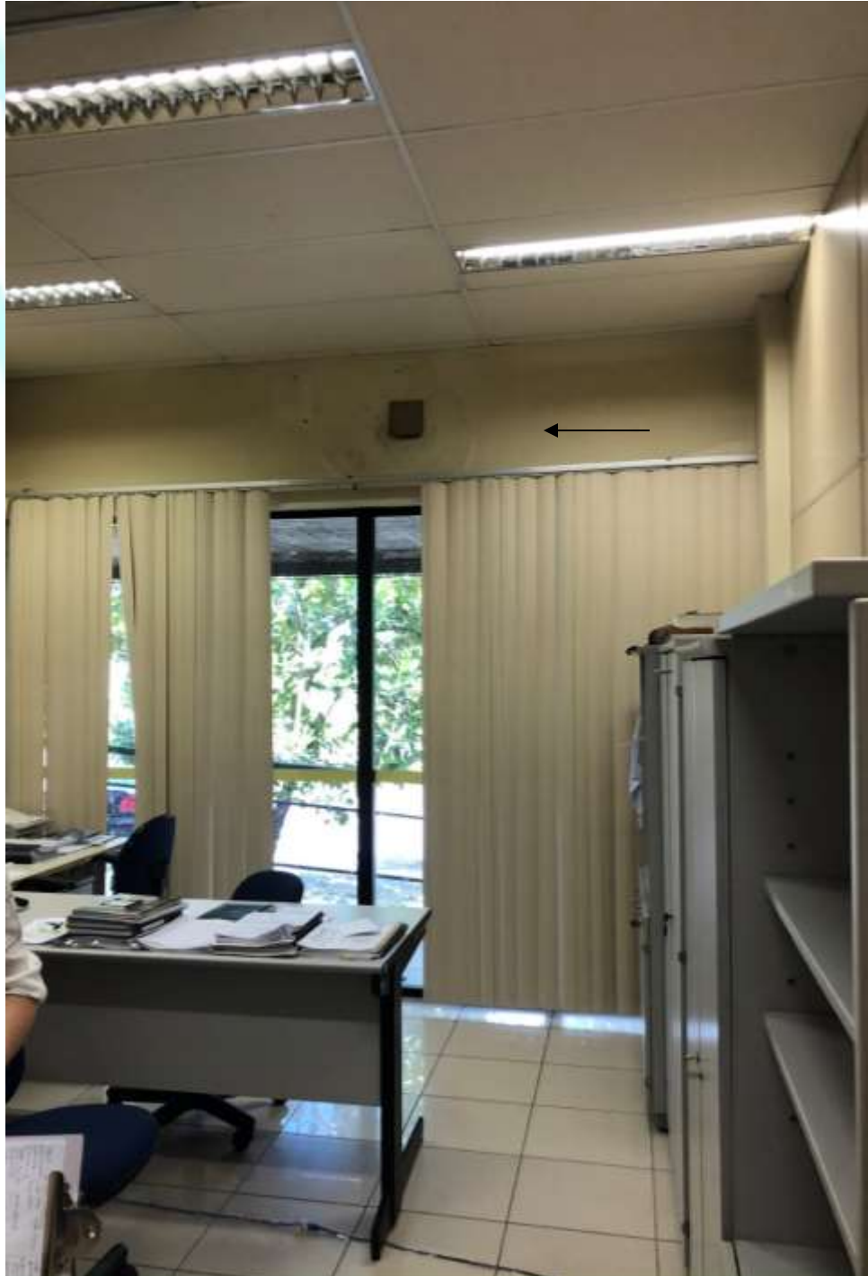
Figura 149 - Pintura da parede danificada
