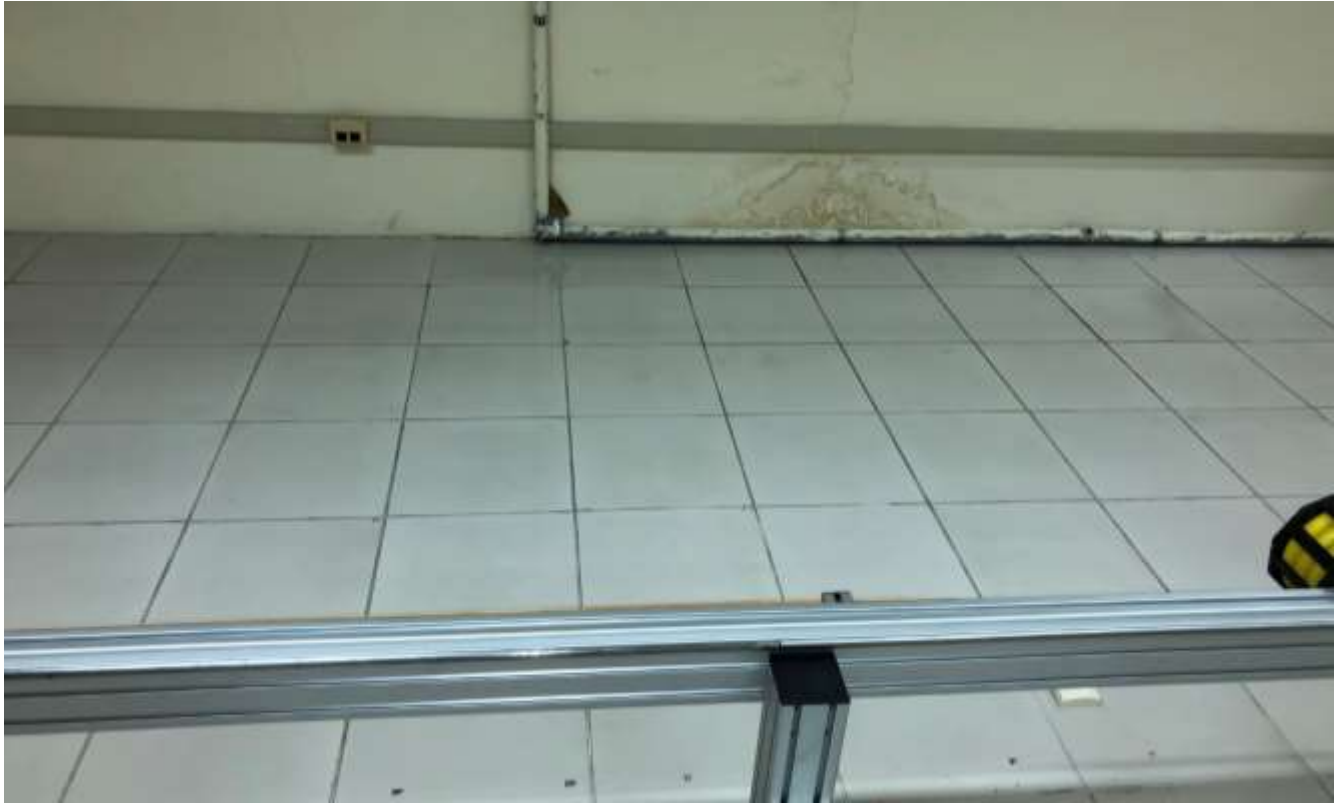
Figura 136 - Mancha de infiltração e piso danificado
