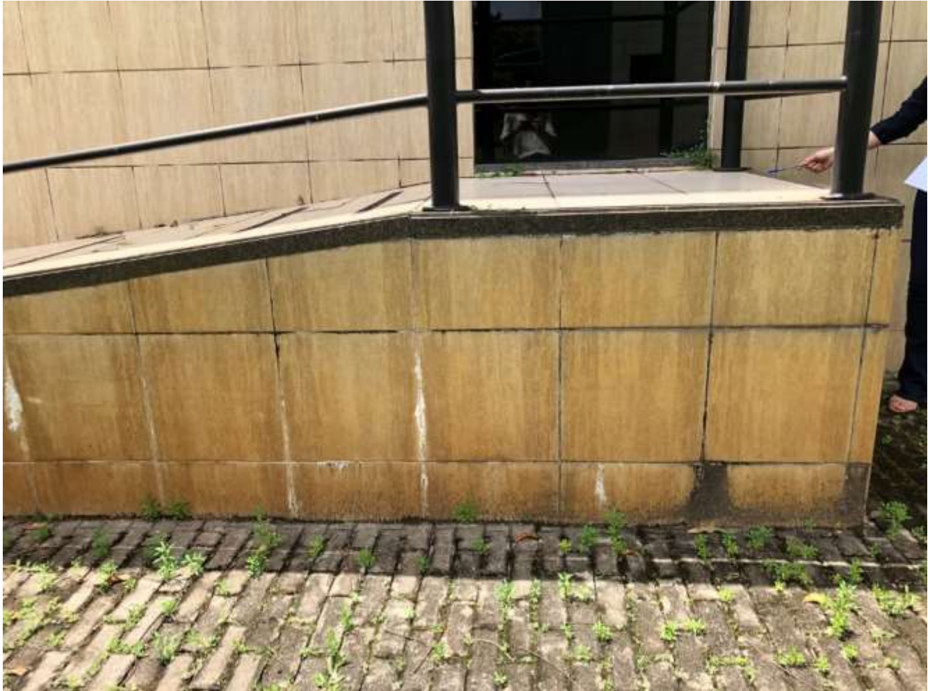
Figura 32 - Sujidades e pontos de eflorescência
