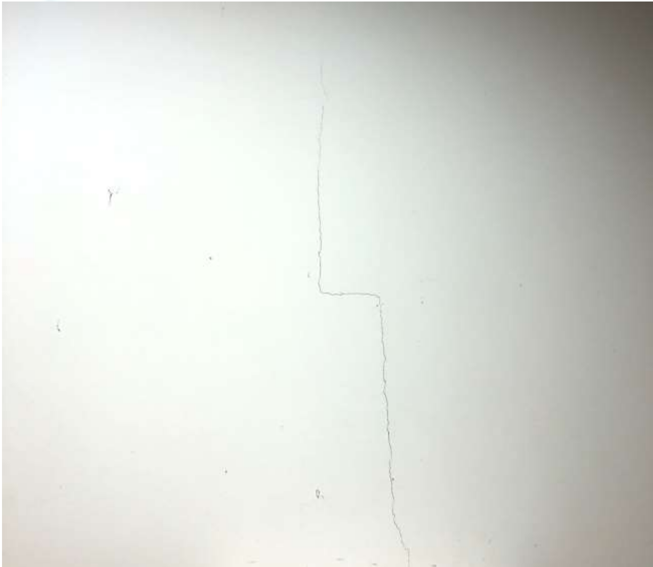
Figura 99 - Fissura na parede
