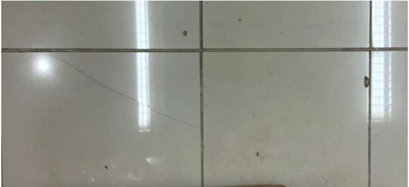
Figura 116 - Pedras quebradas e fissuradas
