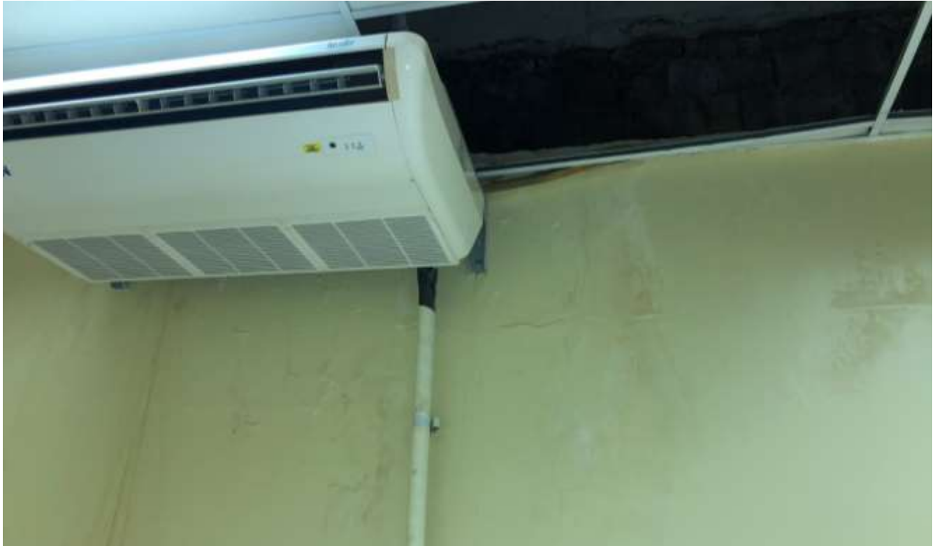
Figura 120 - Fissuras, infiltração e forro faltante
