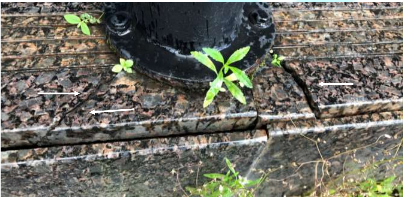
Figura 16 – Revestimento da escada quebradas
