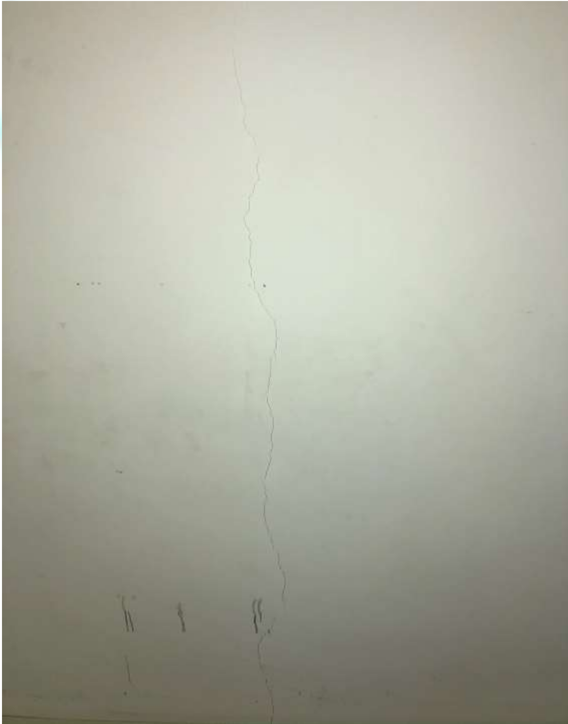
Figura 133 - Fissura e sujidades
