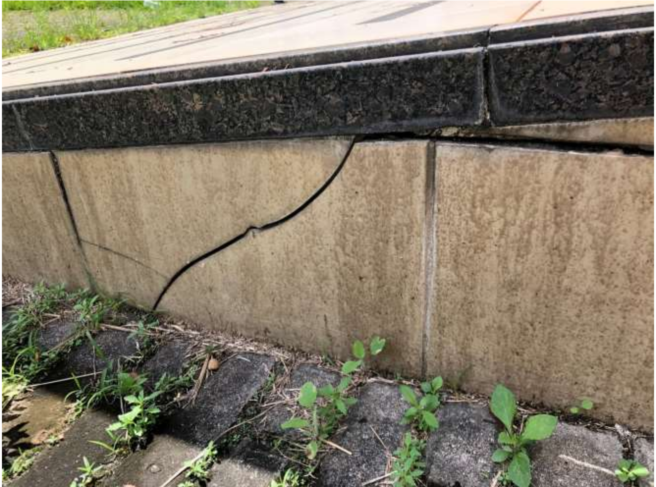
Figura 40 - Lateral da rampa traseira deteriorada
