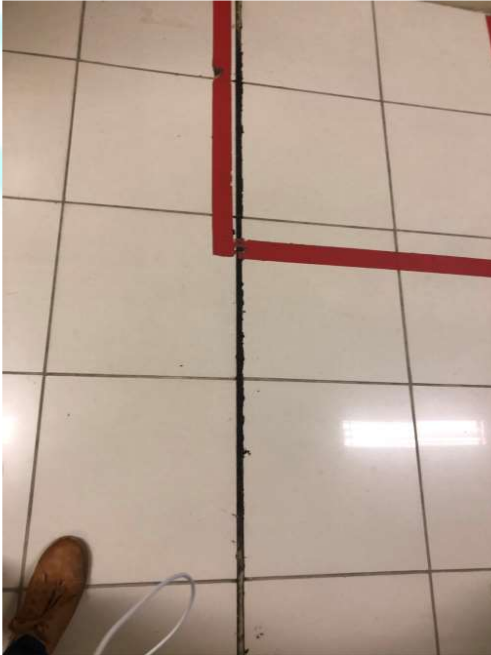
Figura 143 - Junta de dilatação deteriorada
