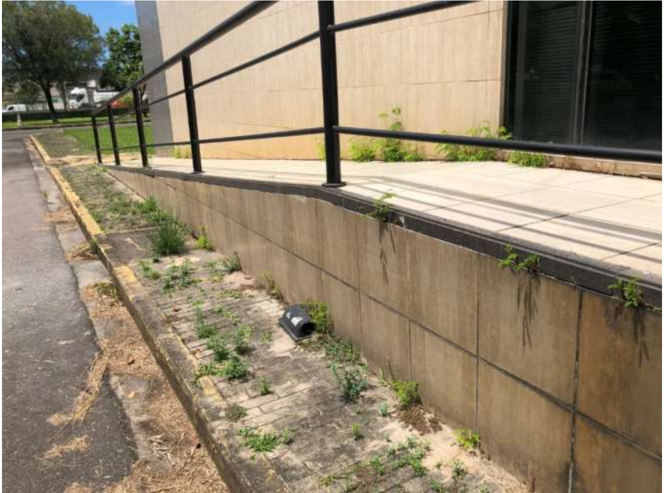
Figura 50 - Sujidades na lateral da rampa com presença de plantas nos elementos
