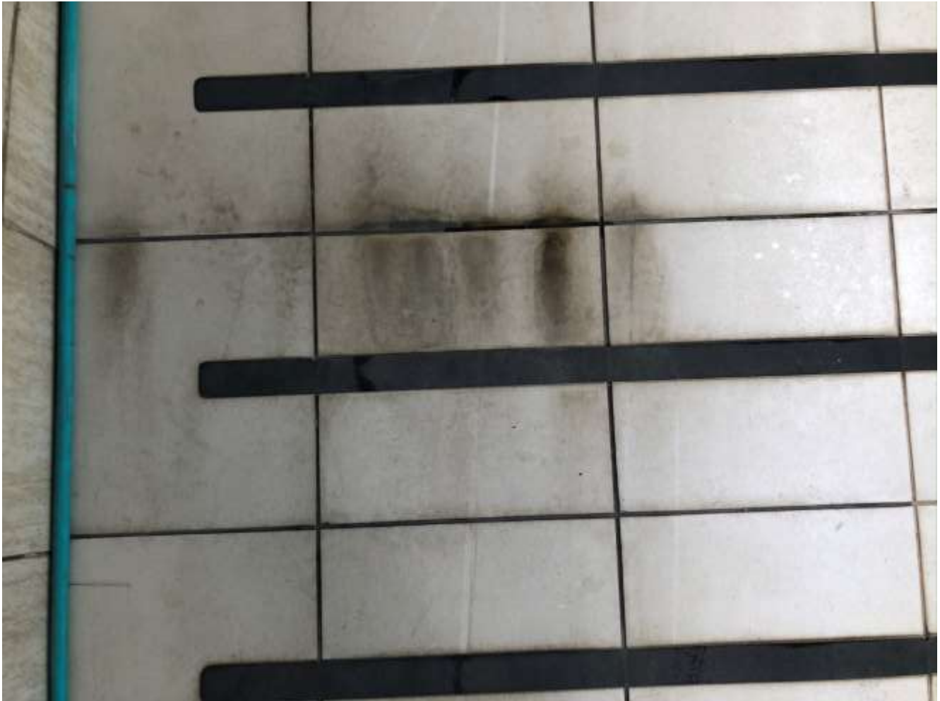
Figura 24 - Manchas no piso da rampa provenientes de infiltrações na laje
