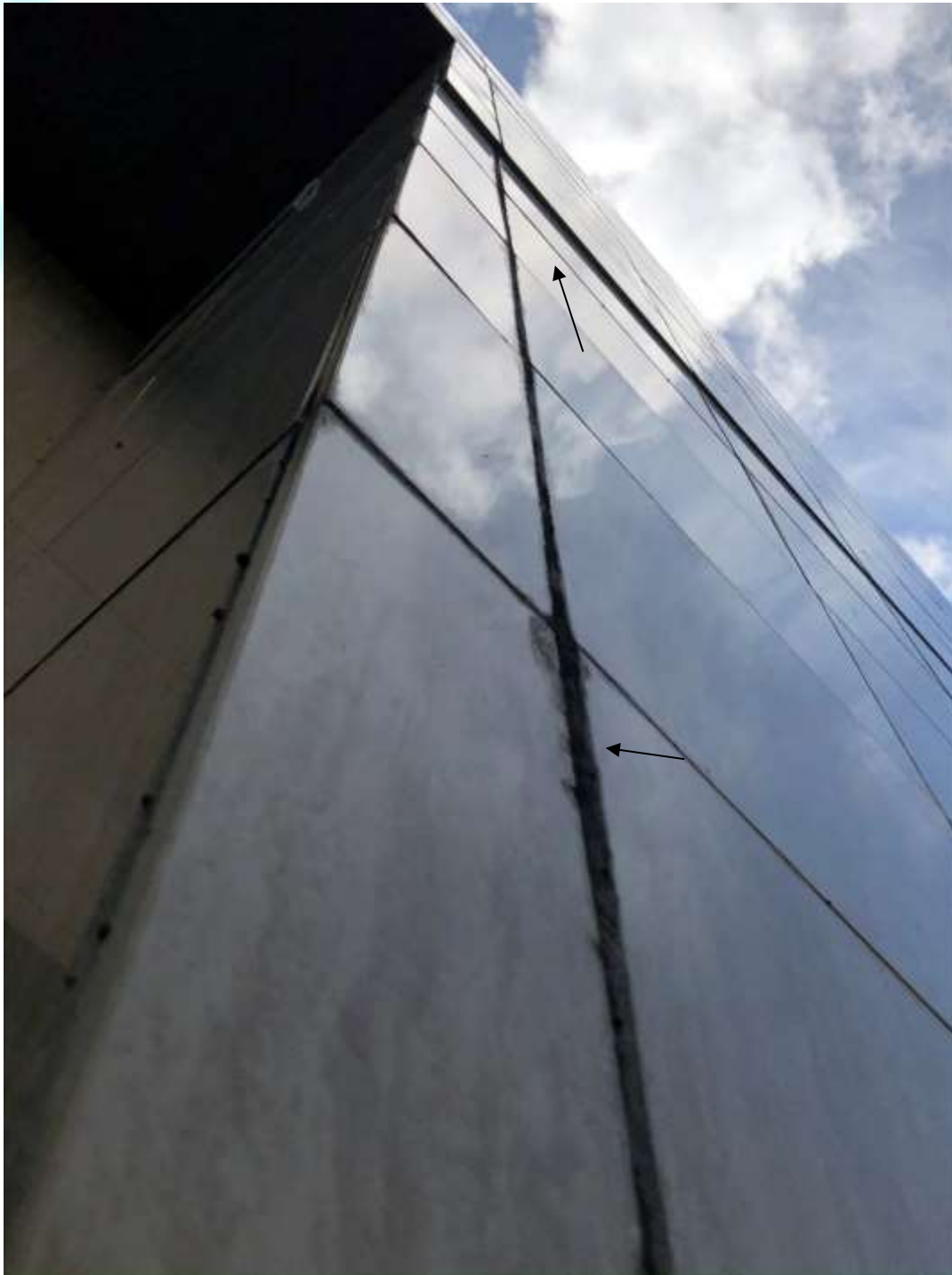
Figura 1 - Deslocamento e sujidades
