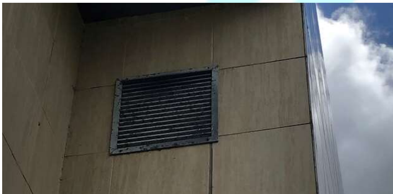
Figura 13 - Grelha oxidada necessitando de pintura
