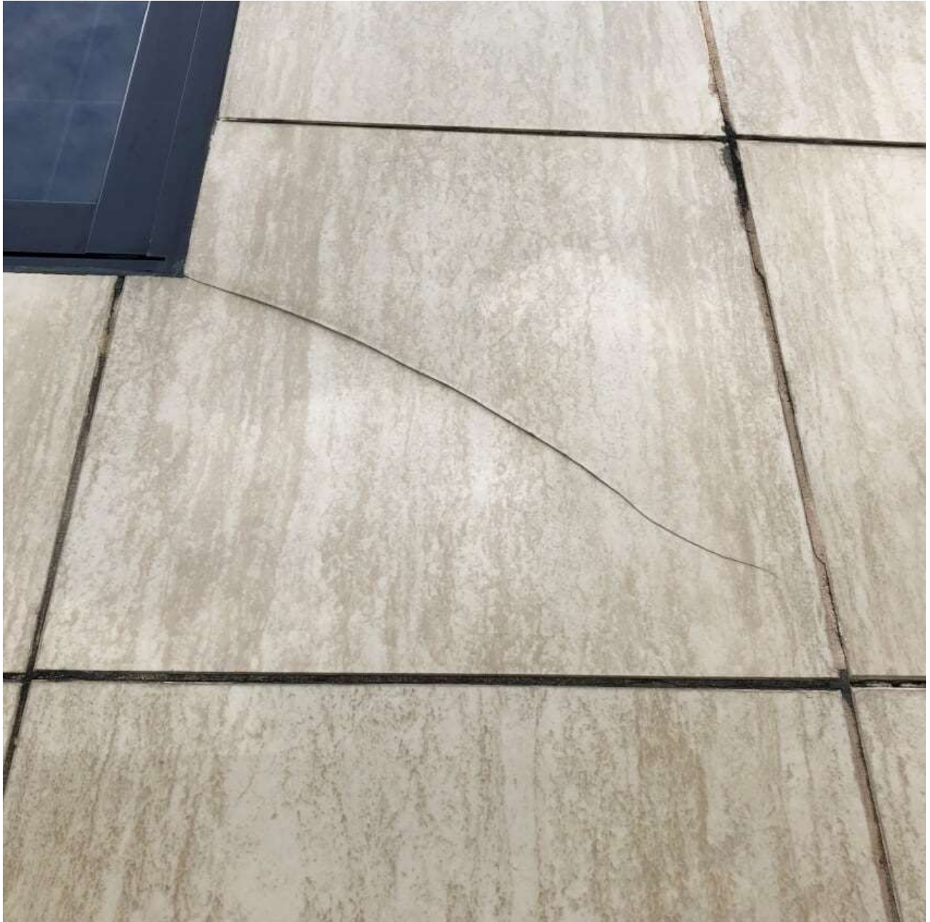
Figura 28 - Cerâmica quebrada, sujidades e pontos de eflorescência
