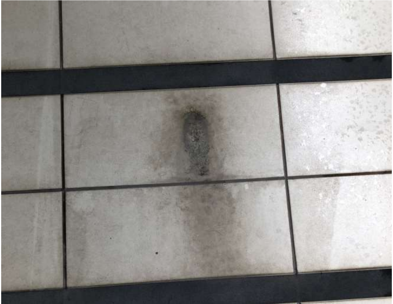
Figura 25 - Manchas no piso da rampa provenientes de infiltrações na laje
