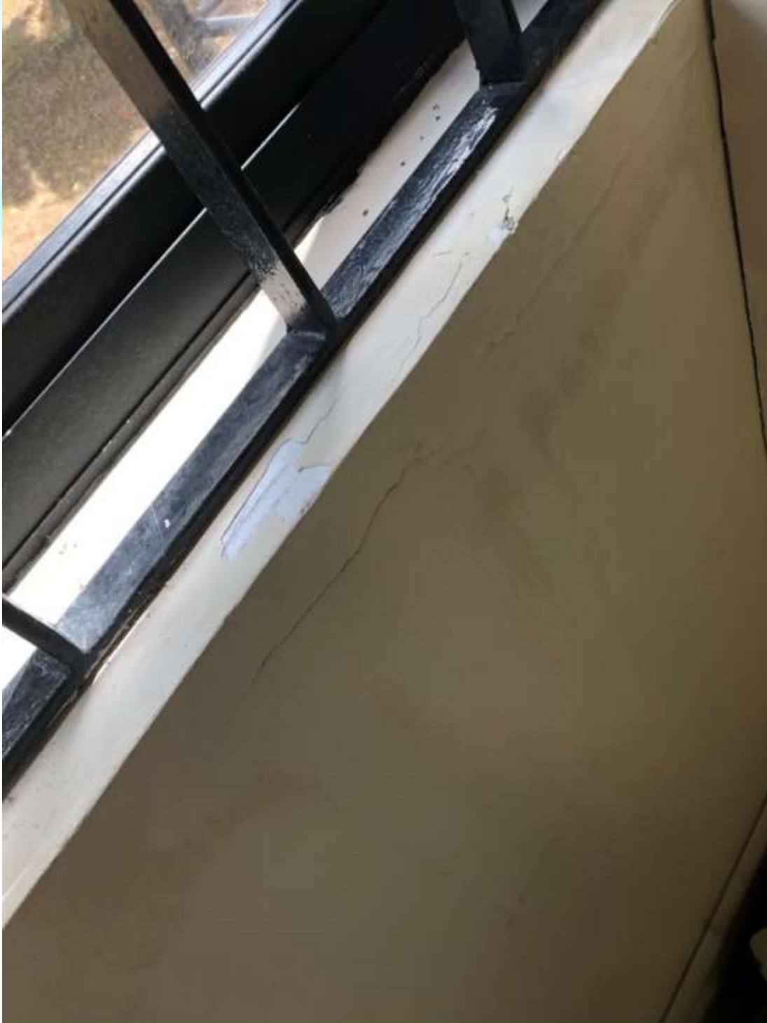
Figura 156 - Ponto de infiltração na janela
