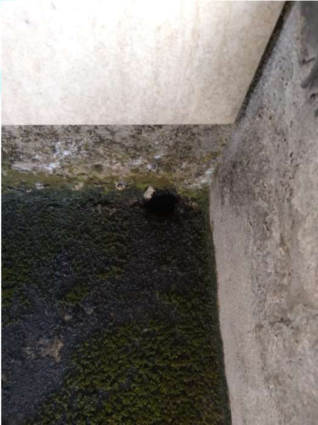
Figura 76 - Ralo entupido por excesso de lodo
