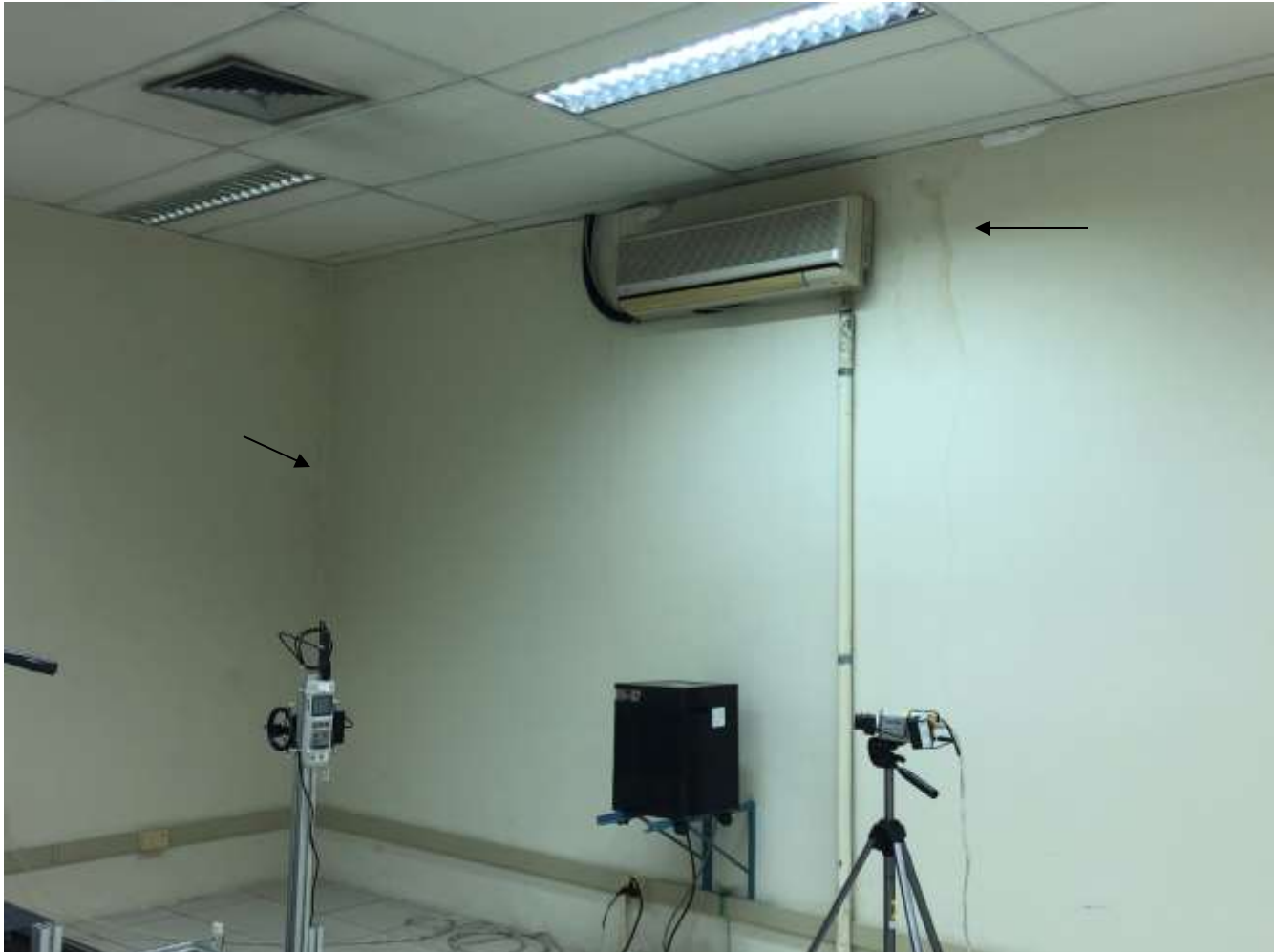
Figura 132 - Fissura e manchas de infiltração
