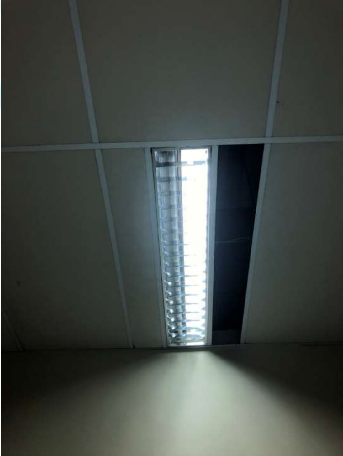
Figura 173 - Placa de forro danificada
