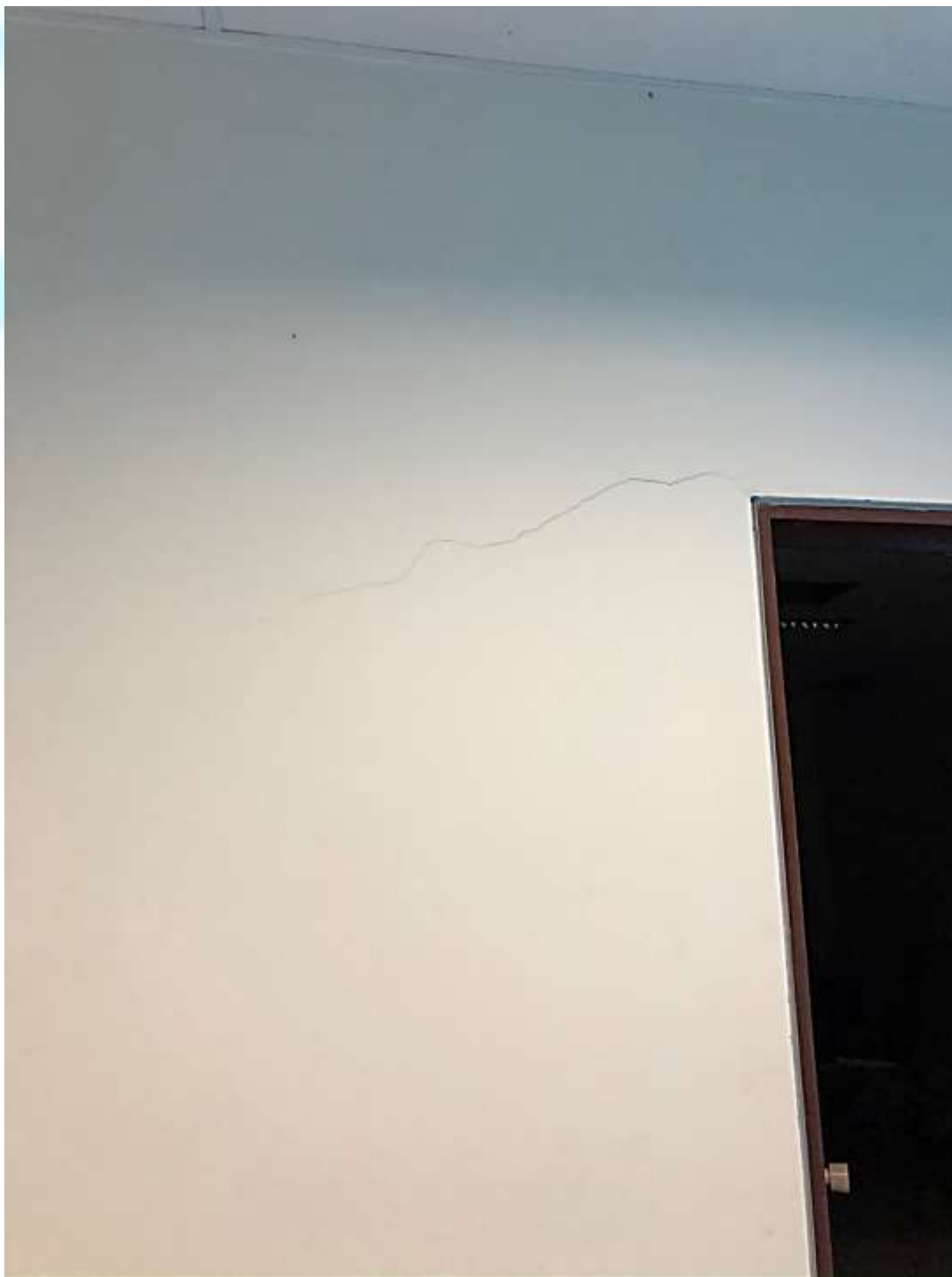
Figura 93 - Fissura na parede
