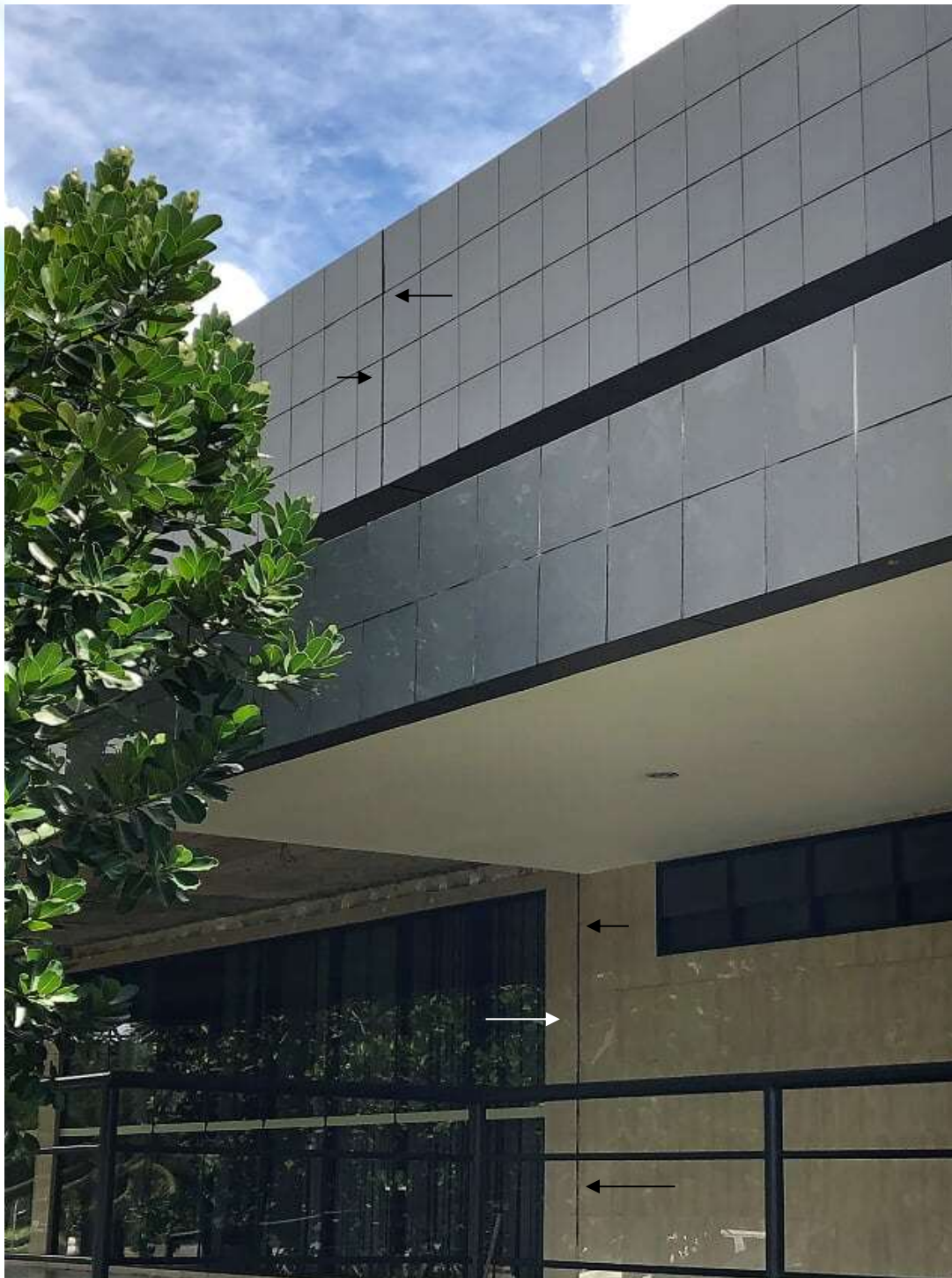
Figura 14 - Junta de dilatação da fachada desgastada
