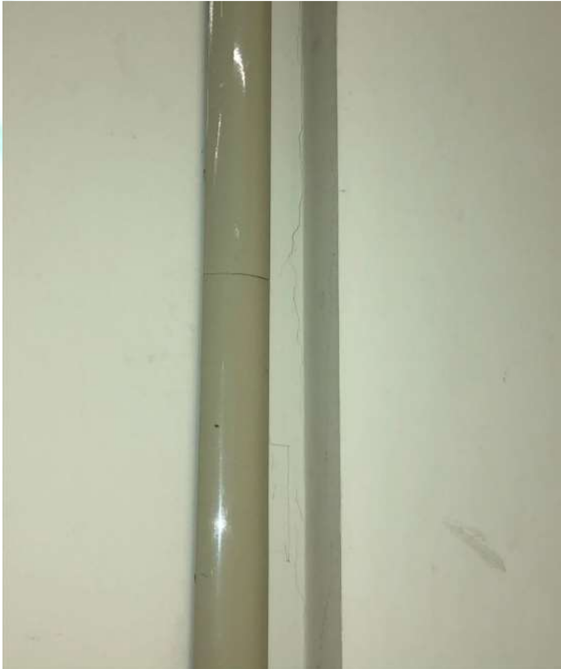
Figura 118 – Fissuras na parede
