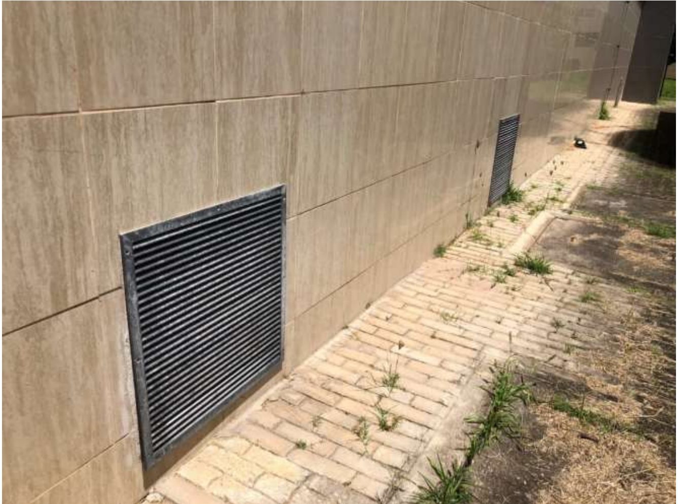
Figura 53 - Grelhas deterioradas necessitando de nova pintura
