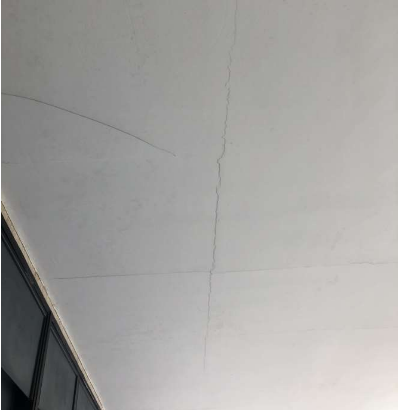
Figura 191 – Forro com fissuras
