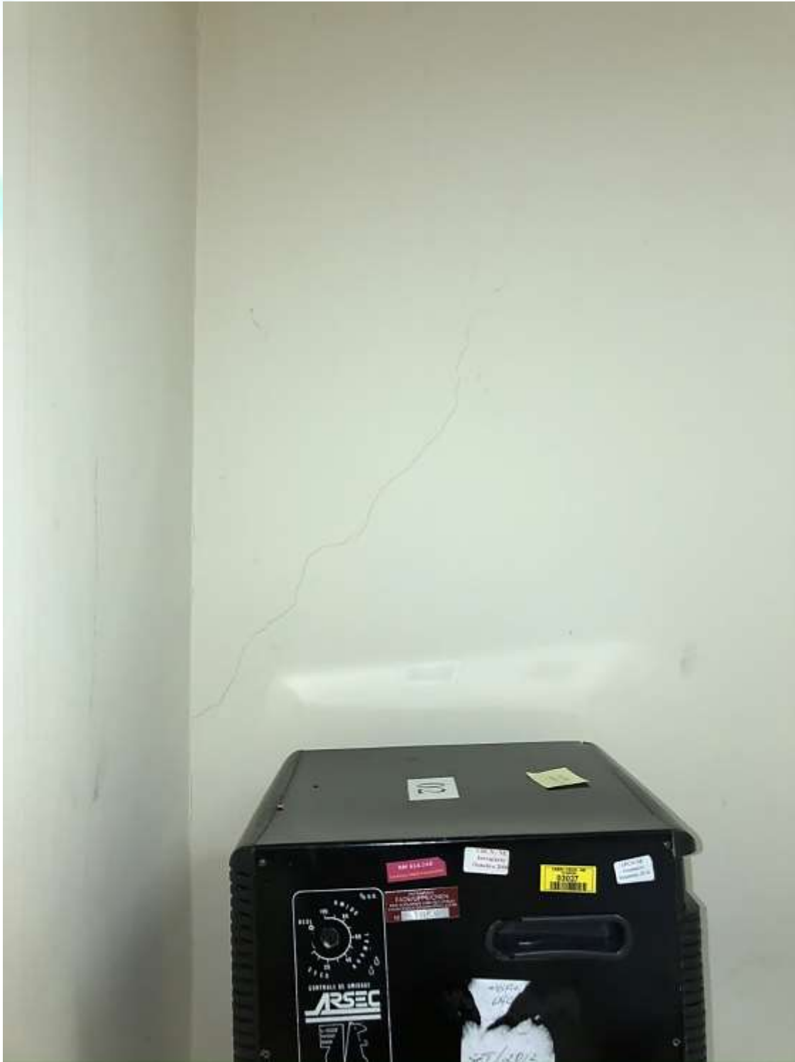
Figura 130 - fissura na parede
