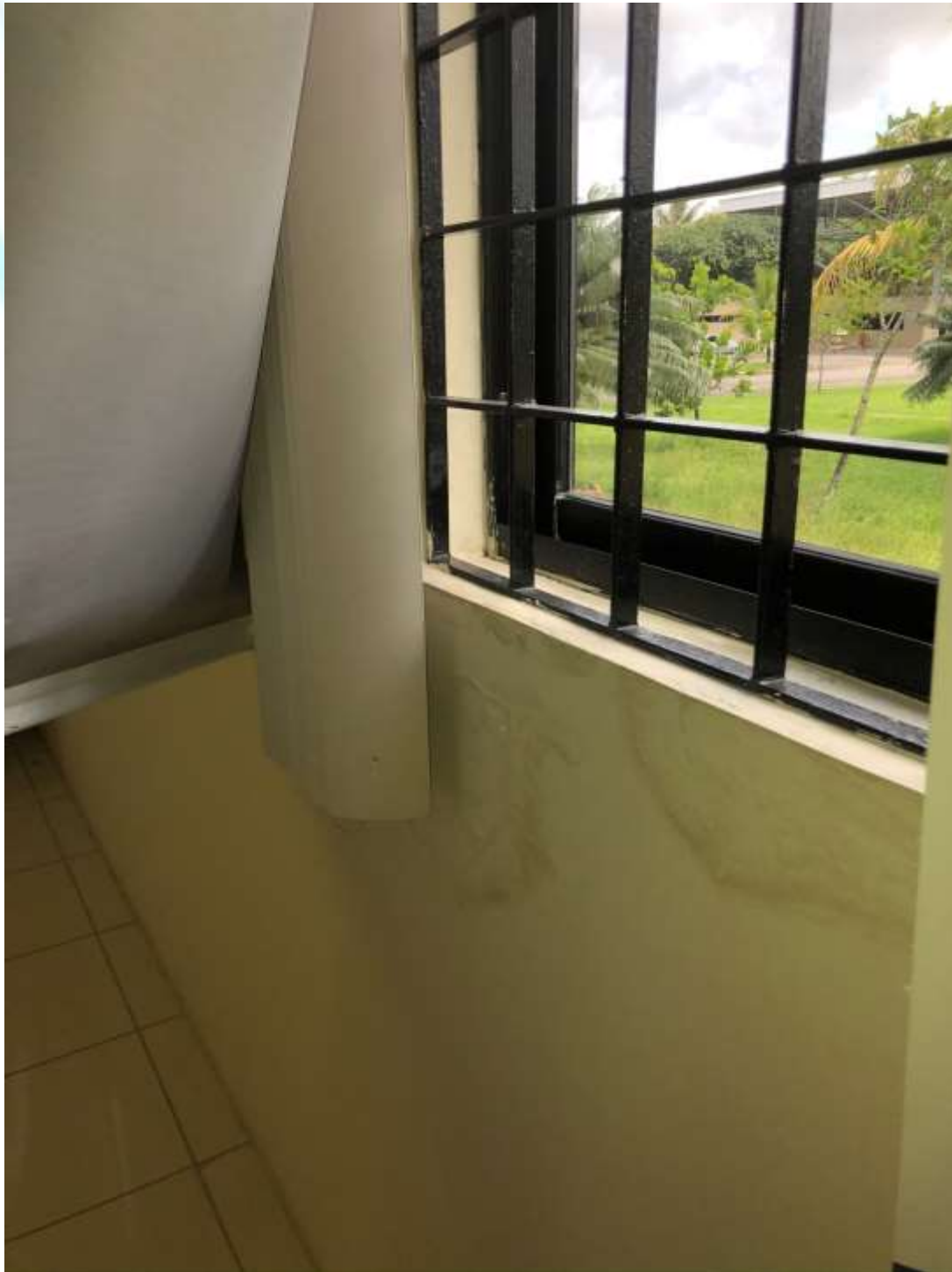
Figura 154 - Marcas de infiltração na janela
