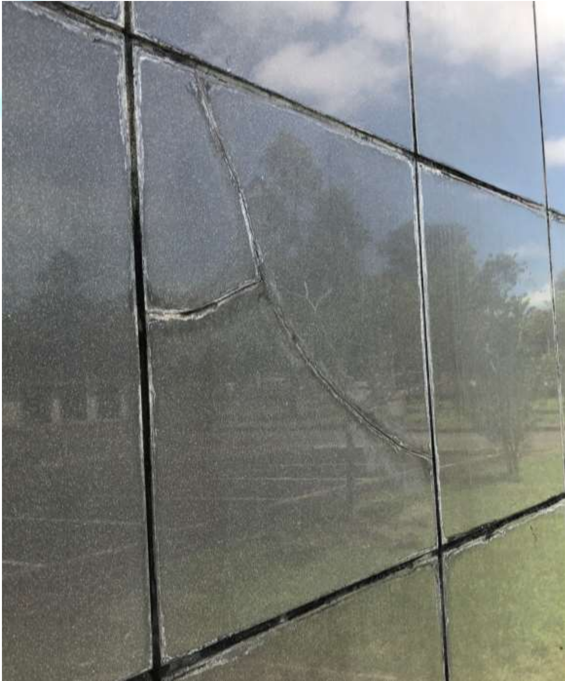
Figura 7 - Pedra quebrada, rejunte danificado e pontos de eflorescência
