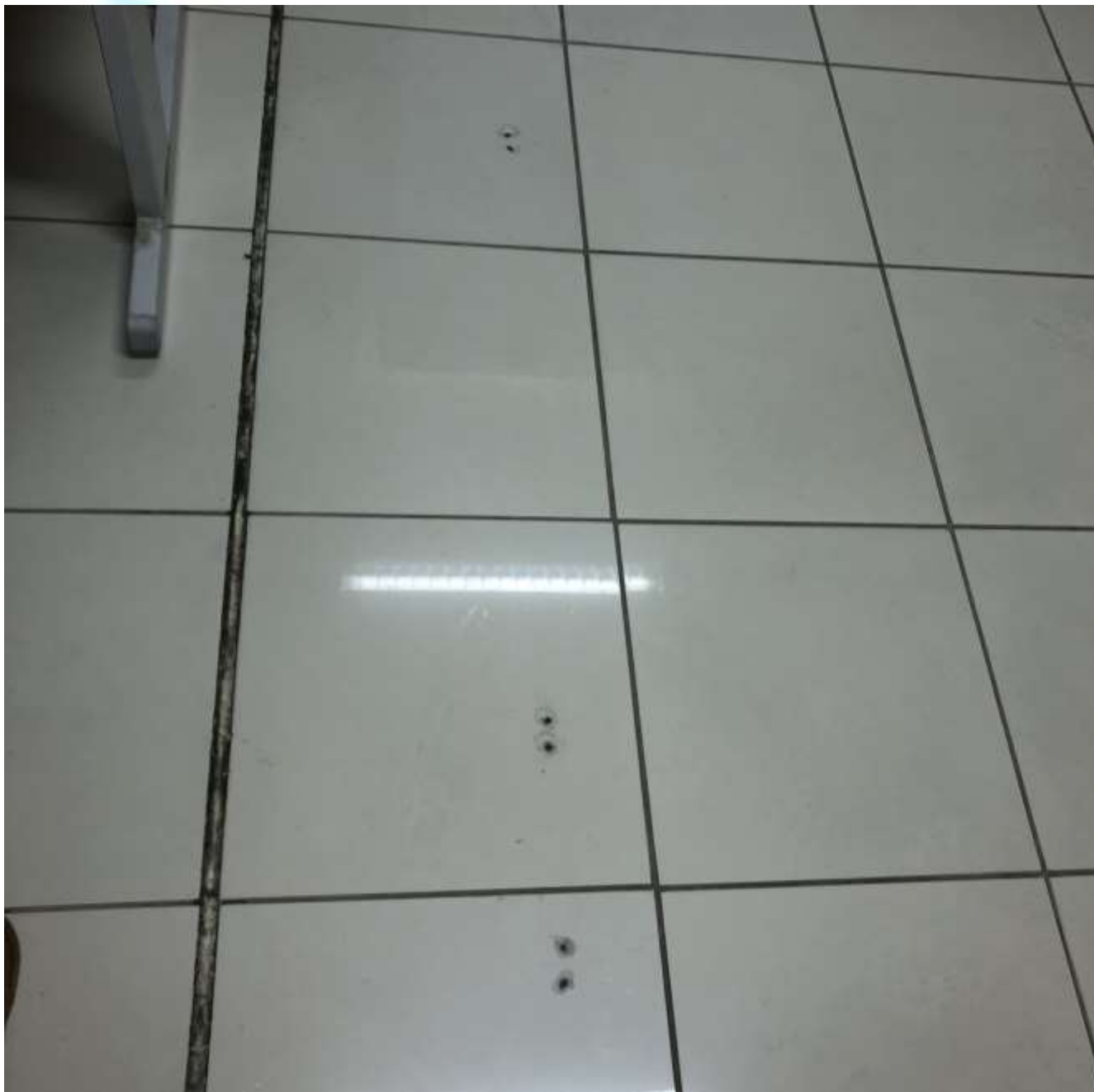
Figura 162 - Junta de dilatação e pedras danificadas
