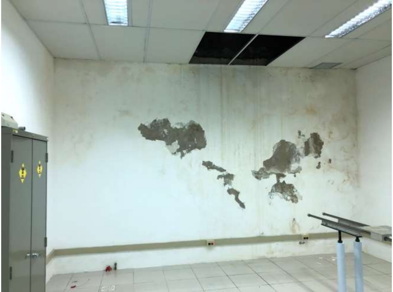
Figura 122 - Manchas de Infiltração e placas faltantes
