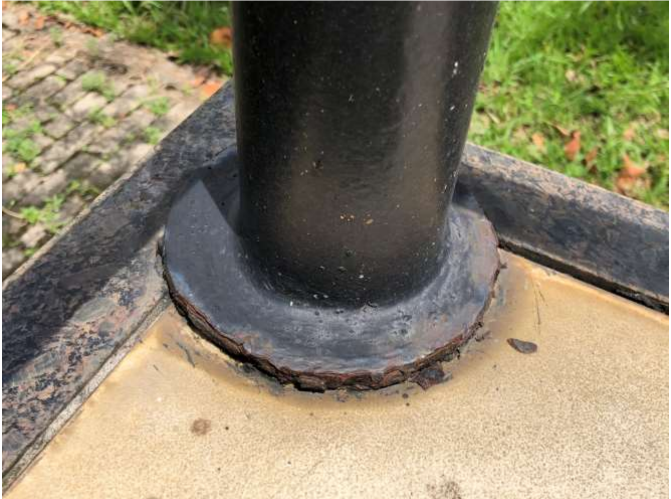
Figura 30 - Base do corrimão oxidada
