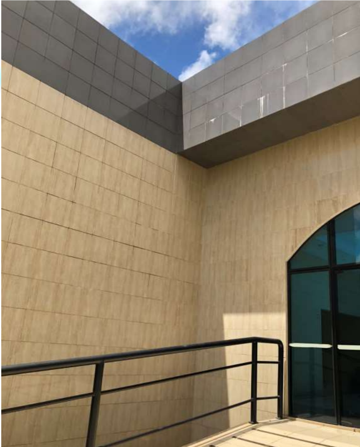
Figura 45 - Sujidades e pontos de eflorescência
