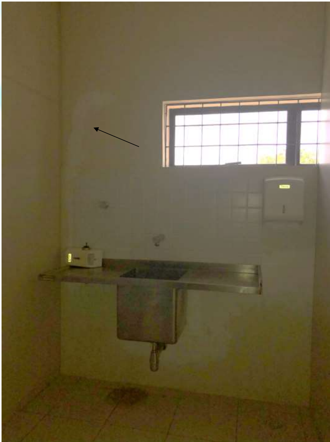
Figura 174 - Fissura ao lado da janela
