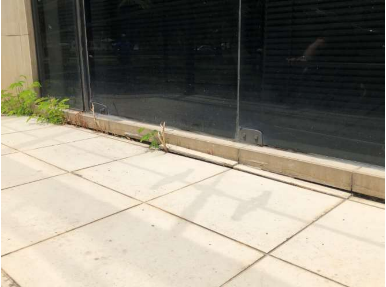
Figura 48 - Deslocamento do piso e ausência de rejunte
