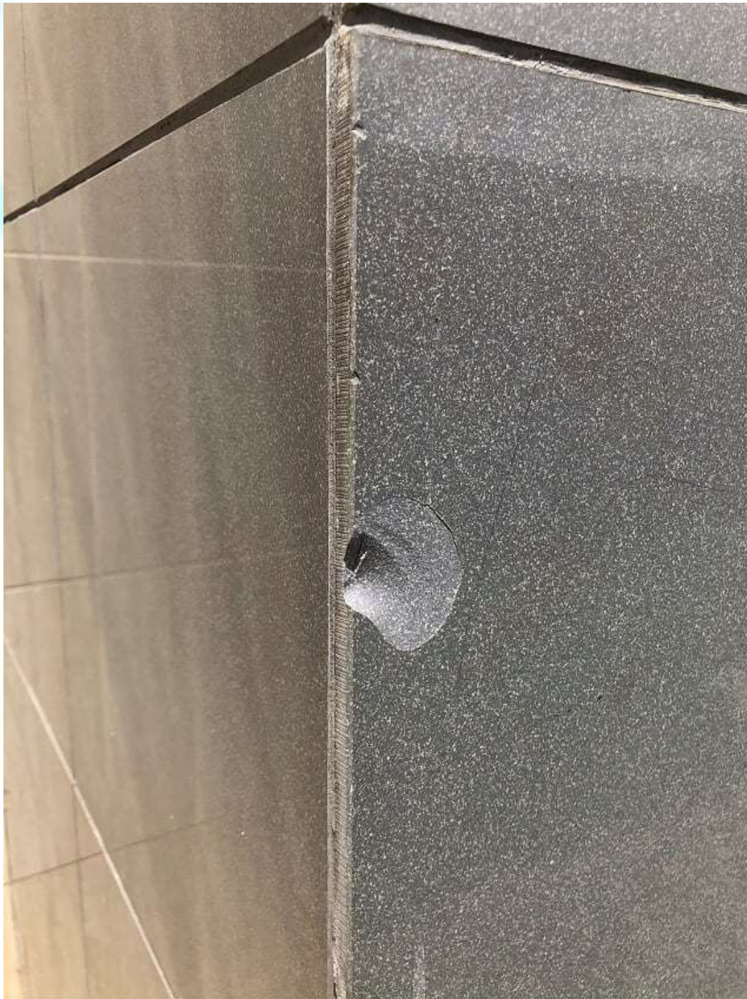
Figura 37 - Pedra cerâmica quebrada
