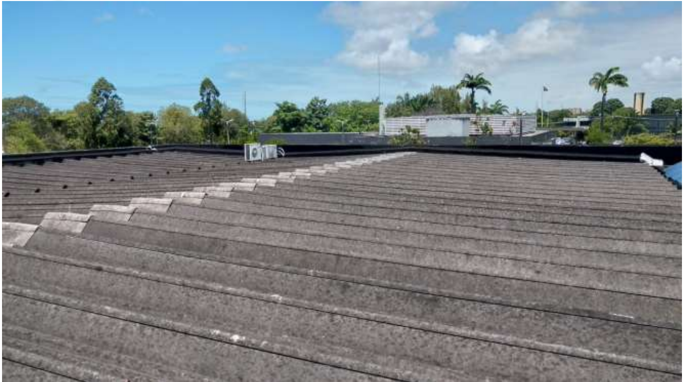
Figura 67 - Encontro das águas em telhas de fibrocimento
