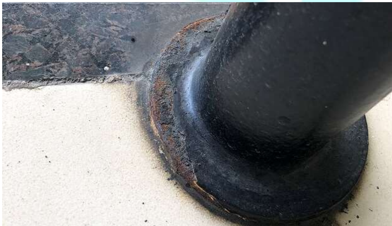
Figura 21 - Base do corrimão oxidada
