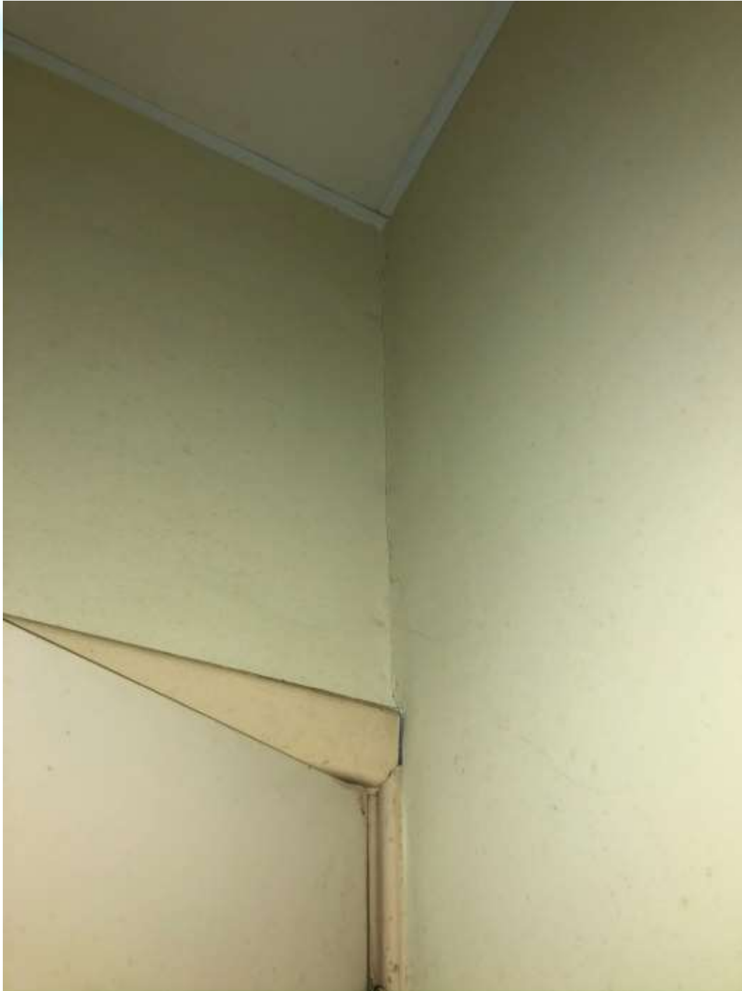
Figura 172 - Fissura na parede da porta
