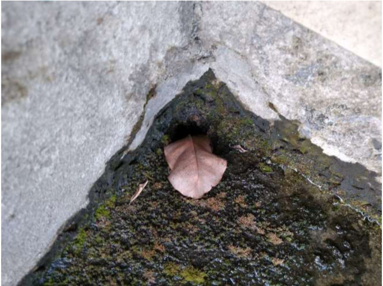
Figura 78 - Ralo comprometido por excesso de lodo e sujidades
