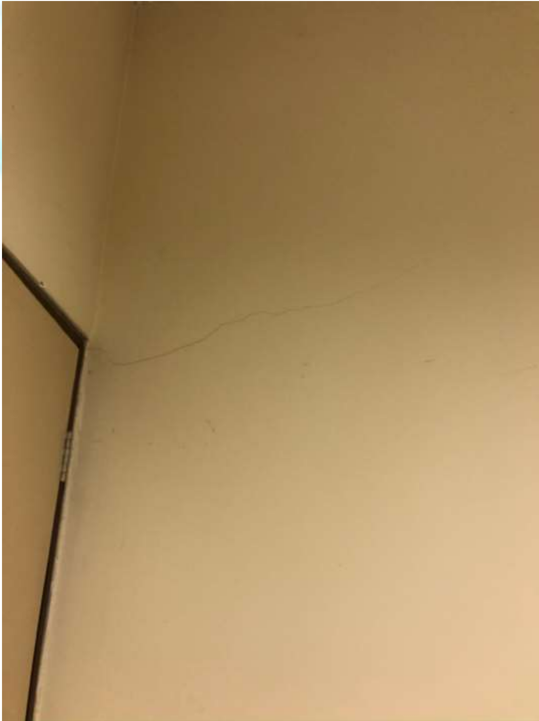
Figura 96 - Fissura na parede
