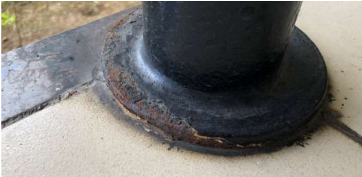
Figura 20 - Base do corrimão oxidada
