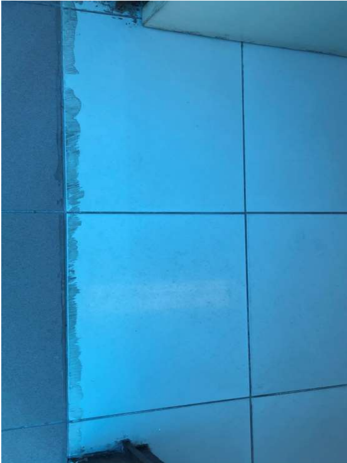
Figura 92 - Pedras de cerâmicas no piso danificadas
