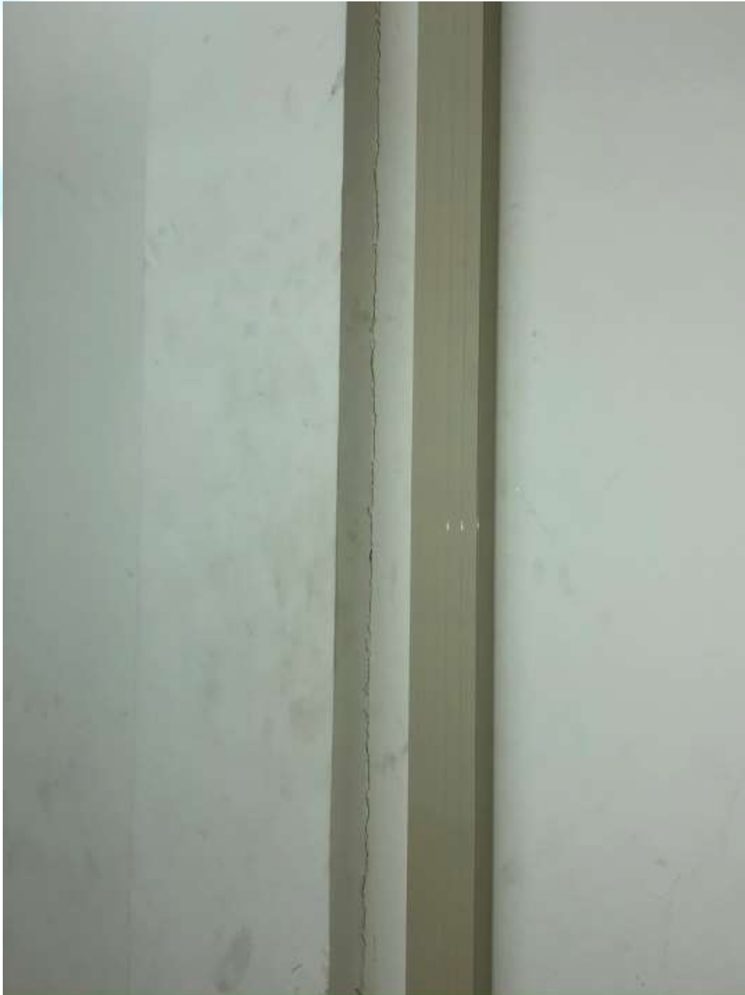
Figura 113 - Fissura longitudinal e manchas na pintura
