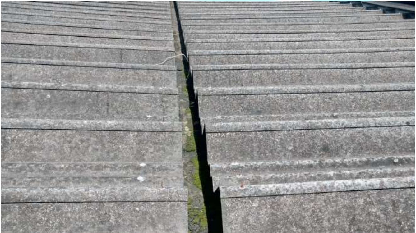
Figura 70 - Calhas com lodo
