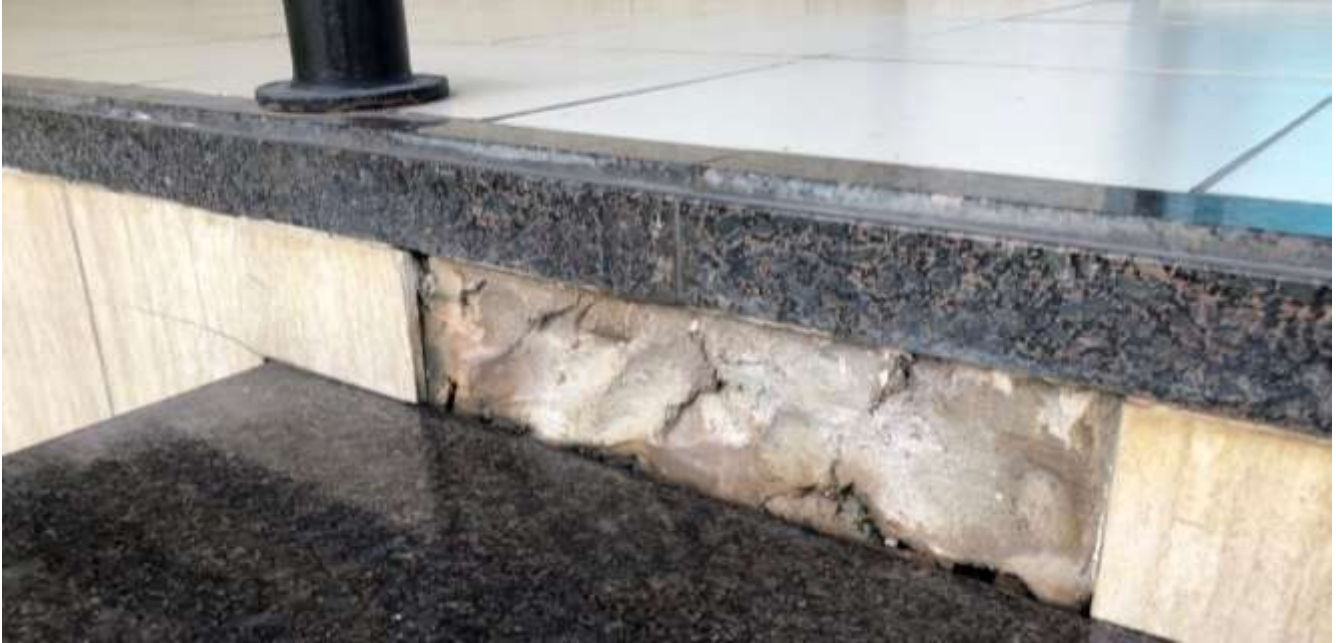
Figura 15 - Pedra cerâmica faltante e fissurada na área da escada
