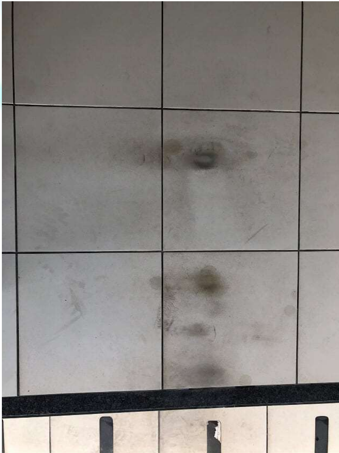
Figura 26 - Manchas no piso do patamar em decorrência de infiltrações na laje
