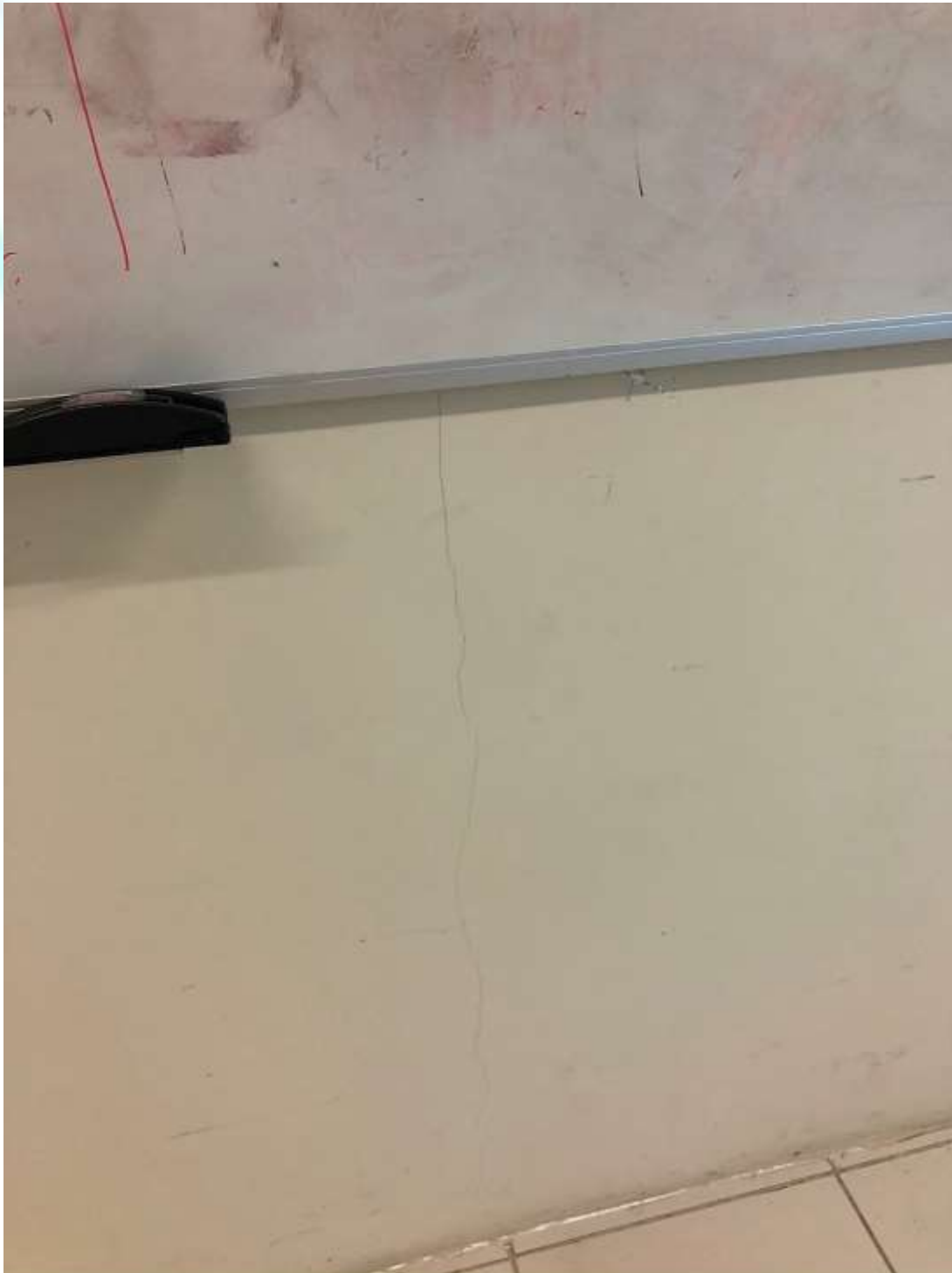
Figura 94 - Fissura na parede
