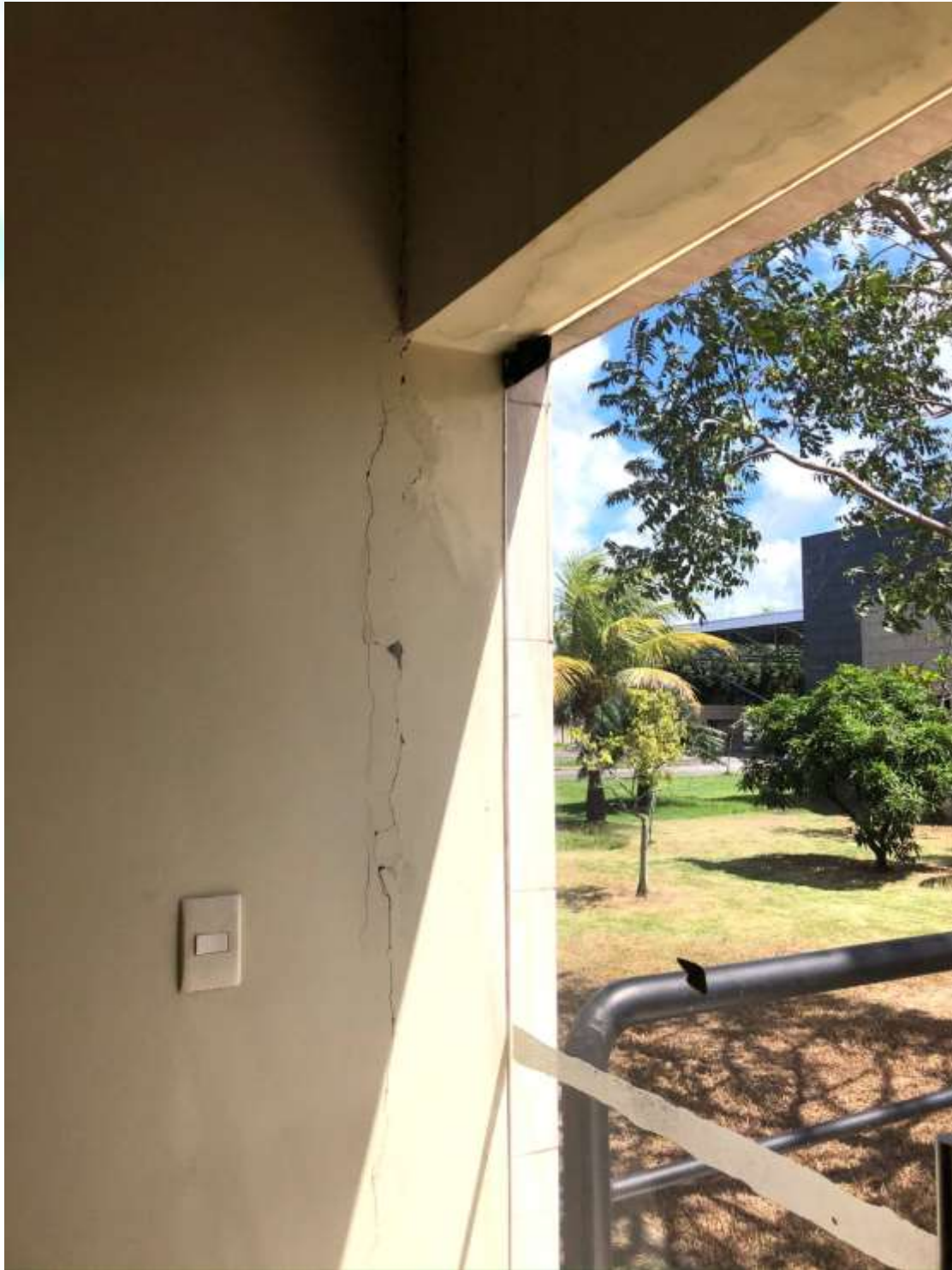
Figura 179 - Fissura longitudinal lateral a porta de vidro
