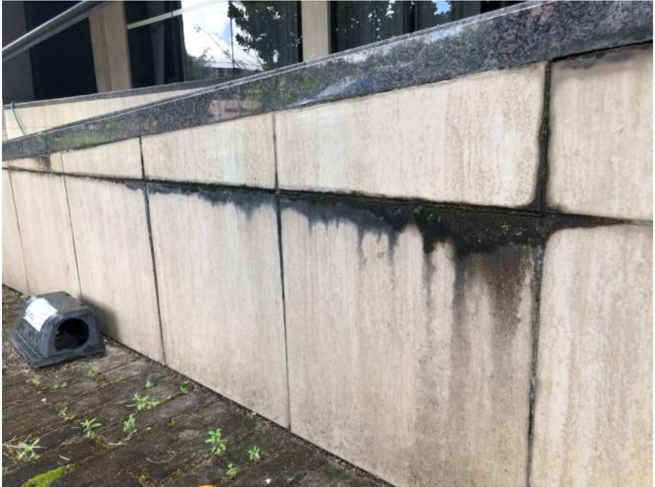
Figura 22 - Sujidades na lateral da rampa
