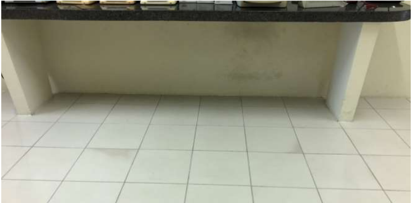
Figura 109 – Pedras de cerâmica e parede com manchas
