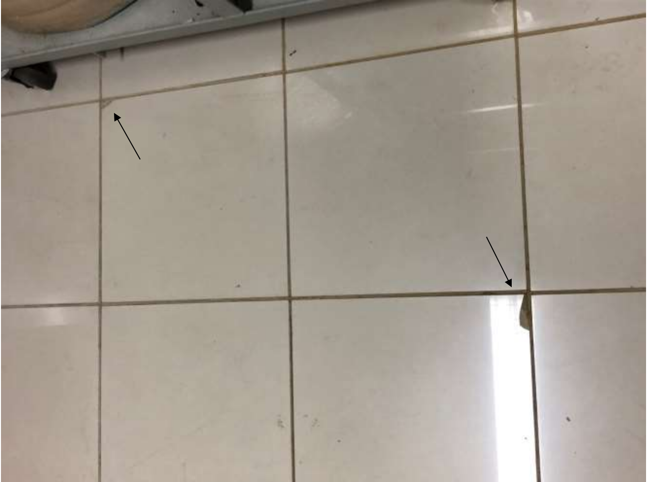
Figura 100 – Pedras de cerâmicas no piso quebradas
