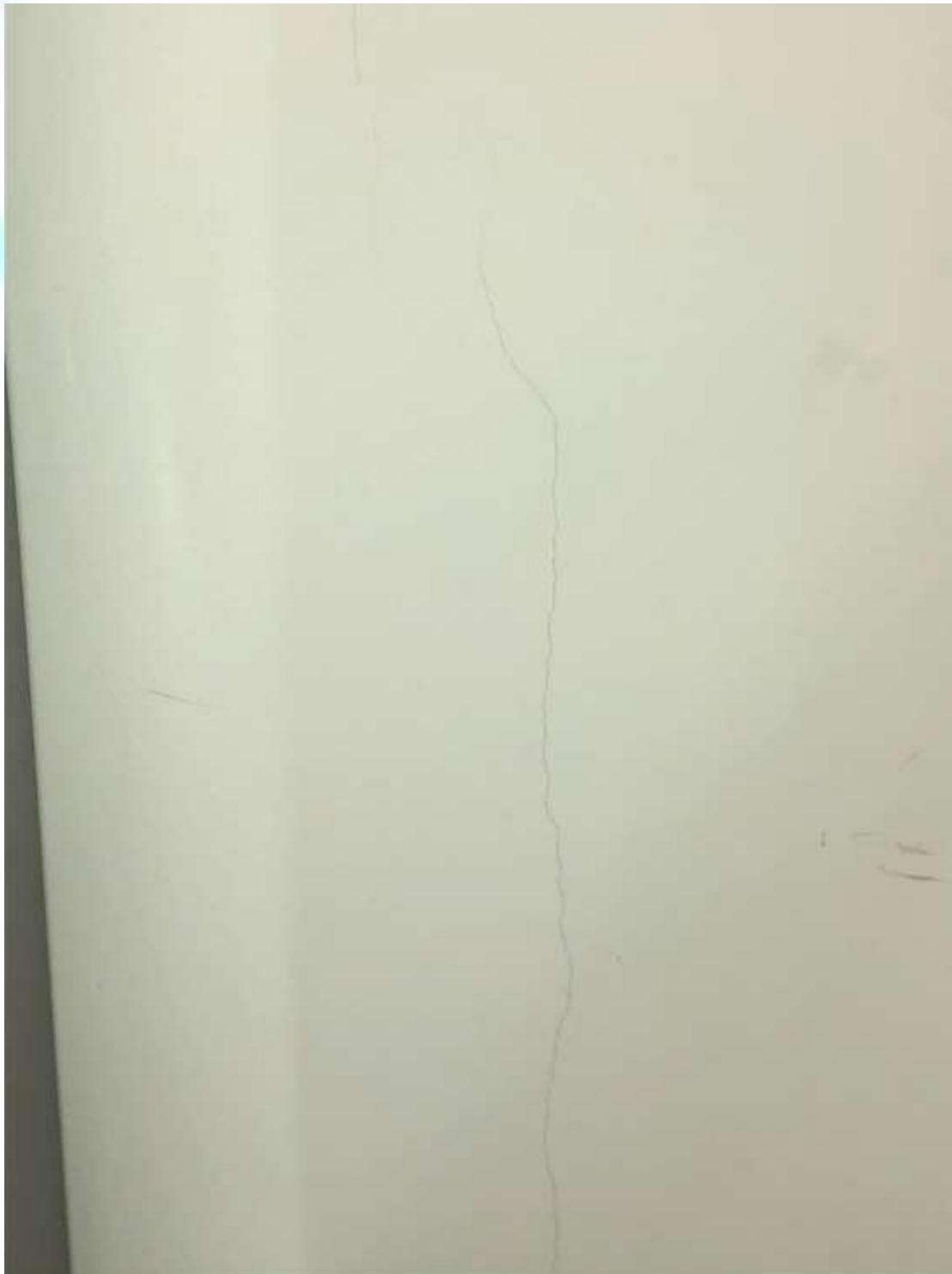
Figura 102 - Fissura na parede
