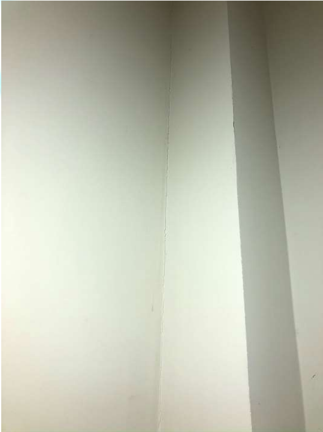
Figura 97 - Fissura vertical em encontro de alvenaria e pilar
