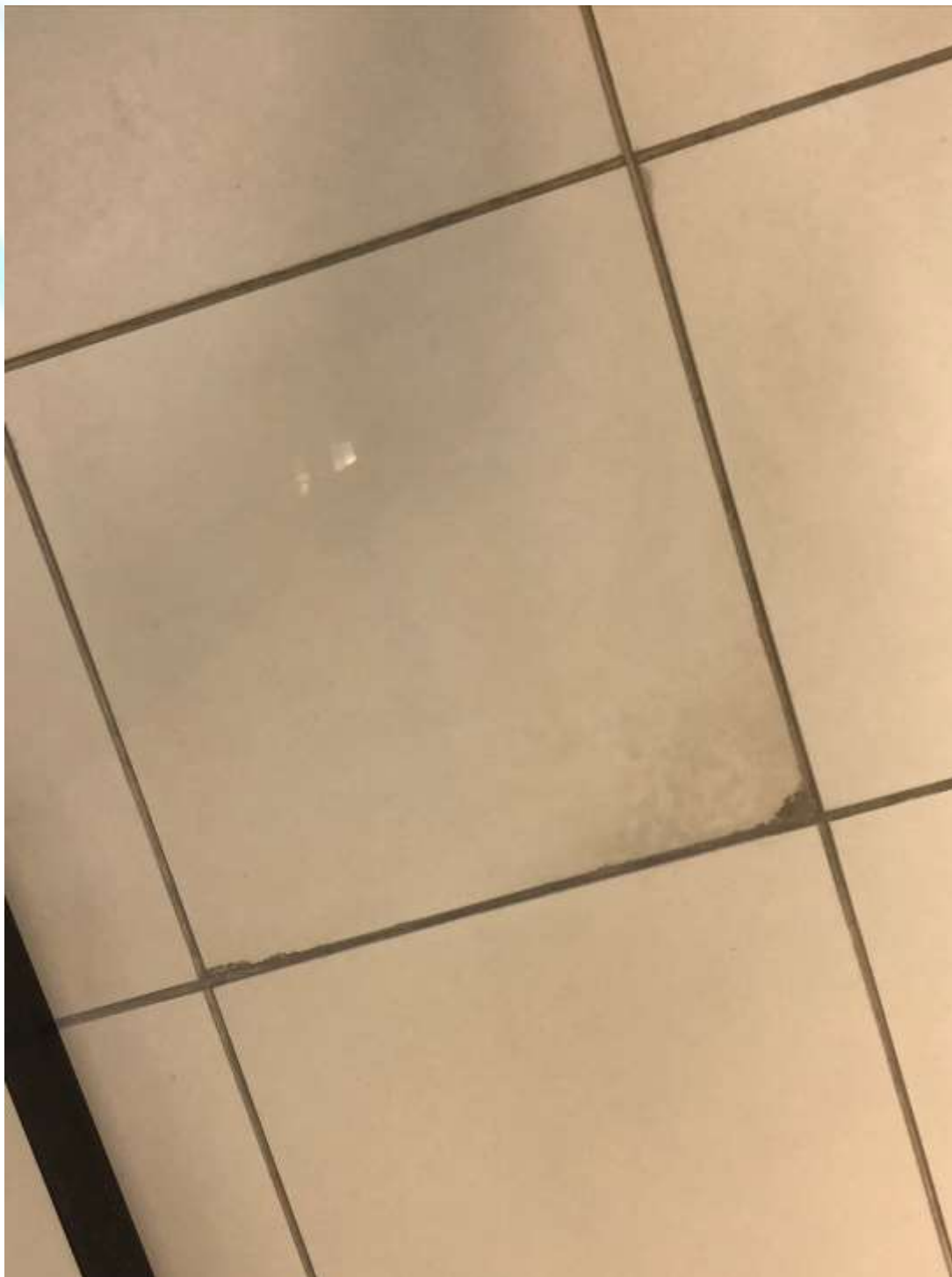
Figura 91 – Pedras de cerâmica no piso danificadas
