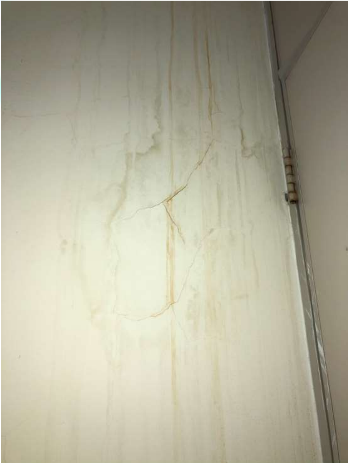
Figura 153 - Marcas de infiltração na lateral da porta
