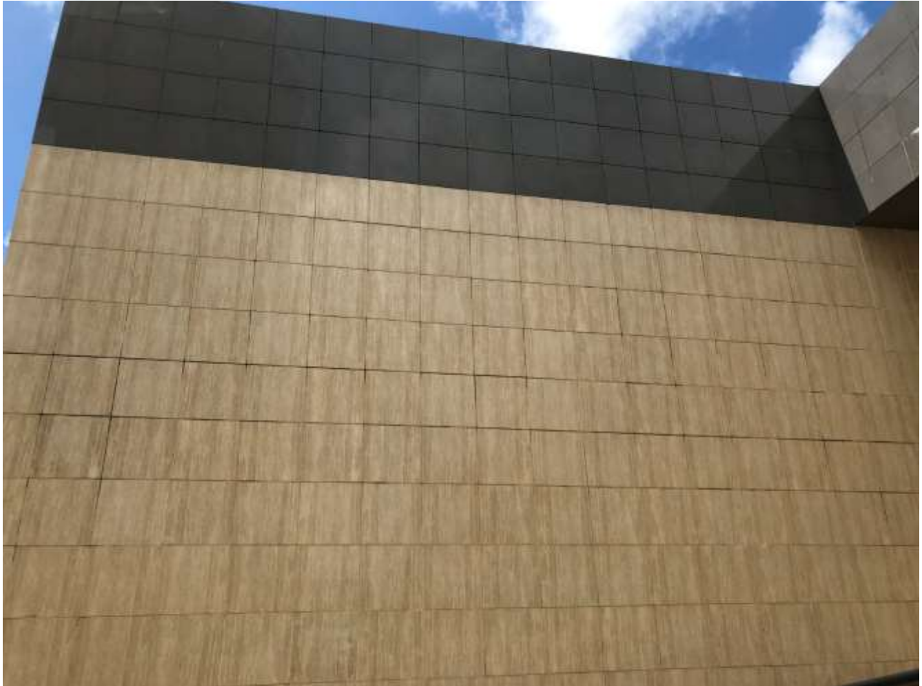
Figura 44 - Sujidades e rejuntos deteriorados
