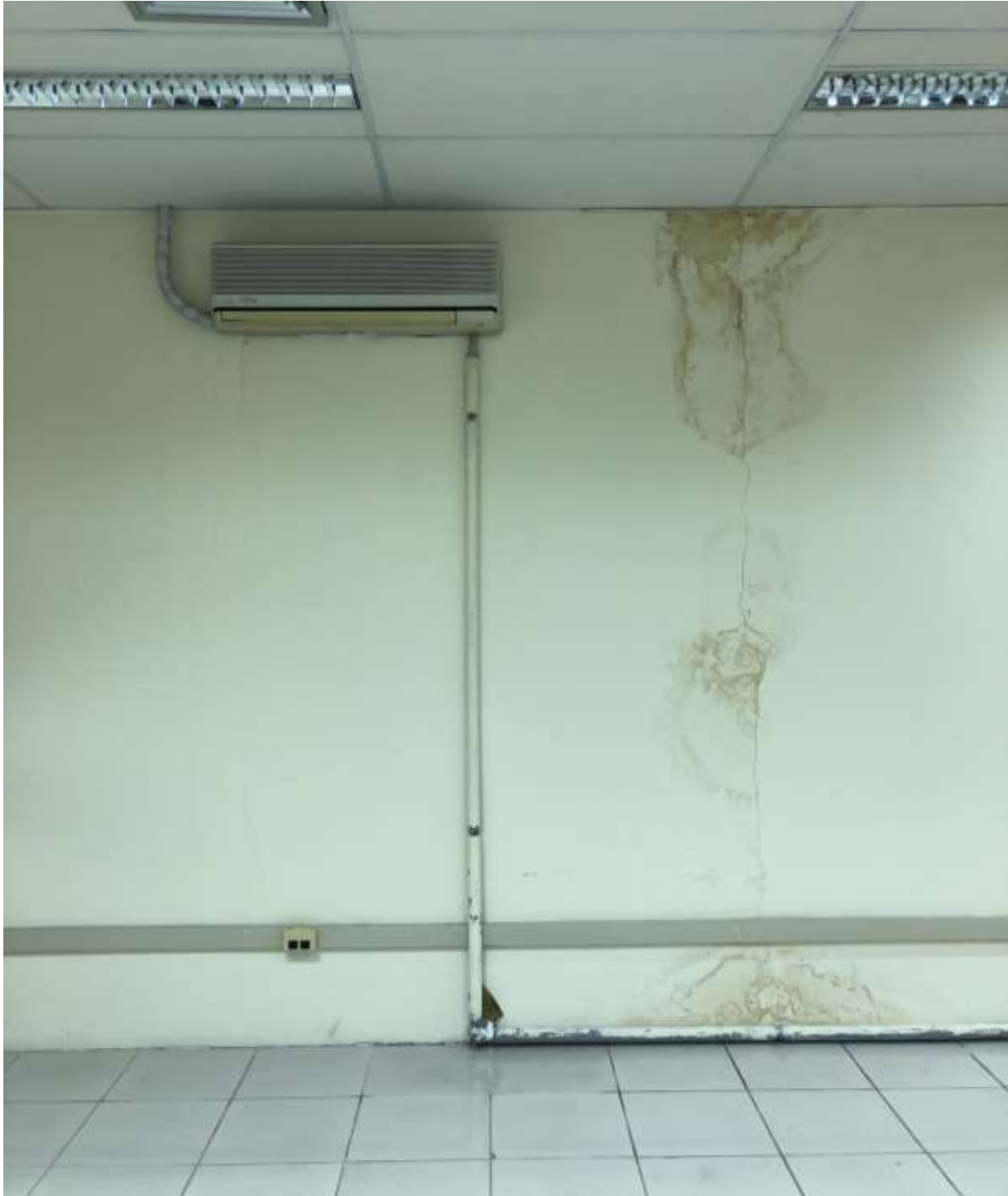
Figura 137 - Infiltração e fissura longitudinal
