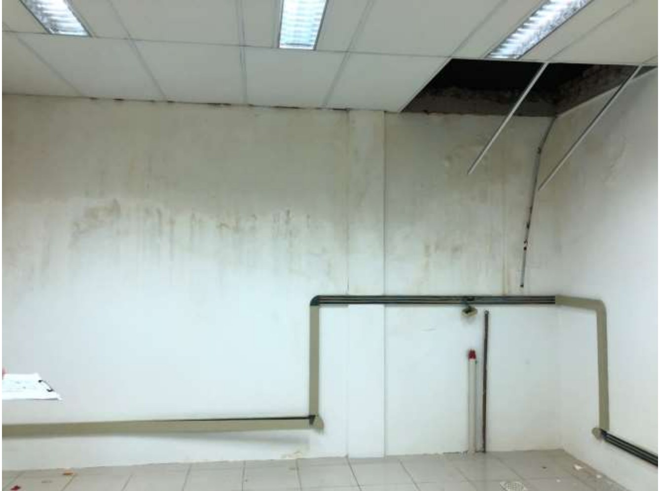
Figura 125 - Manchas de infiltração provenientes da fachada, estrutura do forro danificada e placas faltantes
