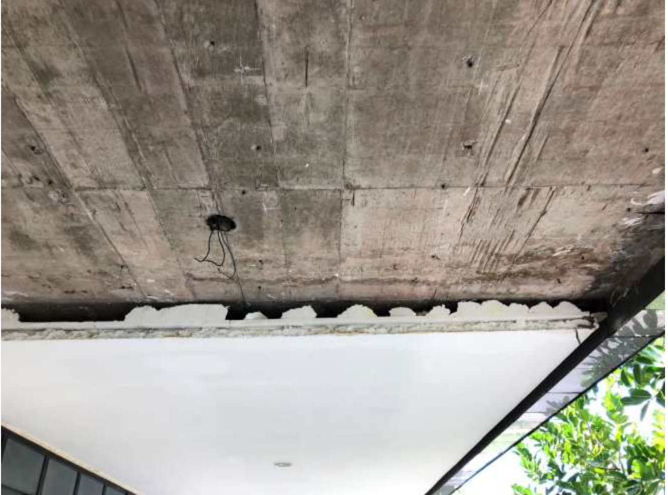
Figura 79 - Área de distensão do forro de gesso
