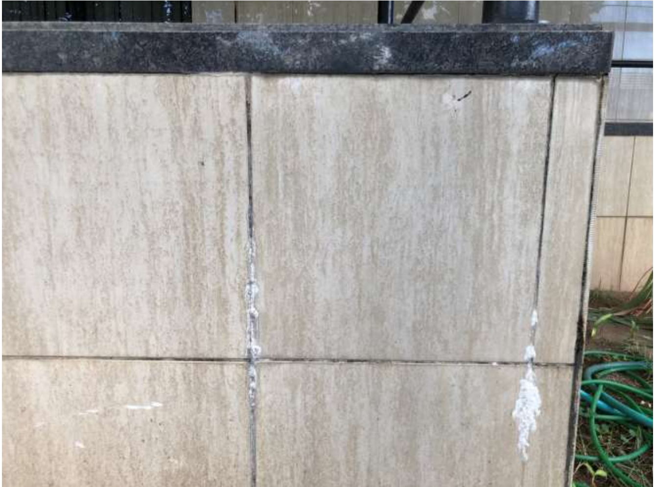
Figura 23 - Pontos de eflorescência e sujeidades na lateral da rampa
