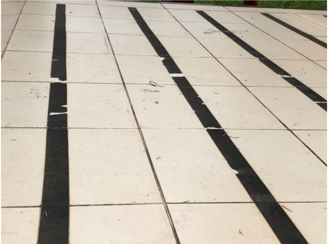
Figura 43 - Fitas antiderrapantes danificadas na rampa posterior
