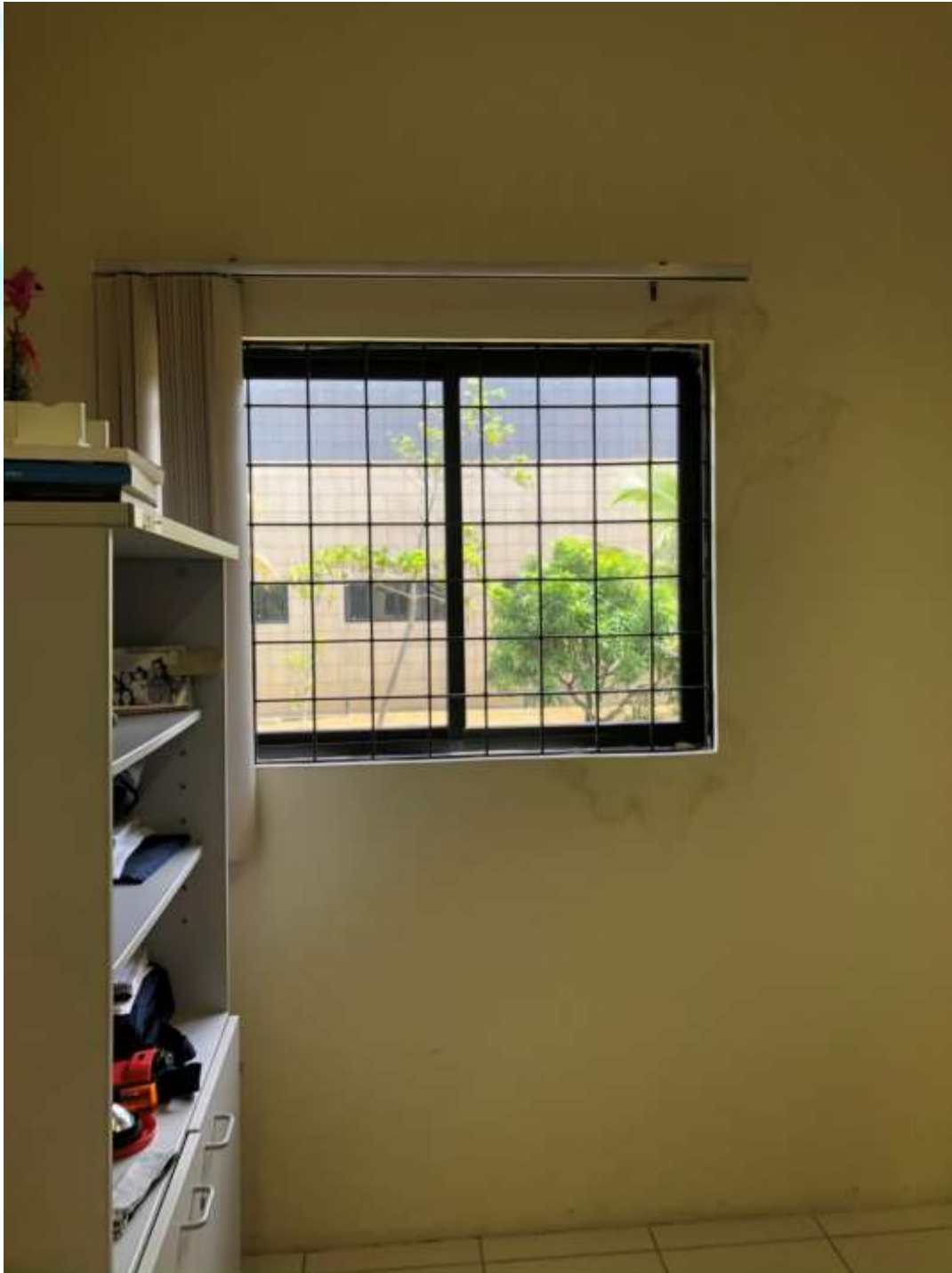
Figura 151 - Marcas de infiltração
