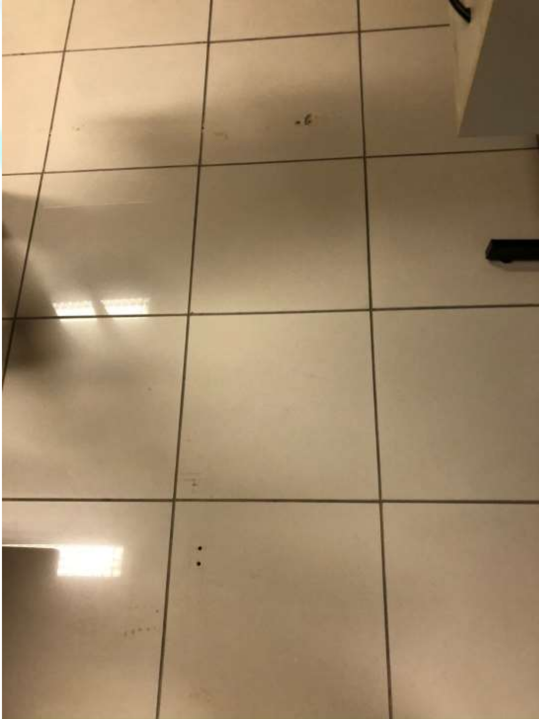
Figura 170 - pedras de cerâmica danificadas
