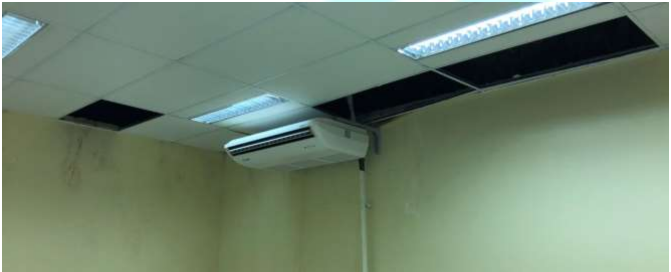
Figura 121 - placas de forro faltantes
