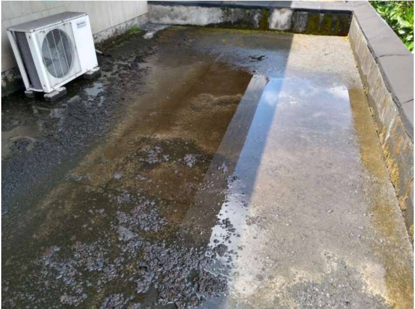
Figura 77 - Acúmulo de água na laje da marquise
