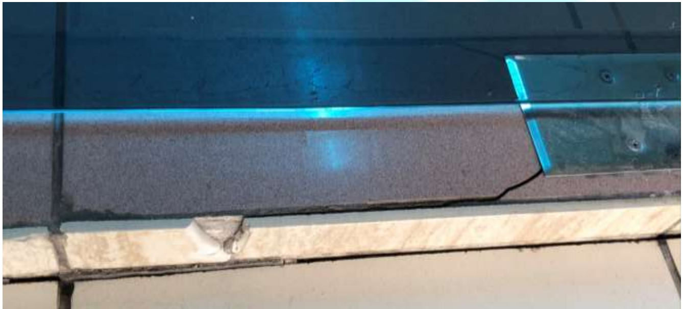
Figura 84 – Pedras de cerâmica no piso danificadas
