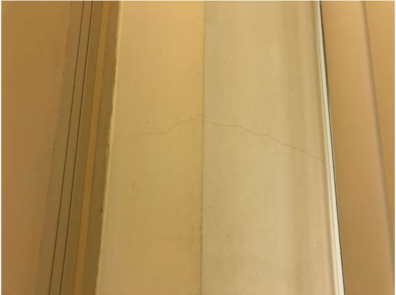
Figura 150 - Fissura no pilar
