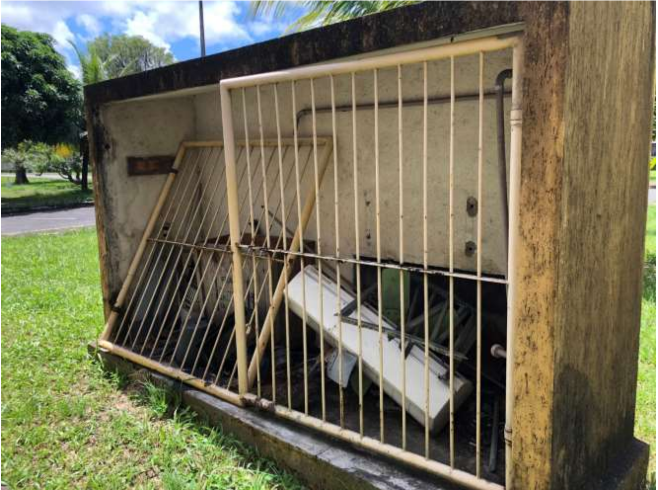
Figura 60 - Anexo ao prédio com grades quebradas
