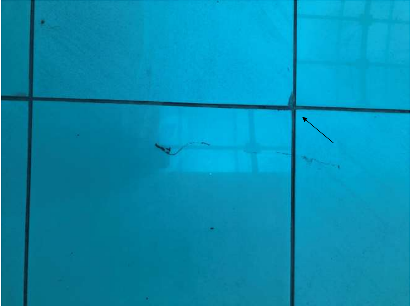
Figura 85 – Pedras de cerâmica no piso danificadas
