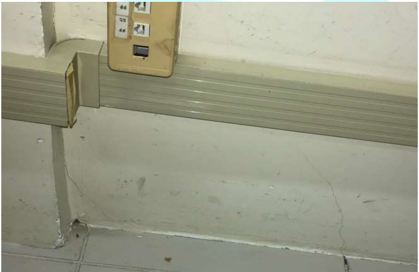
Figura 115 - Fissuras, emassamento danificado e manchas na pintura
