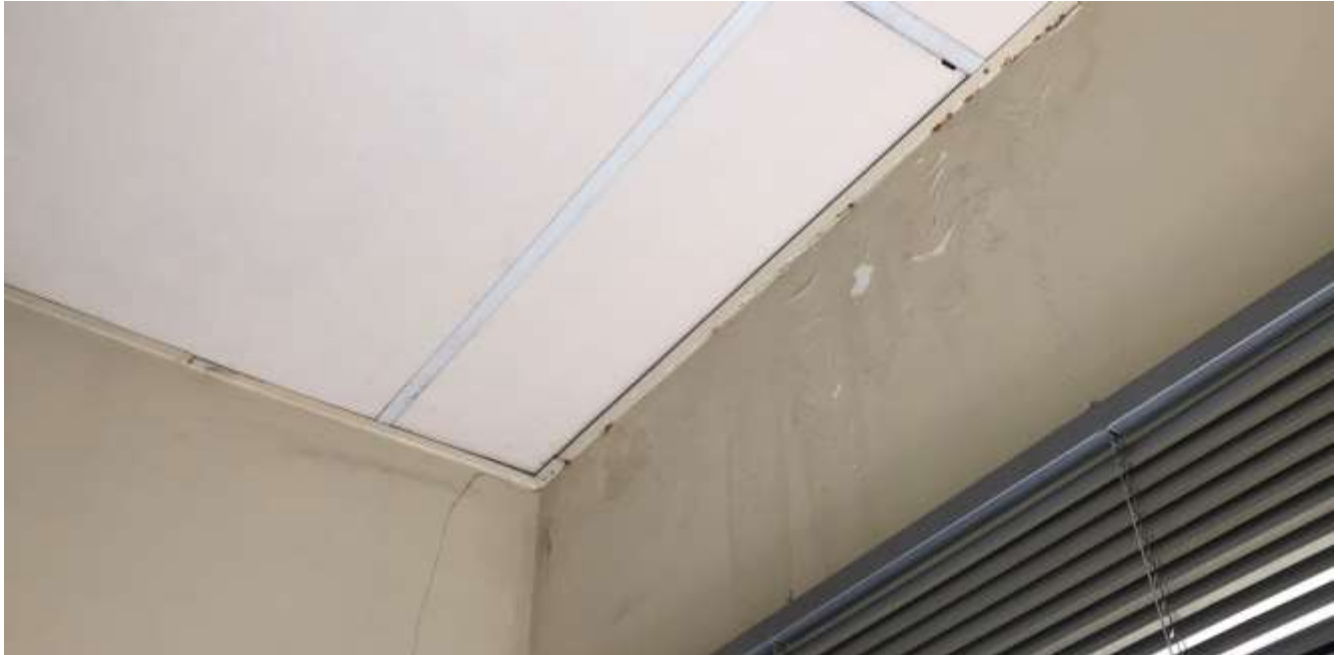
Figura 104 - Infiltração proveniente da fachada
