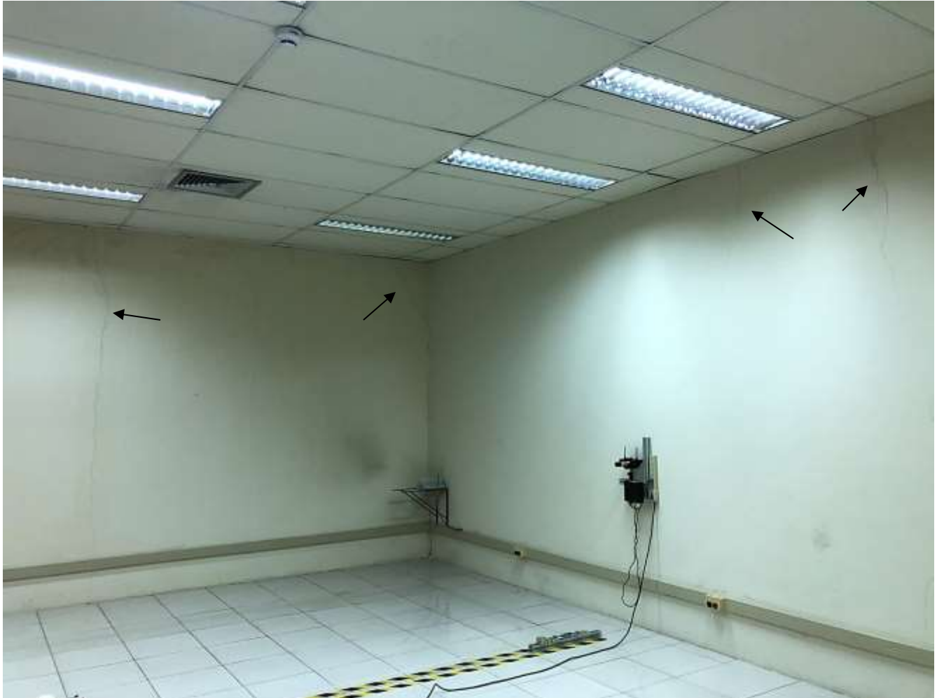
Figura 131 – Fissuras e sujidades
