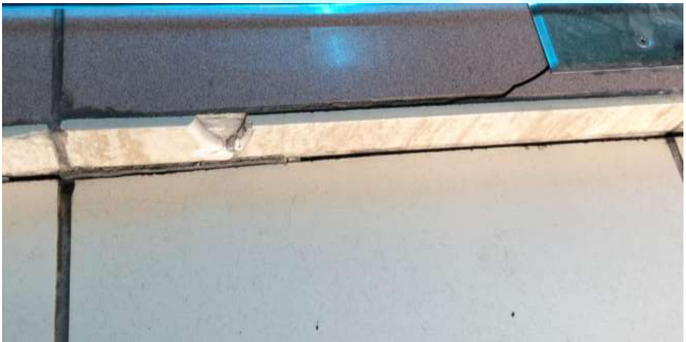
Figura 9 - Pedras danificadas no rodapé
