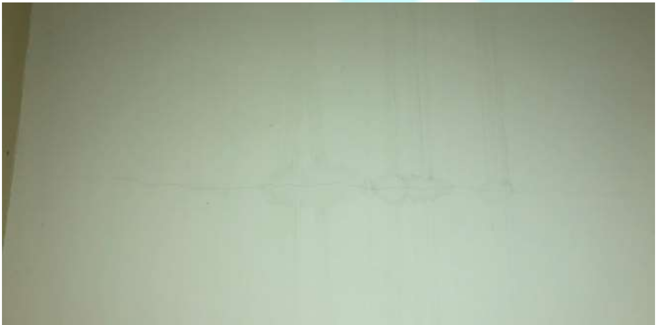
Figura 128 - Fissura longitudinal na parede
