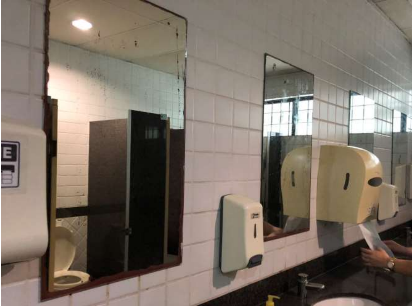
Figura 146 - Espelhos danificados (Wc Feminino)
