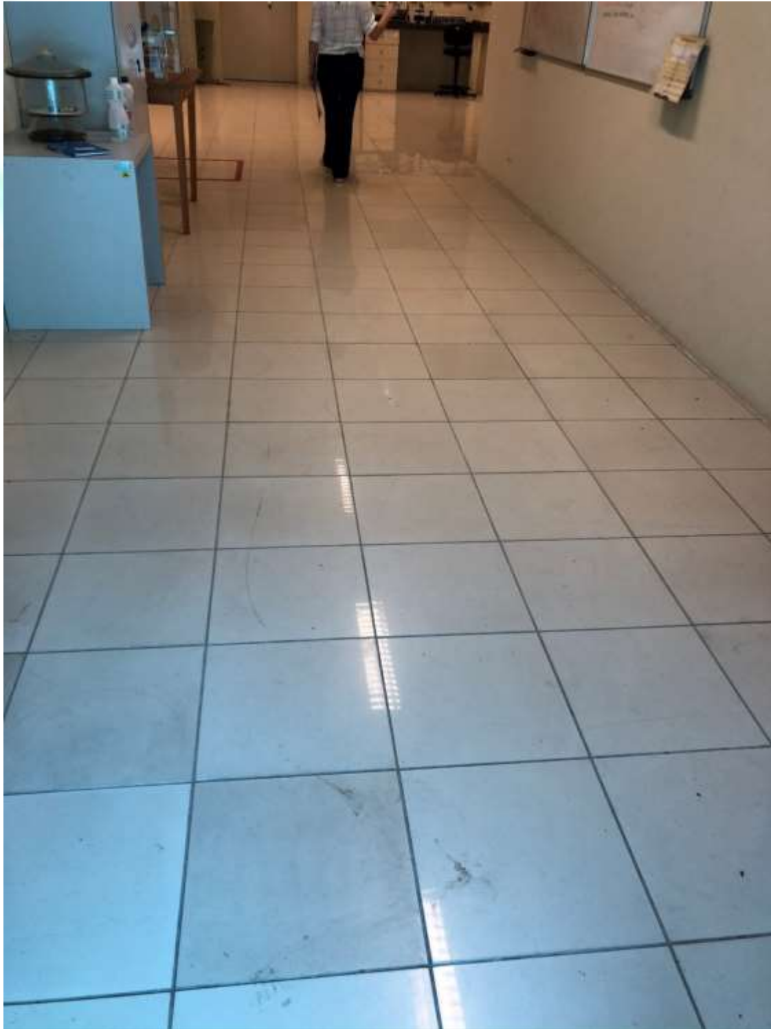
Figura 95 - Piso apresentando manchas e fissuras
