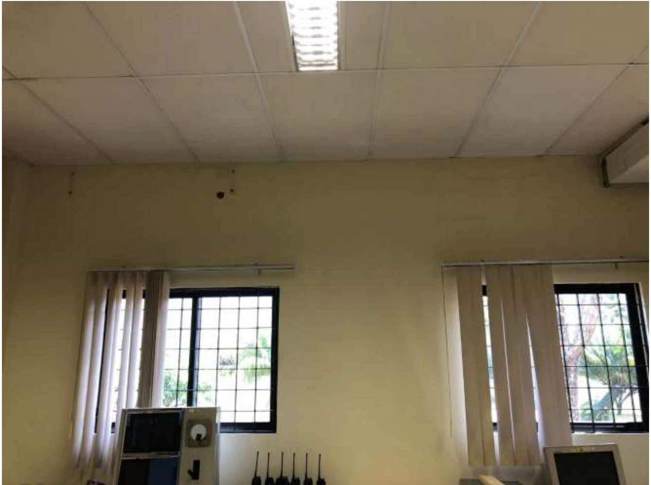
Figura 155 - Marcas de infiltração e desgaste de pintura
