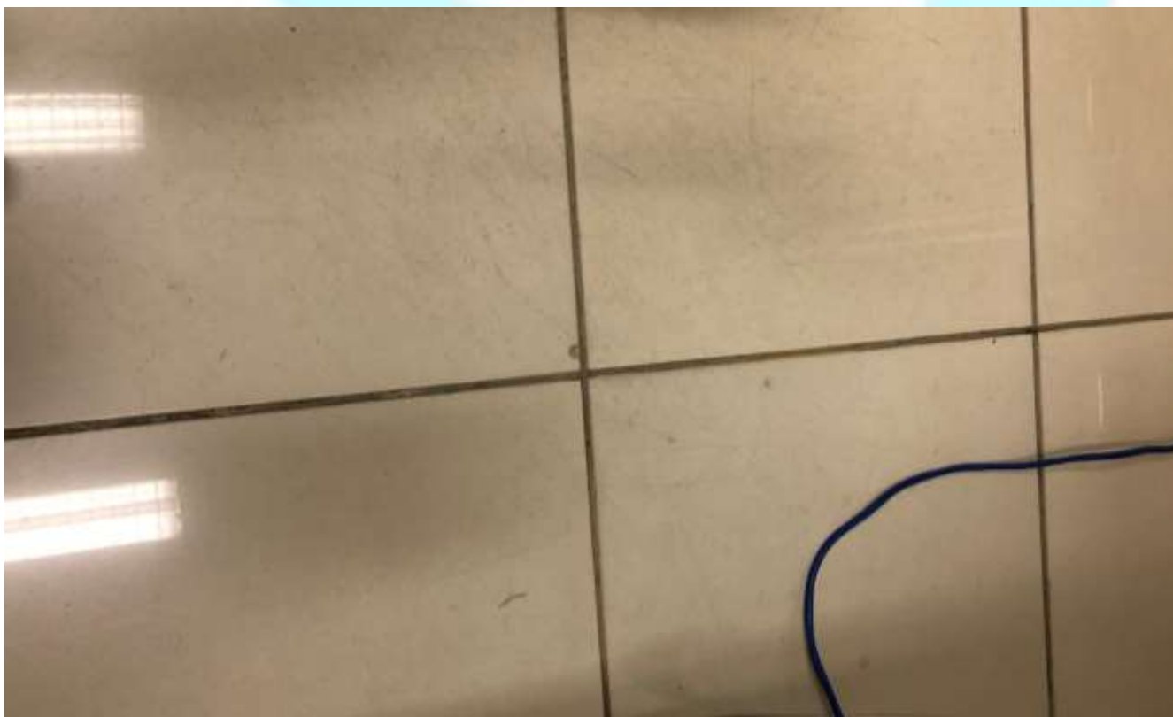
Figura 157 - Pedras cerâmicas arranhadas, quebradas e manchadas
