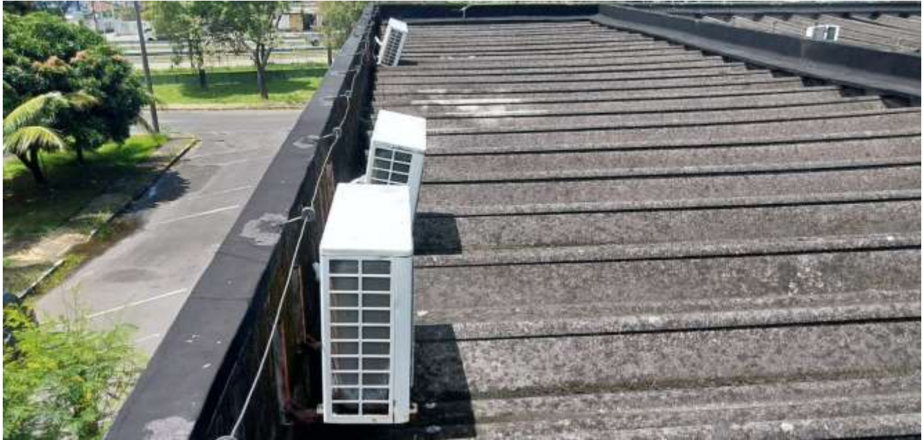
Figura 69 - Condensadores fixados na platibanda sobre as telhas
