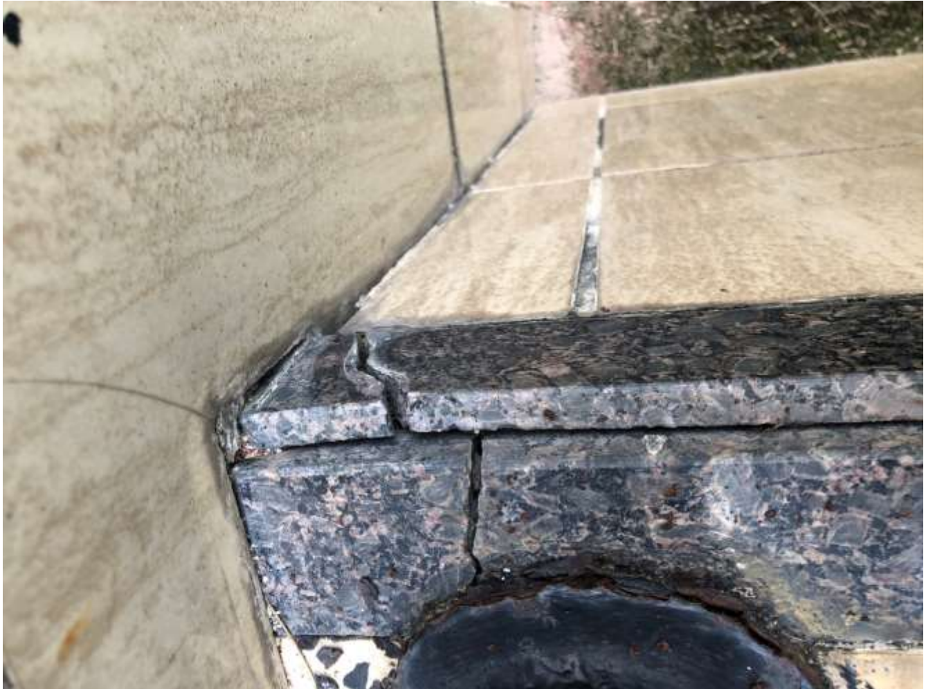
Figura 29 - Pedras de granito quebradas na margem da rampa
