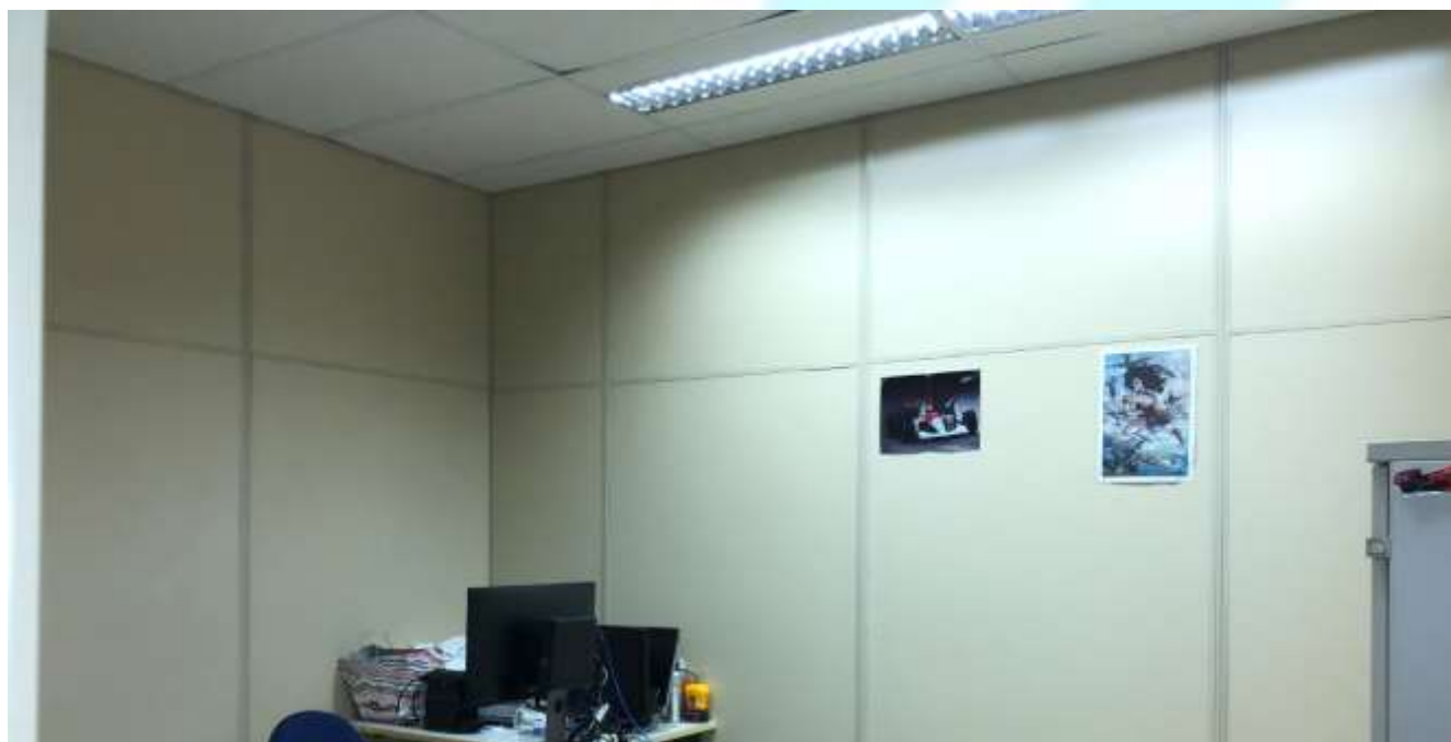
Figura 159 - Placa do forro danificada
