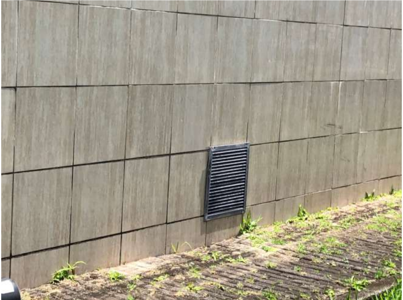
Figura 59 - Grelha danificada necessitando de nova pintura
