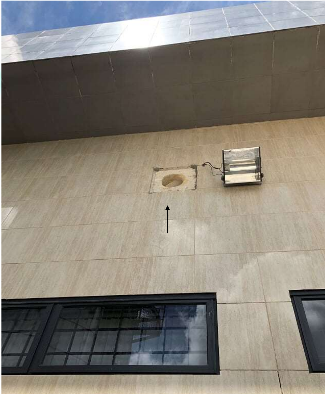
Figura 36 – Pedra de cerâmica de revestimento faltante
