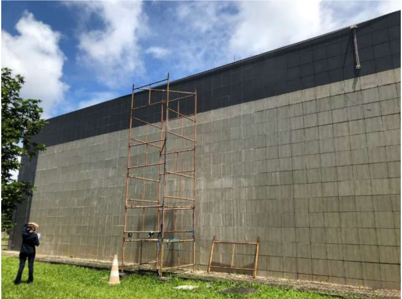
Figura 55 - Sujidades, eflorescência e rejuntas danificados
