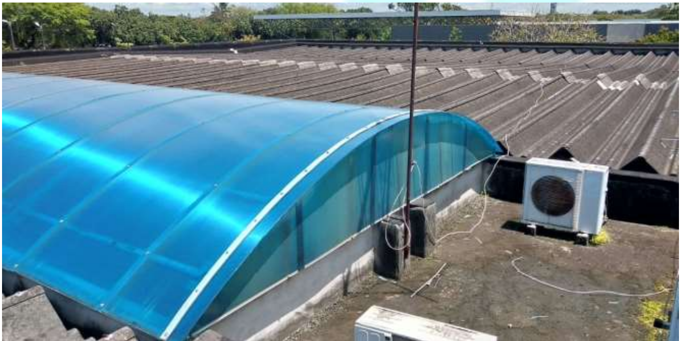
Figura 68 - Área de laje, apoio para manutenção e condensadores
