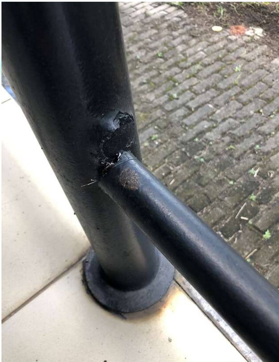
Figura 19 - Ferrugem solta no corrimão da rampa
