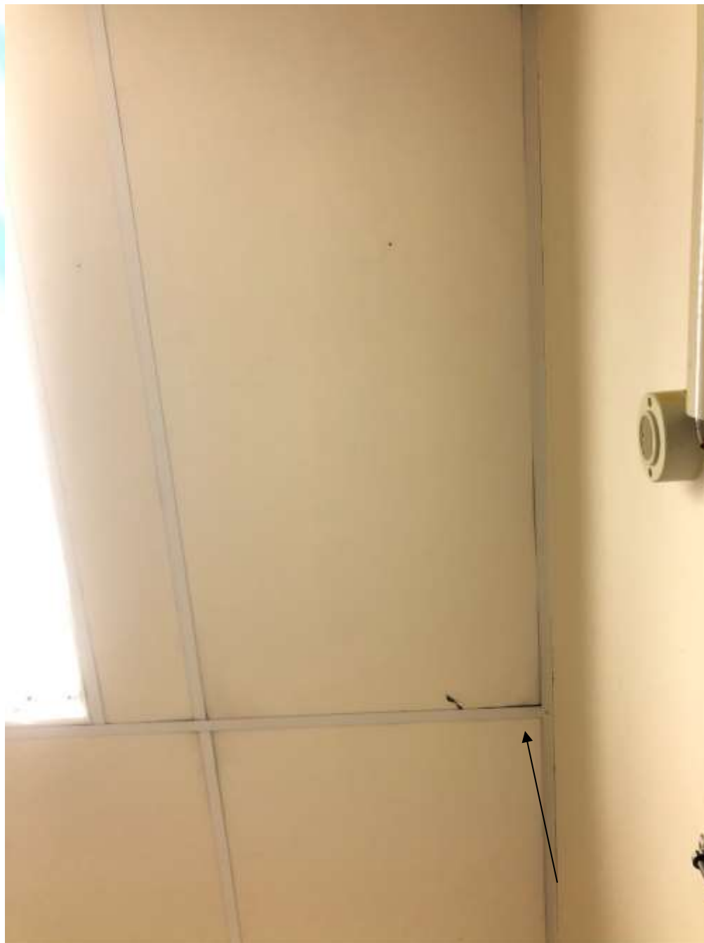
Figura 134 - Placa do forro danificada
