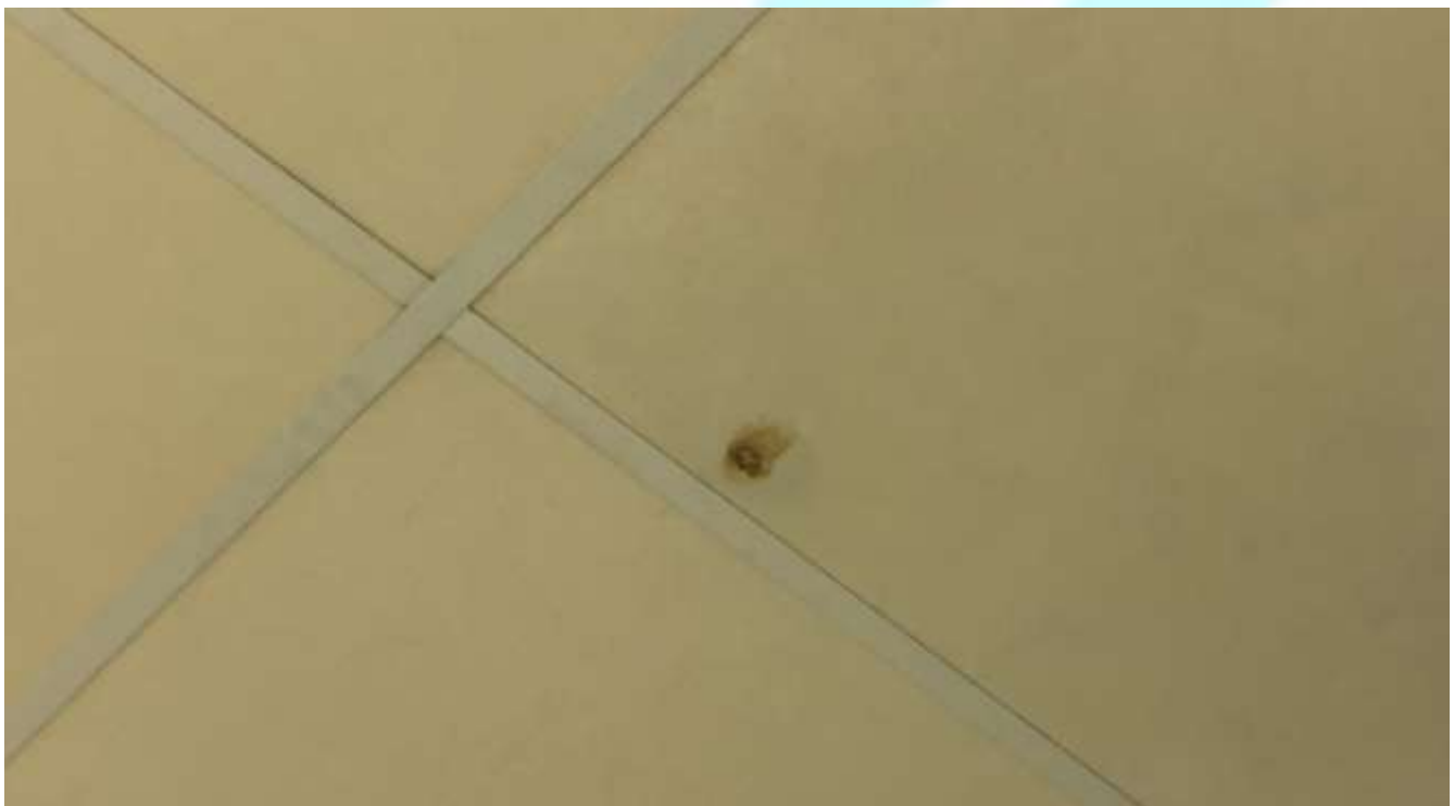
Figura 110 – Placa de forro manchada
