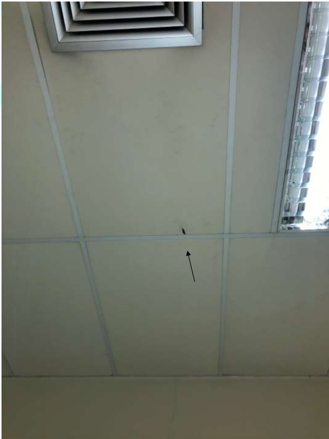
Figura 140 - Placa de forro rasgada
