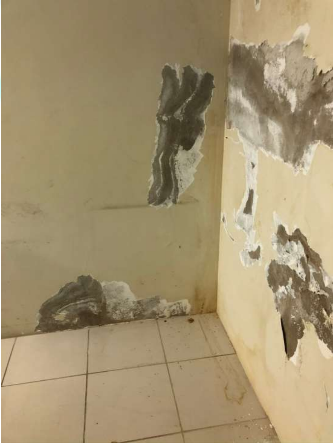
Figura 89 - Pontos de infiltração e pedras danificadas
