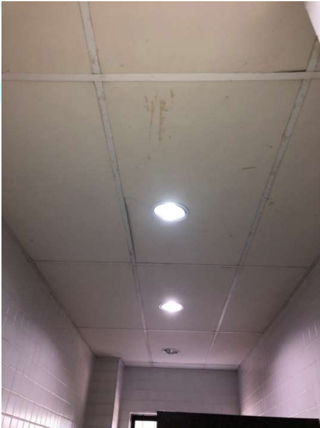
Figura 167 - Placa manchada e danificada
