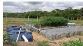
Figura 3. Vista da estação de tratamento de esgotos da Fazenda Água Limpa. TS e SZR.
