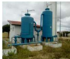
Fig. 1. ETA Sistema Pedrinhas
