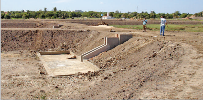
FIGURA 12 - Caixa de coleta em alvenaria
