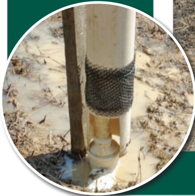
F) Tubo ("camisa") com abertura para acoplar ao tubo aterrado e tela para evitar escape de peixes, devidamente posicionada
