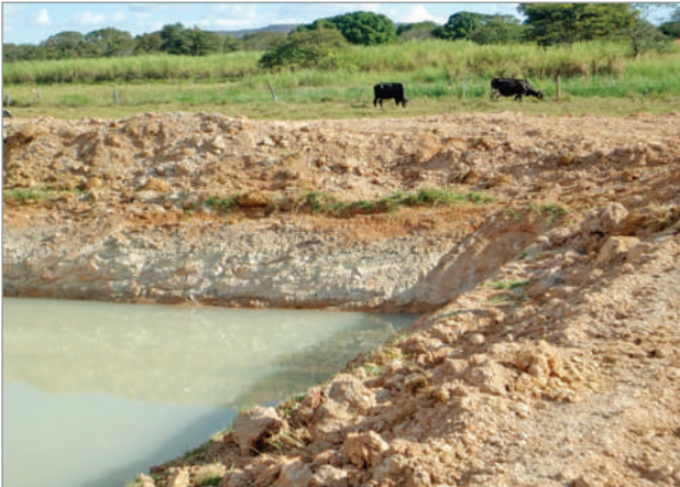
FIGURA 13 - Taludes sem inclinação correta e sem compactação, em terreno com lençol freático raso
