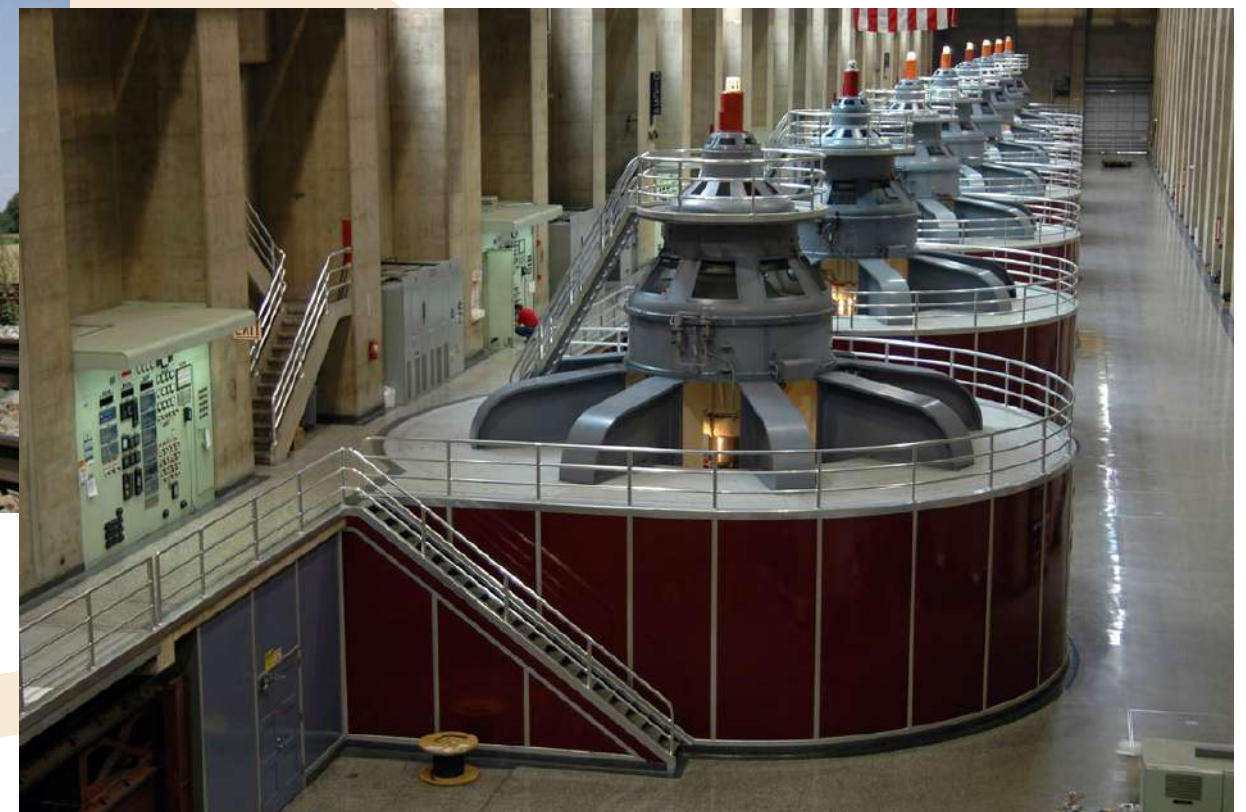
Gerador elétrico de uma hidroelétrica
