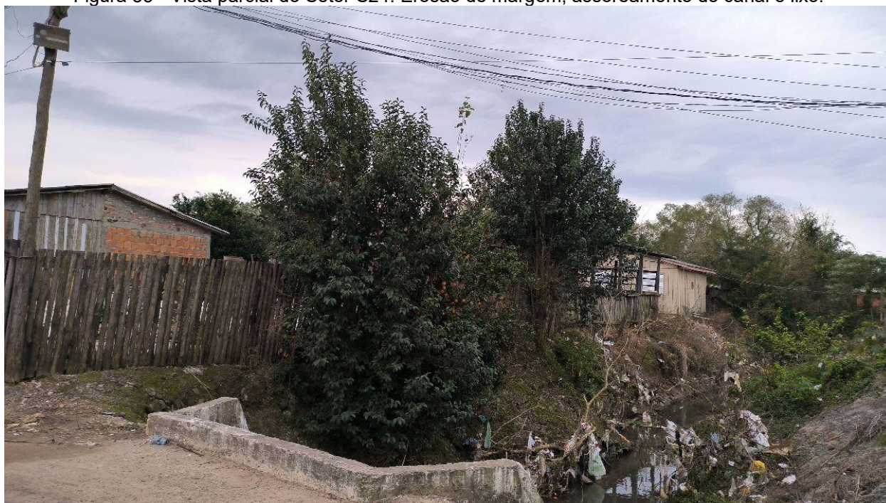
Figura 33 - Vista parcial do Setor S24. Erosão de margem, assoreamento do canal e lixo.
