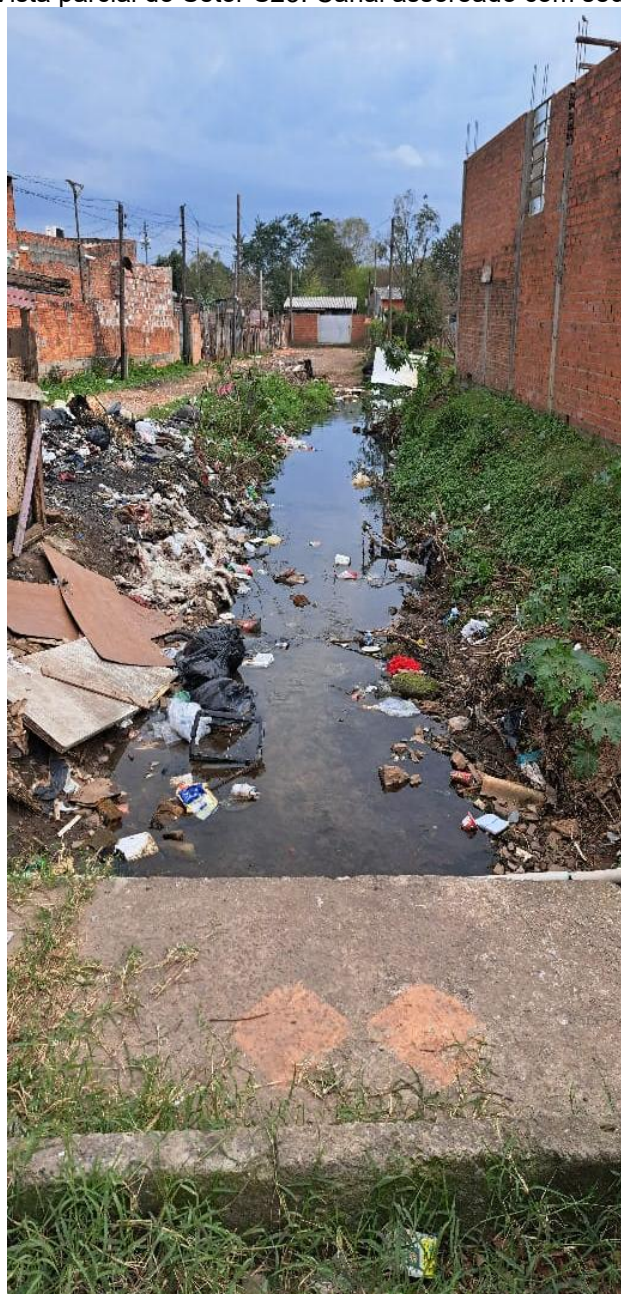
Figura 30 - Vista parcial do Setor S23. Canal assoreado com sedimento e lixo.
