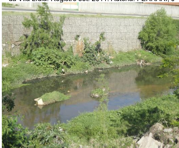
Figura 5 - Gabião no arroio Cadena, localizado na Avenida Maestro Roberto Barbosa Ribas, nas proximidades da Vila Lídia. Registro set. 2011. Autoria: FERRARI, J
