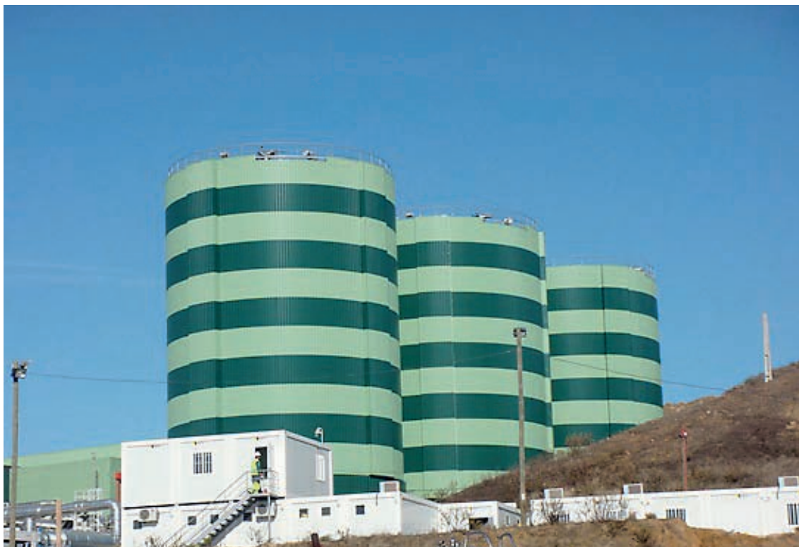
Figura 17 - Planta de digestão anaeróbia de resíduos – Unidade Tratolixo – Portugal Fonte: GRS, 2010.
