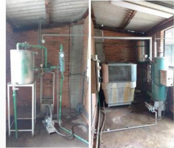
8º Caldera e Bomba de vácuo
