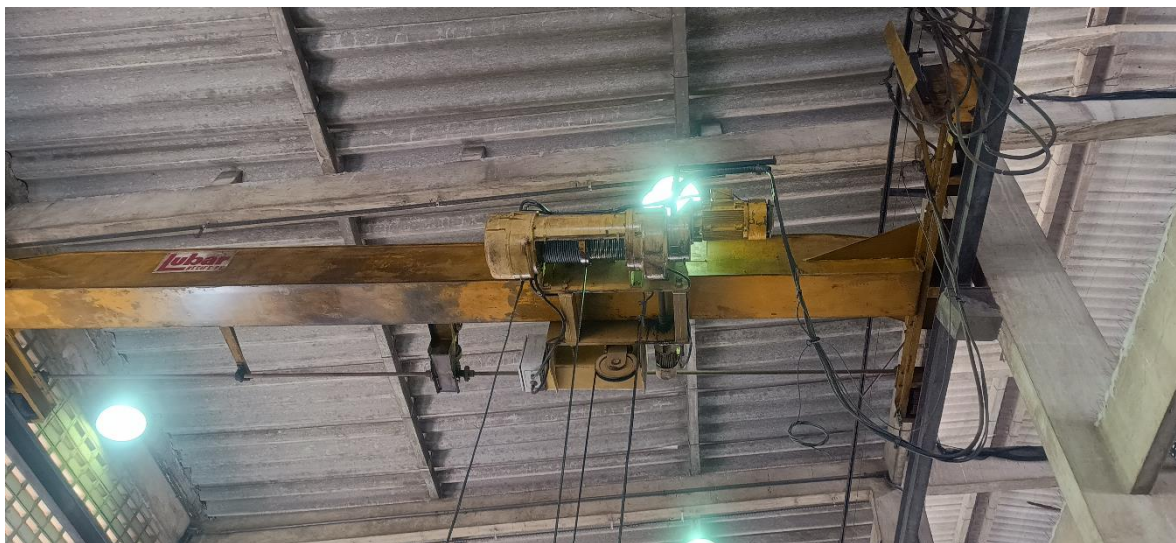
Figura 04 – Foto ponte rolante
