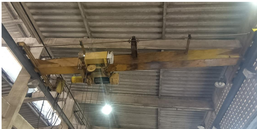
Figura 02 – Foto ponte rolante
