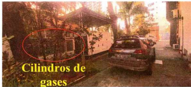
Veículo estacionado em local de passagem, muito próximo ao grupo gerador.
