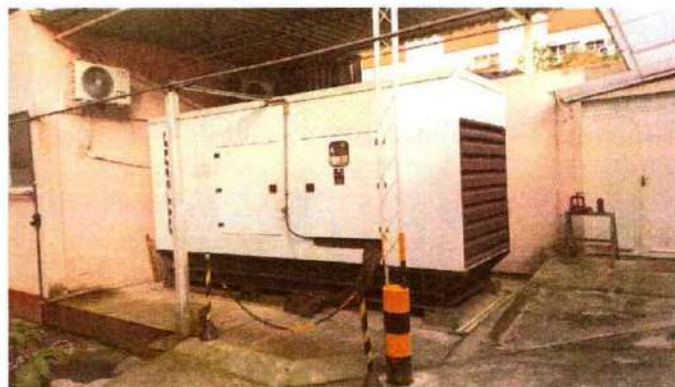
Geradores de energia a diesel cabinado, em não conformidade com o Aditamento Administrativo de Serviços Técnicos nº 001/2015 - Nota DGST nº 006/2015.
