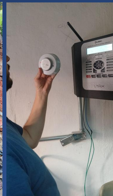
Figura 14 - Central de alarme e detector wireless
