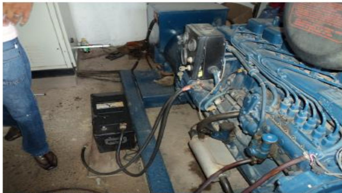
Gerador desligado da função automática, bateria desligada.
