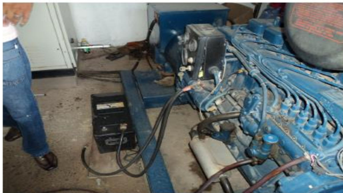
Gerador desligado da função automática, bateria desligada.
