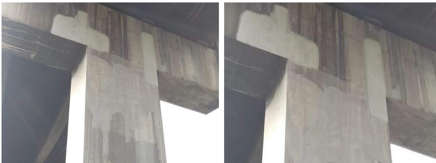
Recuperação de concreto desagregado com ferragem exposta.
