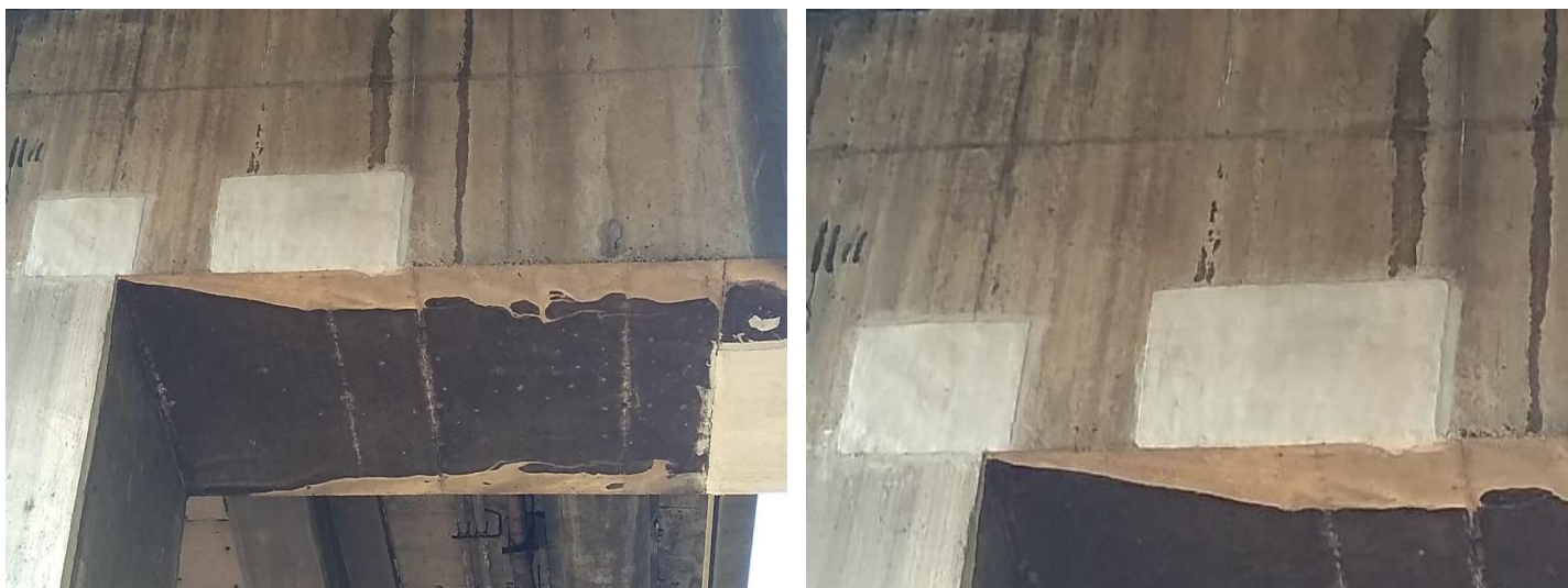
Recuperação de concreto desagregado com ferragem exposta.
