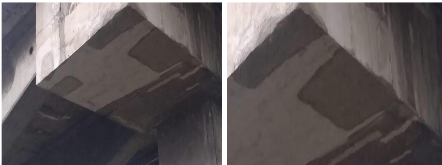
Recuperação de concreto desagregado com ferragem exposta.
