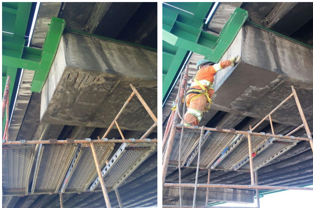
Recuperação de concreto desagregado com ferragem exposta.
