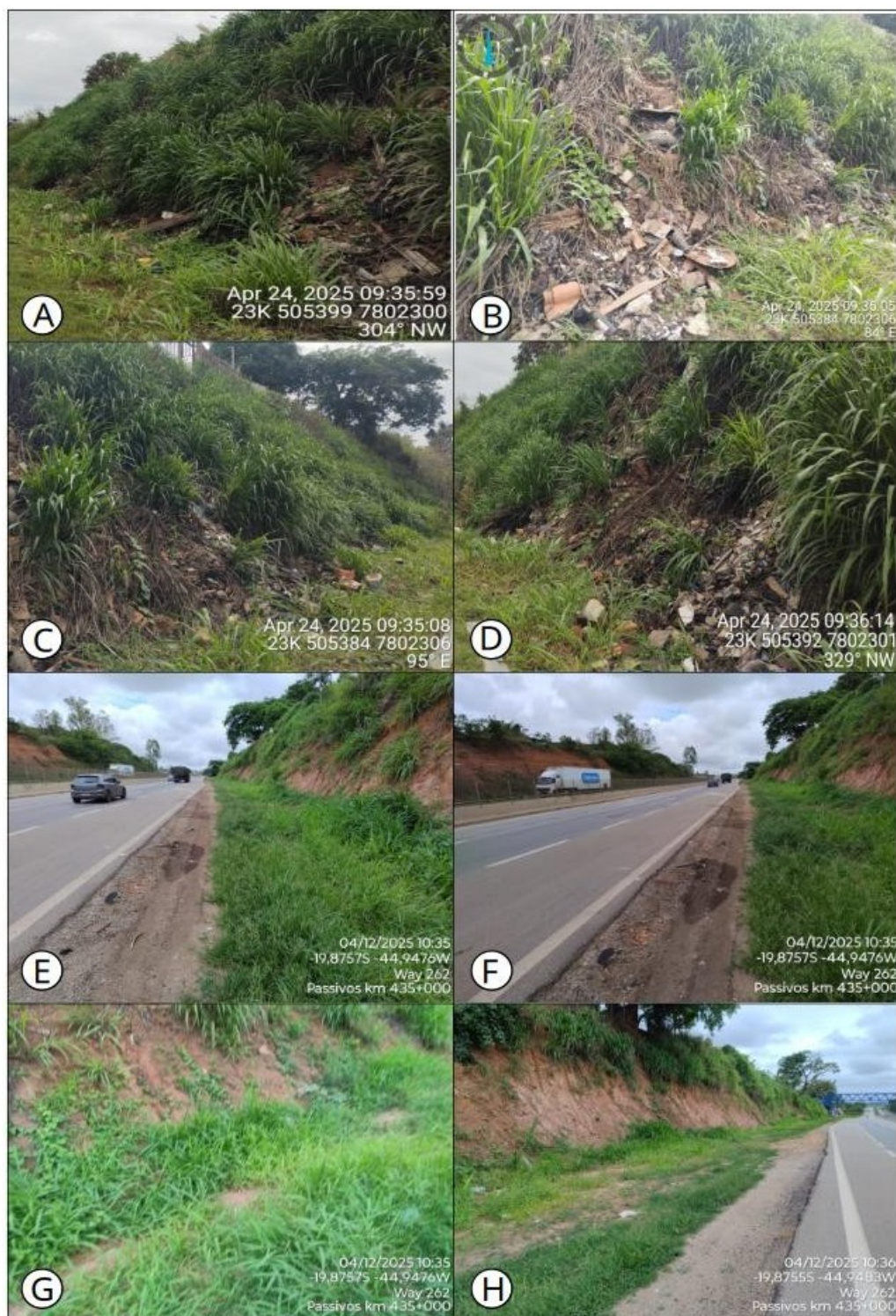
Figura 44- A) Cadastro inicial do passivo com 435+000 contendo resíduos de diferentes categorias, podendo oferecer risco a rodovia em caso de chuvas. B) Detalhe para os resíduos encontrados no local. C) Vista geral para a área dos resíduos na faixa de domínio. D) Detalhes dos resíduos encontrados no local. E) Acompanhamento das intervenções no Passivo Ambiental do km 435+000 da BR-262/MG. F) Vista geral para a pista, evidenciando a limpeza da área. G) Detalhe para o local sem resíduos identificados no cadastro inicial. H) Vista Geral para a pista evidenciando a limpeza do local.
