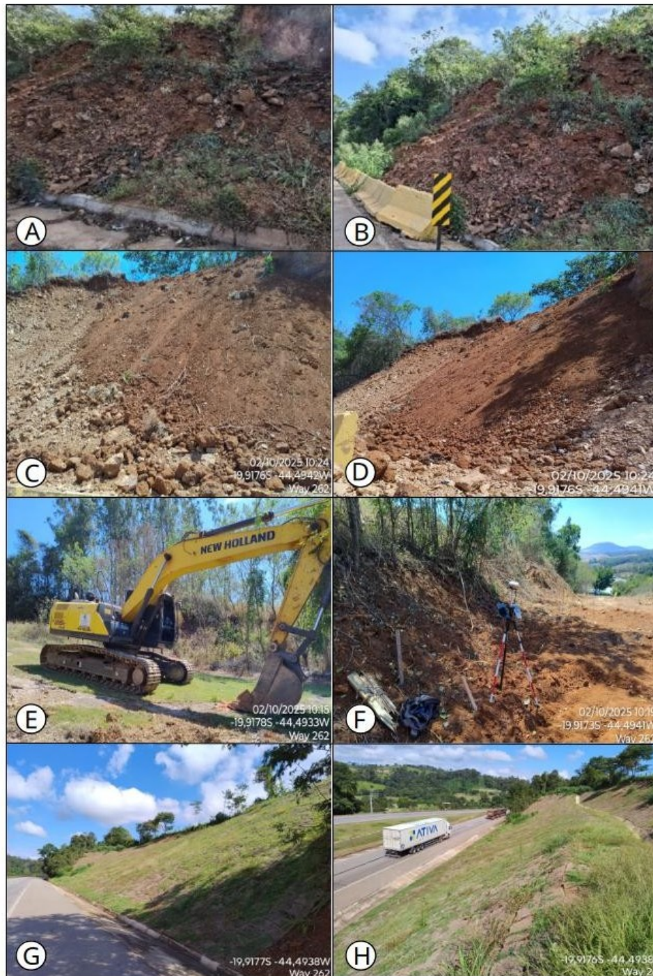
Figura 42- A) Cadastro inicial do passivo ambiental no Km 382+200 Pista Oeste. B) Vista lateral para o passivo cadastrado, evidenciando talude com processo erosivo com baixa densidade de cobertura vegetal. C) Intervenção na área de talude do ponto de passivo. D) Vista geral para a área do passivo, observando a estabilização da área. E) Acompanhamento das intervenções no Passivo Ambiental do km 382+200 da BR-262/MG. F) Acompanhamento das diretrizes técnicas utilizadas par acompanhamento do local. G) Vista lateral da pista Oeste no Km 382+200 com o talude estabilizado e recomposição vegetal estabelecida H) Vista geral para o sistema de drenagem alocado no talude.
