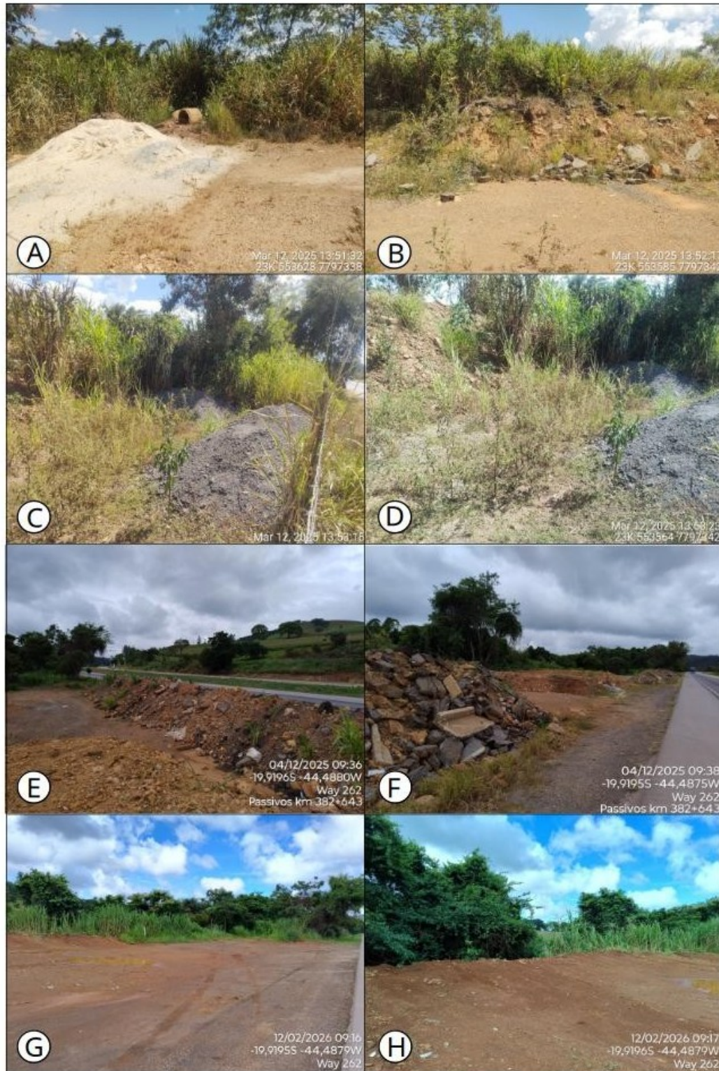
Figura 40- A) Cadastro inicial da área como passivo ambiental devido a resíduos encontrados em Área de Preservação Permanente, em ponto desativado. B) Detalhe para resquícios de resíduos advindos de obra civil. C) Materiais fresados localizados no local. D) Detalhe para os resíduos de fresa presentes no local. E) Acompanhamento das intervenções no Passivo Ambiental do km 382+643 da BR-262/MG. F) Vista geral para a pista com intervenção sendo realizada, limpeza da área. G) Ponto de passivo com limpeza da área realizada e área estabilizada. H) Área pronta para recomposição.
