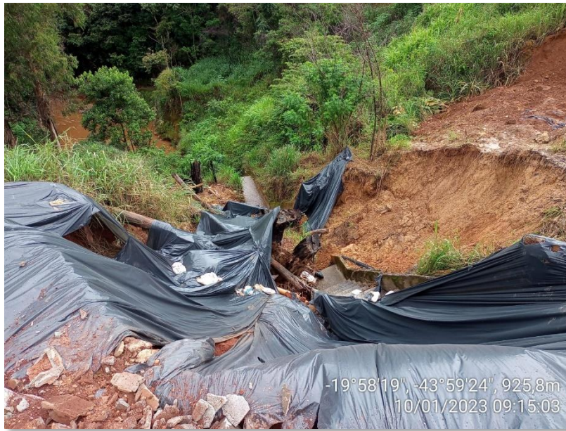
Figura 13: Processo erosivo na lateral da descida d'água a jusante da drenagem. Destaque para queda de árvore Km 538+700 Norte (antes – jan/23)
