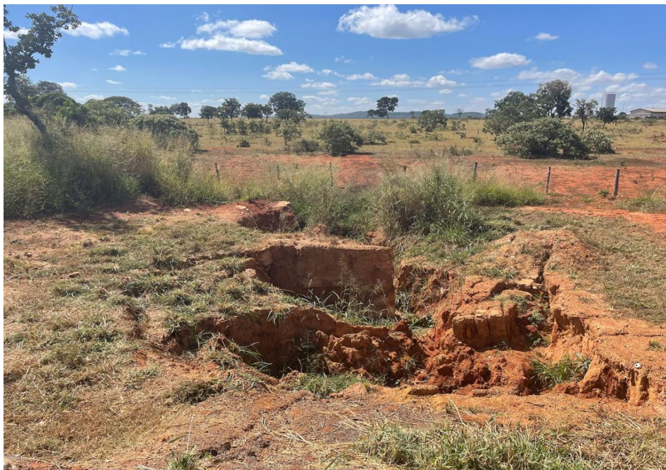
Figura 23: Vista do escorregamento de talude próximo a faixa de rolamento - Km 51+470 Norte (antes-jun/23)
