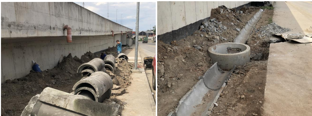
Figuras 3 e 4. Em um trecho com drenagem pvc externa, os tubos foram roubados, com obra de substituição por drenagem em concreto.
