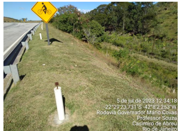
Figura 24 – Registro aproximado do talude de aterro da pista, evidenciando a presença dos marcos superficiais ao longo da crista do talude de aterro, instalados para o monitoramento do corpo de aterro da plataforma rodoviária. Fonte: Concremat Ambiental
