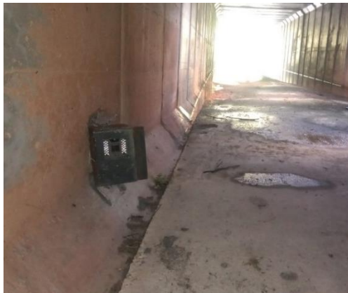
Figura 1: Registro evidenciando câmera de monitoramento instalada na Passagem de Fauna Terrestre Km 217+950, pista sul. Fonte: Concremat Ambiental.
