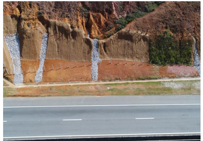
Figura 22: Registro aéreo obtido através de voo de drone evidenciado em plano geral, a conclusão das obras de recuperação de sinistro em talude de encontro localizado no km 198+000, pista sul da Rodovia BR 101/RJ. Fonte: Concremat Ambiental.
