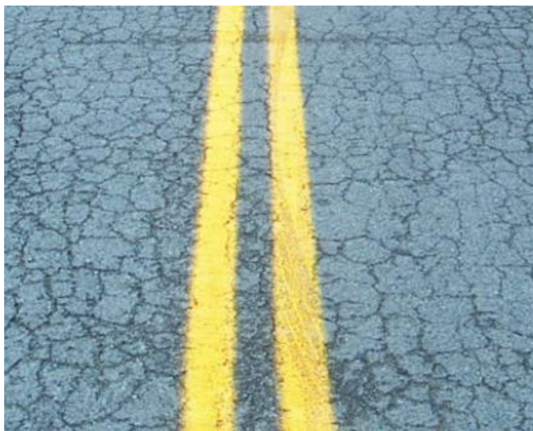
Figura 3.6: Trincamento por fadiga em camadas asfálticas. FONTE:
