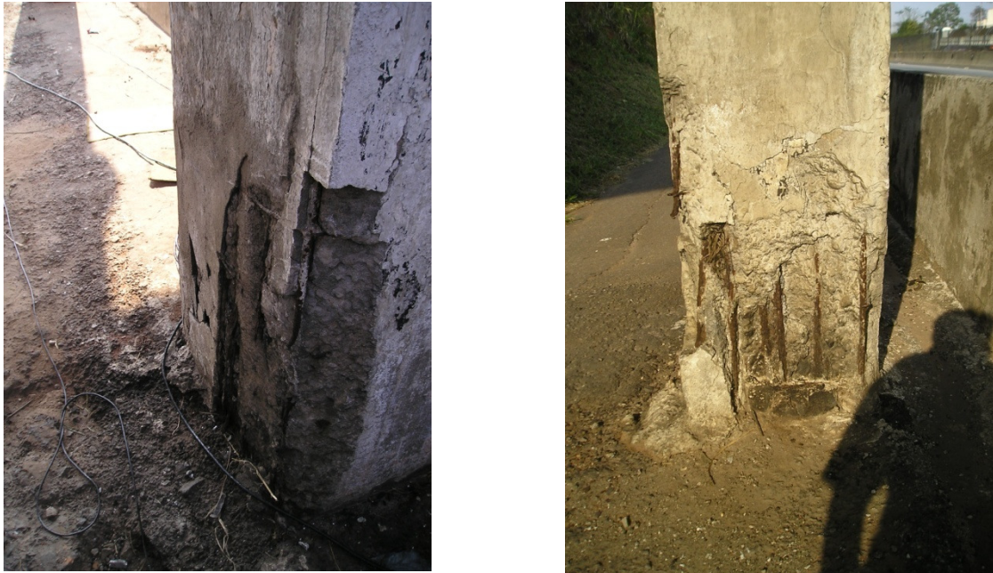
Figura 3.9 - Pilar com armadura corroída devido vandalismo de transeuntes
