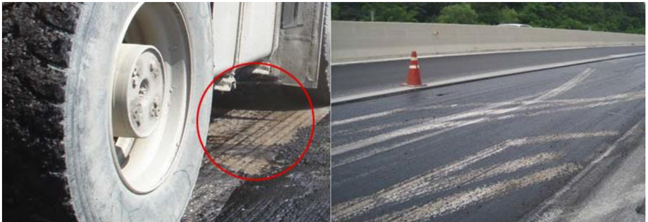
Figura 3.5: Remoção da pintura de ligação pelos pneus dos caminhões. FONTE: http://esg.kr/ver2_eng_04_technology/technology02.php
