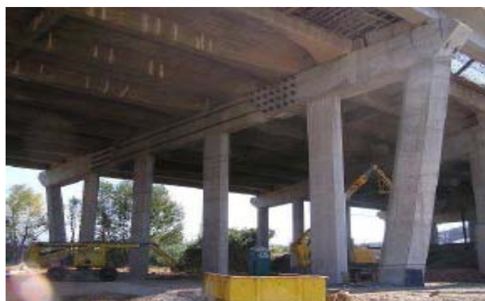
Figura 27: pilares inclinados e fundação adjacente à do pilar extremo existente
