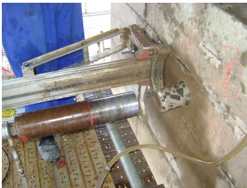
Figura 69: extração dos corpos-de-prova nos pilares de seção caixão
