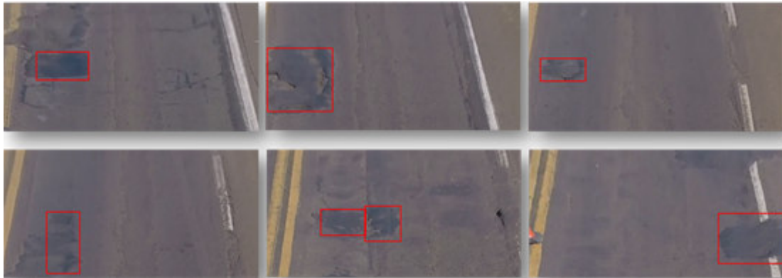
Figura 3 - Remendos no pavimento
