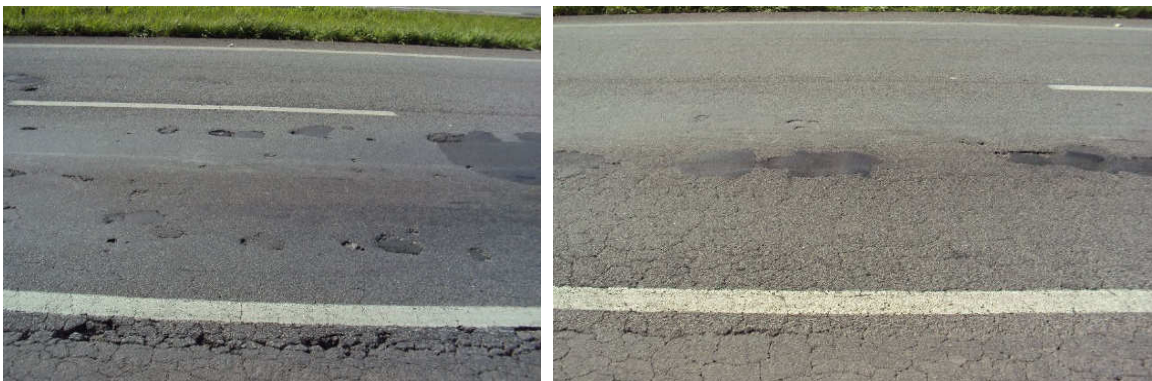
Figura 21 – Deterioração dos segmentos com cimento, mais próximos dos segmentos com cal
