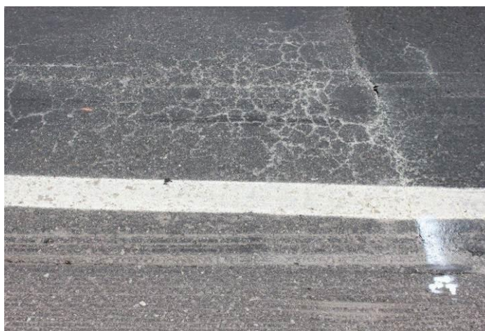
Figura 59. Divisa entre os segmentos I e II, com maior área de trincamentos no primeiro
