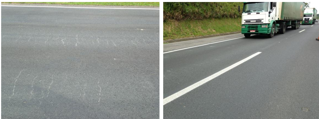
Figura 60. Segmento I (a) com maior área de trincamento do que o segmento IV (b)
