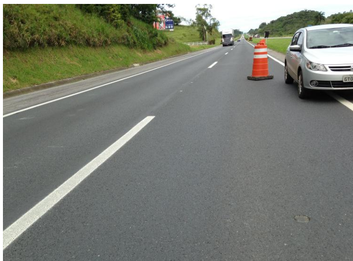
Figura 61. Faixa I à direita sem defeitos funcionais
