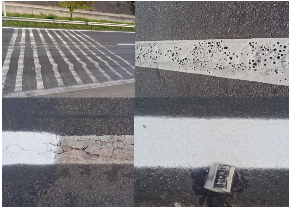
Figura 2 – Detalhamento de patologias em sinalização viária horizontal
