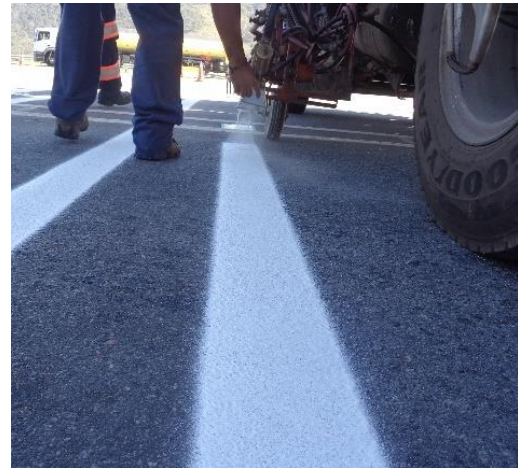
Figura 58 – Verificação de alinhamento entre pistolas - microesferas e tinta
