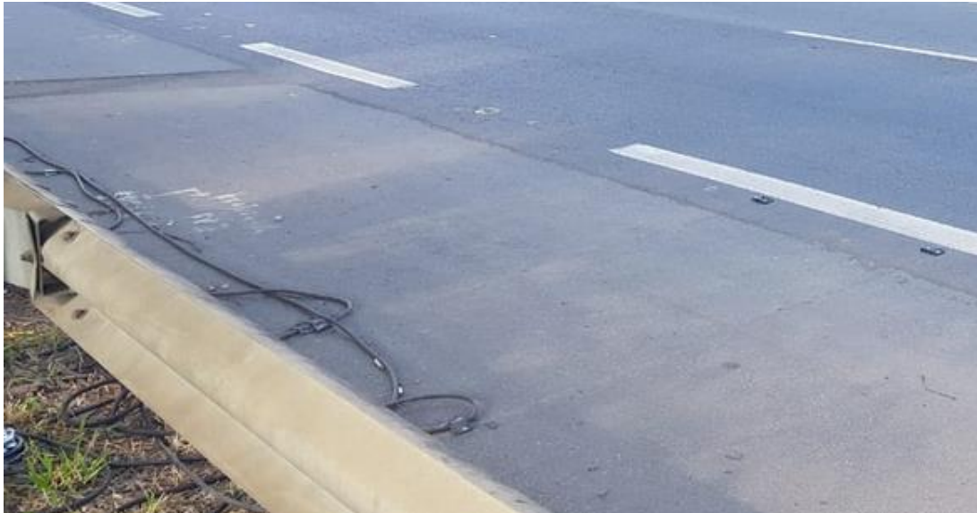
Figura 39 - Tubos dos sensores danificados
