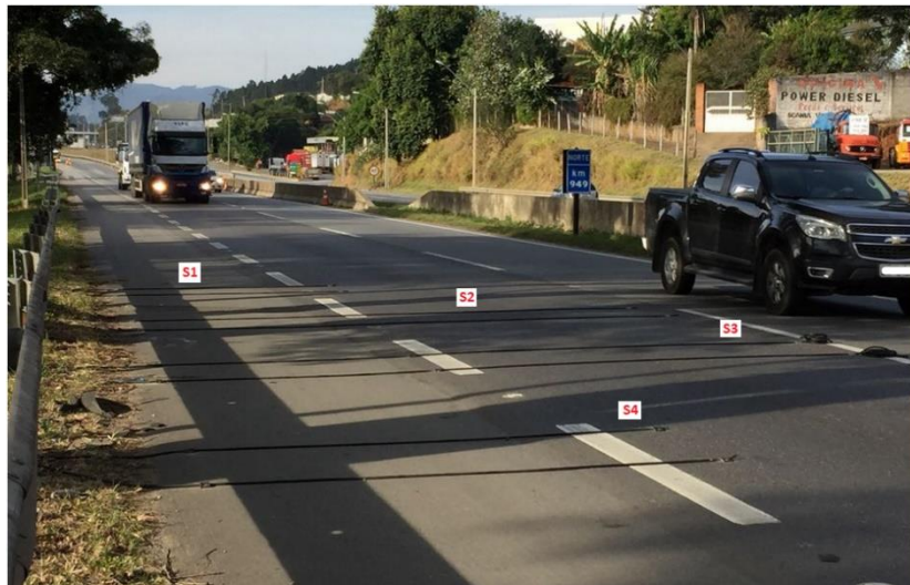
Figura 36 - Sensores instalados na via
