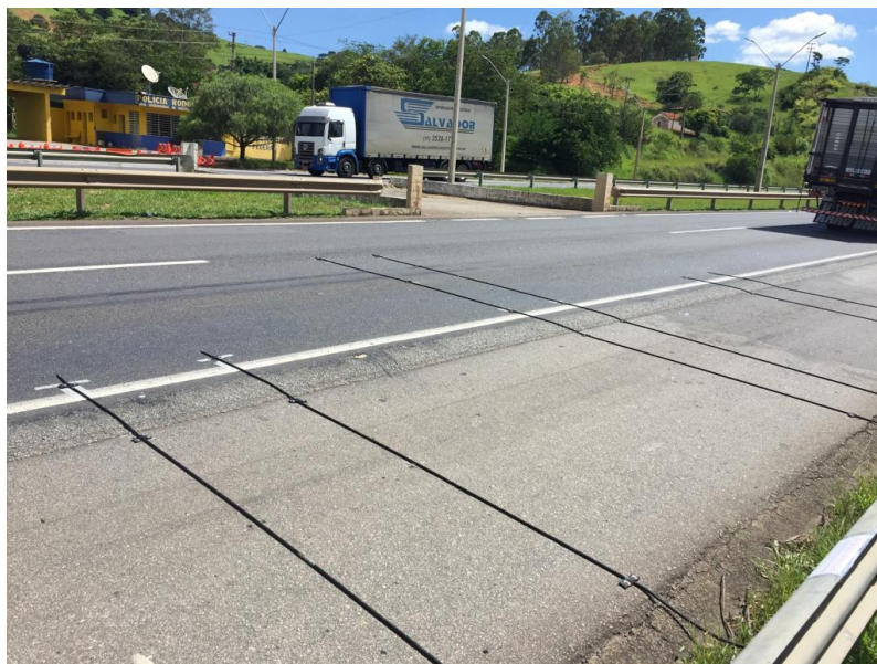
Figura 42 - Sensores instalados no pavimento
