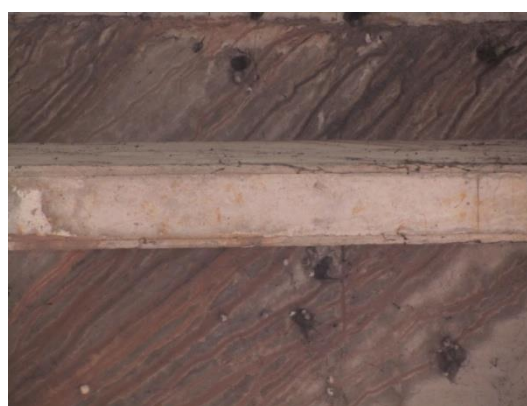
(d) Manchas de óxido de ferro
