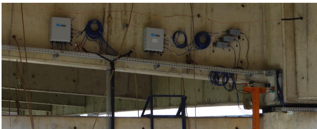
Figura D.52 – Multiplexadores instalados na viga transversa.
