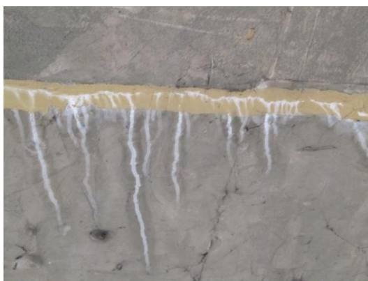
Figura A.7 – Lixiviação do concreto através das fissuras na laje.
