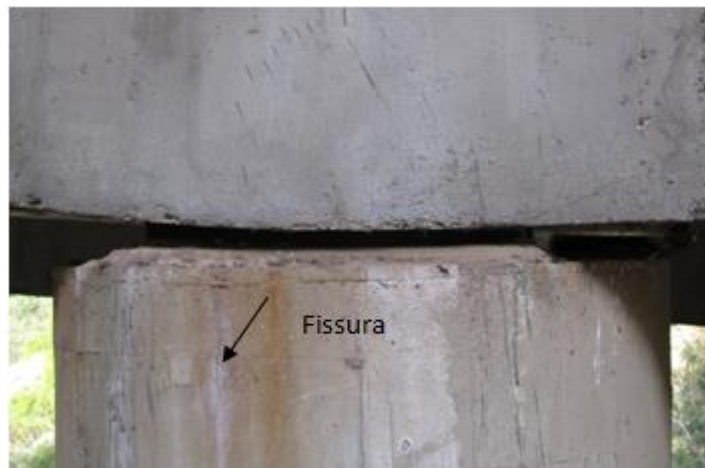
Figura A.5 – Fissura no pilar P3B.
