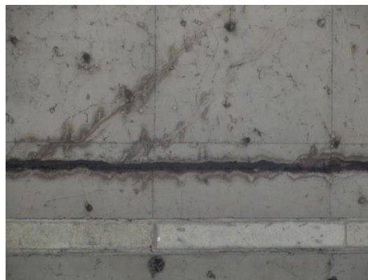
(b) Fissura da laje
