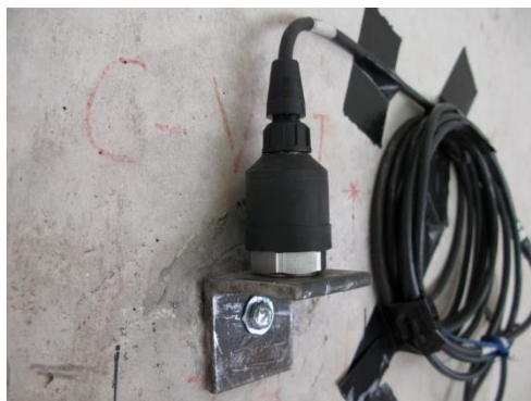
Figura B.11 – Detalhe do acelerômetro instalado no meio do vão entre os pilares P5 e P6.
