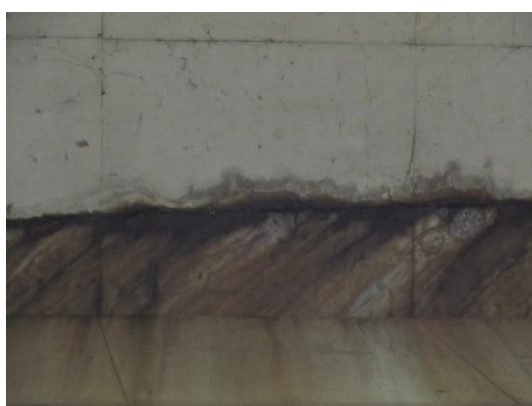
(c) Fissura na laje
