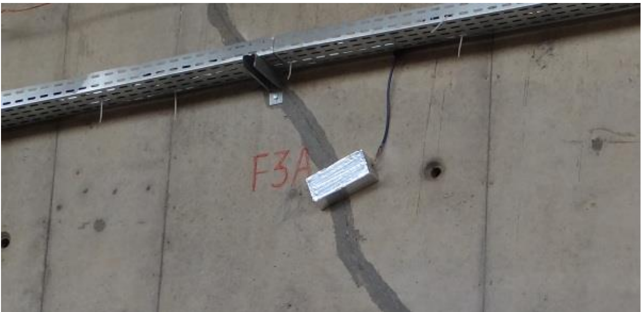
Figura D.56 – Caixa de proteção para sensor de abertura de fissuras.
