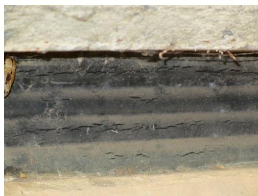
(c) Fissura no apoio
