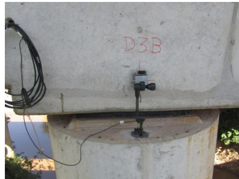
(b) Deslocamento vertical no apoio
