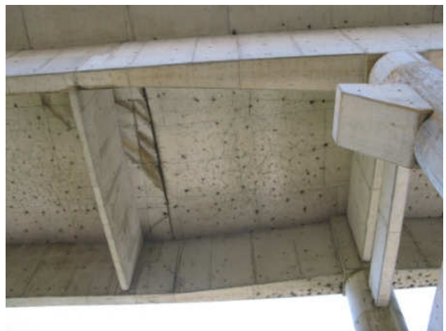
Figura 14 - Infiltração na laje no tramo entre as transversinas TR14 e TR13.
