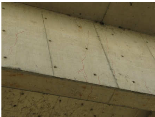
Figura 7 - Vista face inferior da longarina V1 (fissuras por retração e flexão), entre os pilares P5A e P4A.
