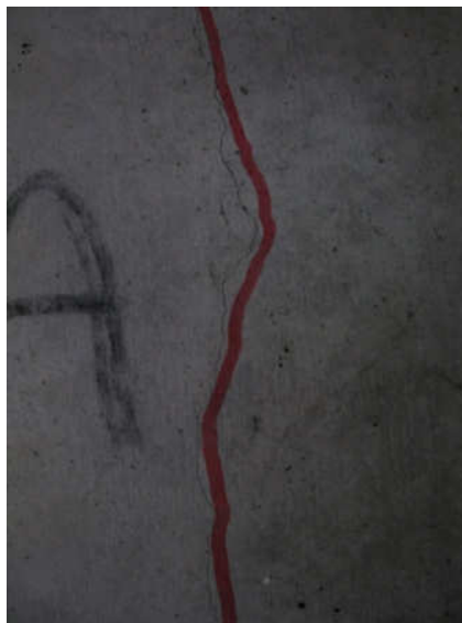
Figura 10 - Transversina TR20 (fissuras por retração), entre os pilares P6A e P6B.
