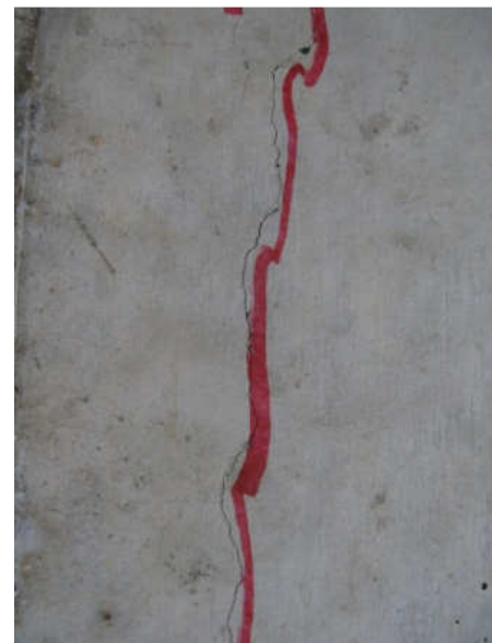
Figura 5 - Vista face interna da longarina V2 (fissuras por retração), entre os pilares P6B e P5B.
