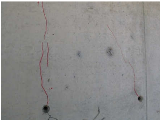
Figura 4 - Vista face externa da longarina V1 (fissuras por retração), entre os pilares P6A e P5A.
