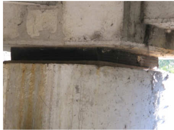
Figura 3 - Aparelho de apoio referente ao pilar P4B.
