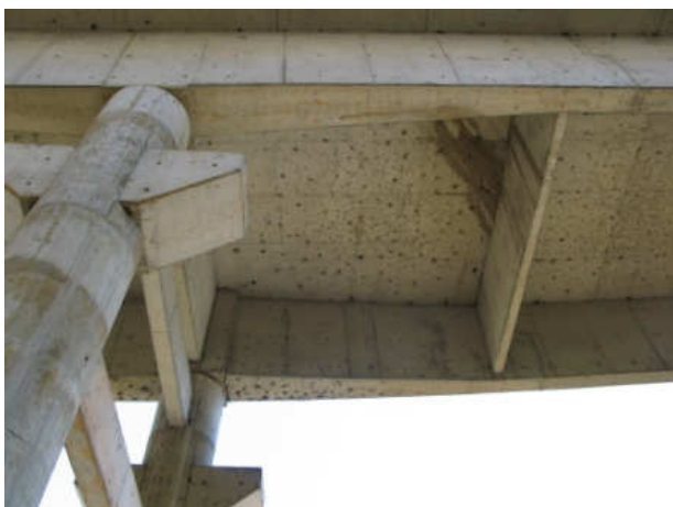
Figura 15 – Infiltração na laje próximo aos pilares P4A e P4B e a transversina TR12 (direita).
