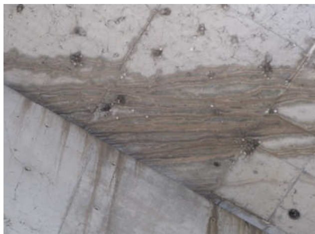
Figura 16 - Destaque à infiltração na laje com Tr12 abaixo.
