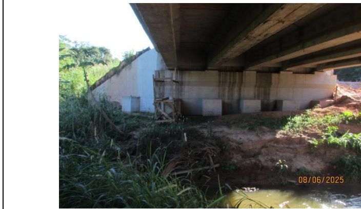
FOTO 05: Vista geral do encontro 02 (Sul). Nota-se mancha de umidade na viga travessa.
