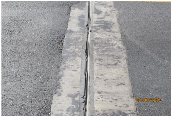
FOTO 09: Junta de dilatação 02, com deterioração no lábio polimérico e no perfil elastomérico (detalhe da foto 08).
