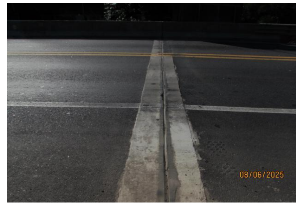
FOTO 06: Junta de dilatação 01, com deterioração no lábio polimérico e no perfil elastomérico.
