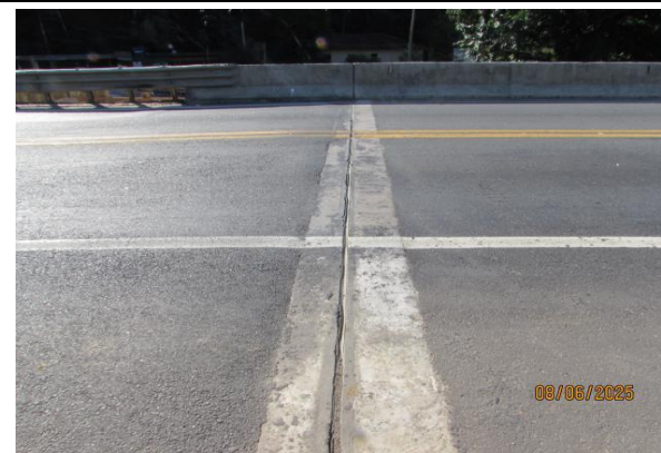
FOTO 08: Junta de dilatação 02, com deterioração no lábio polimérico e no perfil elastomérico.
