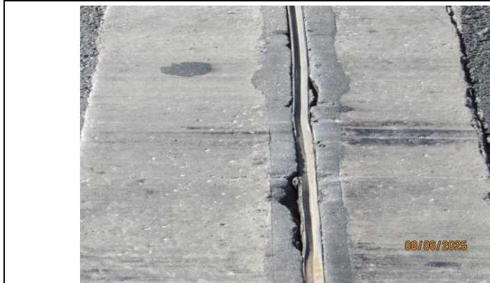
FOTO 07: Junta de dilatação 01, com deterioração no lábio polimérico e no perfil elastomérico (detalhe da foto 06).
