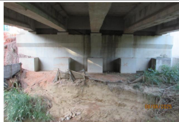
FOTO 04: Vista geral do encontro 01 (Norte). Nota-se mancha de umidade na viga travessa.
