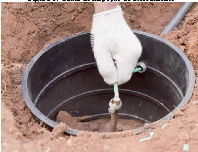
Figura 5: Caixa de inspeção de aterramento
