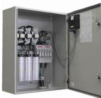
Figura 22: Banco de capacitores de parede
