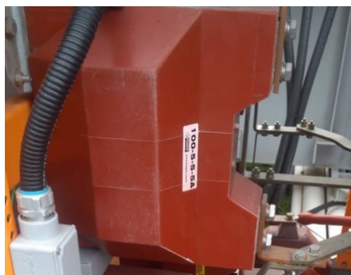
Figura 15: Transformador de Potencial em cubículo
