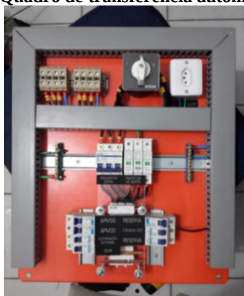
Figura 32: Quadro de transferência automática aberto
