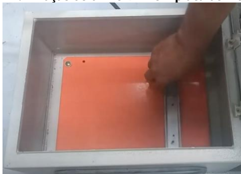
Figura 27: Fixação do trilho DIN em placa de montagem
