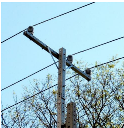
Figura 109: Estrutura com isolador pino
