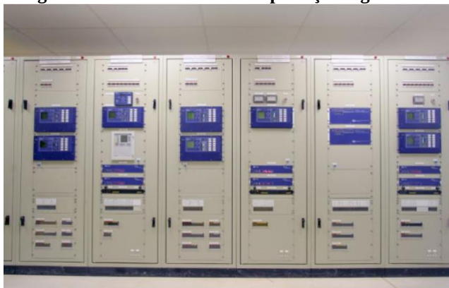
Figura 2: Painel de comando e proteção digitalizado
