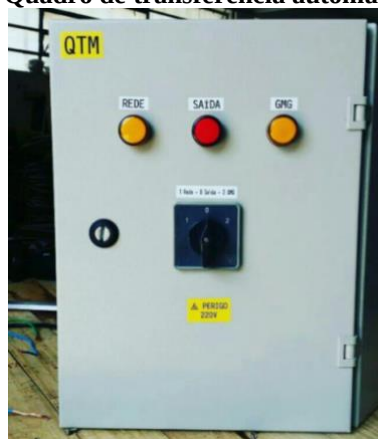
Figura 33: Quadro de transferência automática fechado
