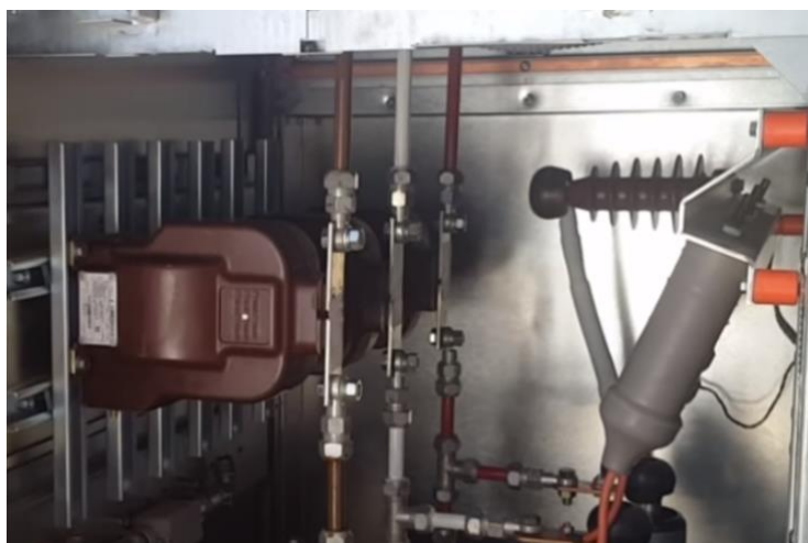
Figura 14: Transformador de corrente interno a cubículo
