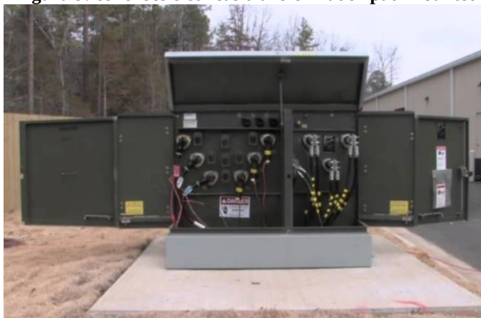
Figura 9: conexões elétricas transformador pad-mounted
