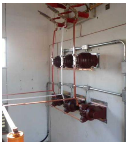
Figura 16: TCs e TPs instalados em cela
