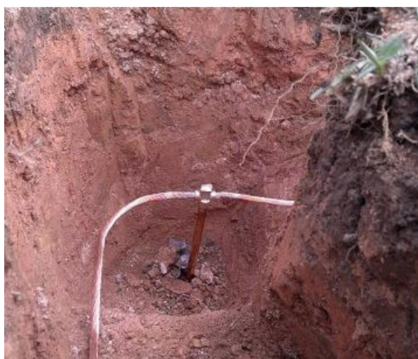
Figura 87: Haste de aterramento
