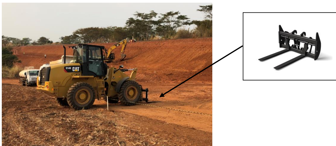
Figura 37: Carregadeira de pneus com uso de implemento de garfo para o transporte de paletes e cargas diversas em canteiro de obra ferroviária
