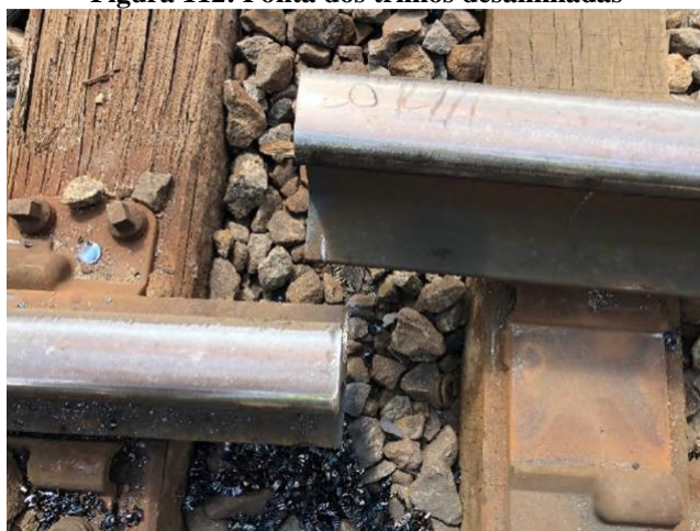
Figura 112: Ponta dos trilhos desalinhadas
