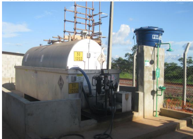
Figura 11: Módulo de abastecimento instalado em base de concreto armado
