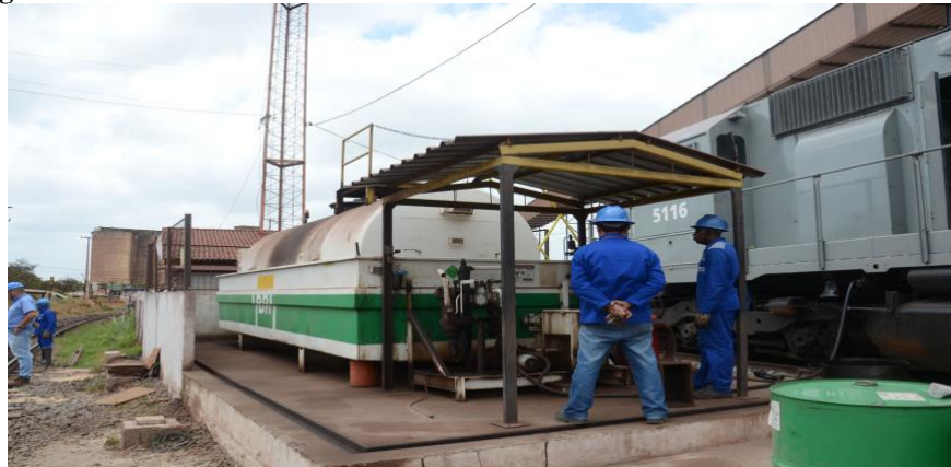
Figura 10: Módulo de abastecimento instalado em base de concreto armado
