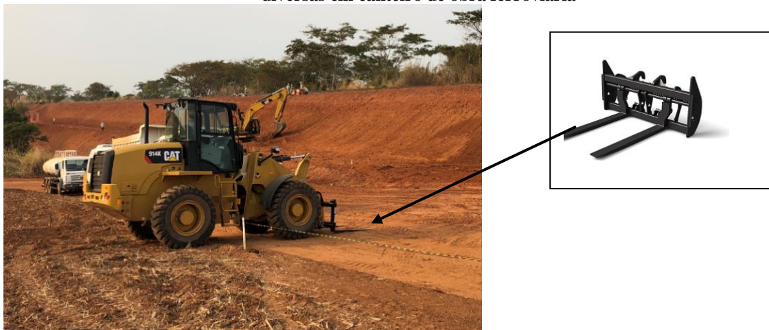
Figura 54: Carregadeira de pneus com uso de implemento de garfo para o transporte de paletes e cargas diversas em canteiro de obra ferroviária
