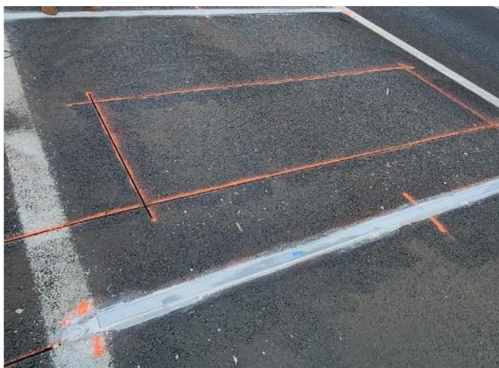
Figura 2 - Sensores instalados na BR 365 km 640 Uberlândia/MG.
