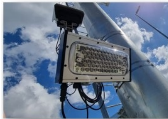
Figura 6: Iluminador Infravermelho - auxilia em períodos noturnos na leitura das placas
