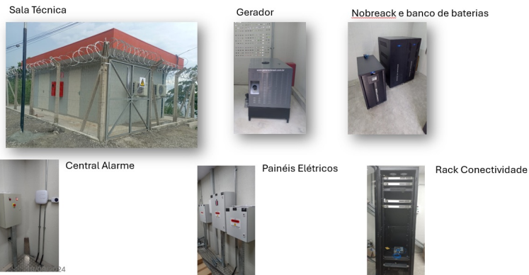
Figura 3: Sala Técnica de Monitoramento e Equipamentos que a compõe
